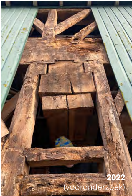
vangrecht B.27 Spoorstijl aan vervanging toe.
