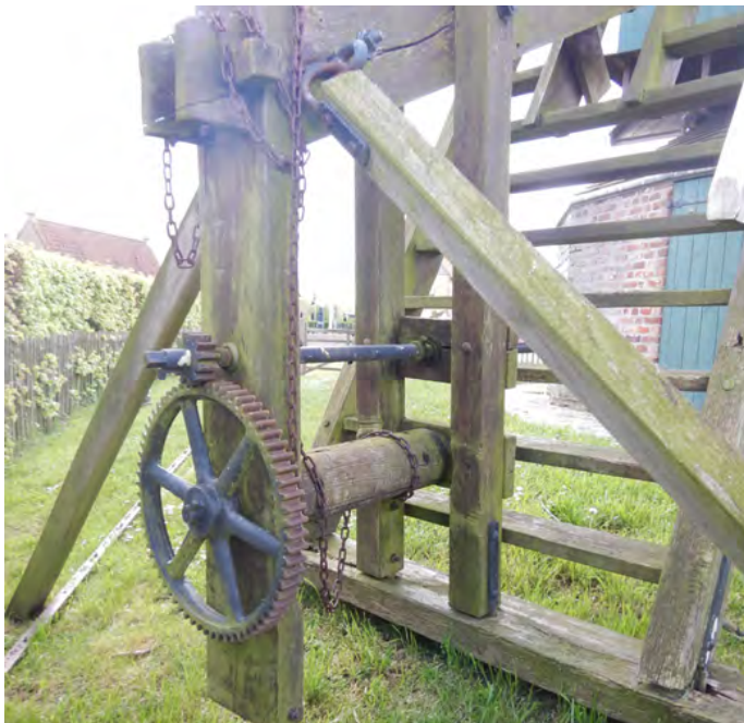
Het kruilier met houten as is roestig, maar lijkt verder in relatief goede staat. De kruiketting is aan vernieuwing toe.
