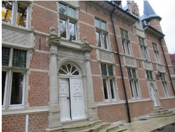
Figuur 19: De deuren die vervangen dienen te worden
