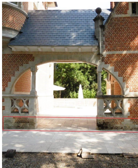
Vochtoverlast onderaan vleugel [16]-zuid door het ontbreken van een hanggoot of lage begroeiing
