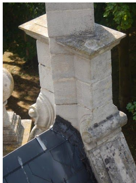
Vleugel [13]: plaatselijk weggevallen/uitgespoeld voegwerk
