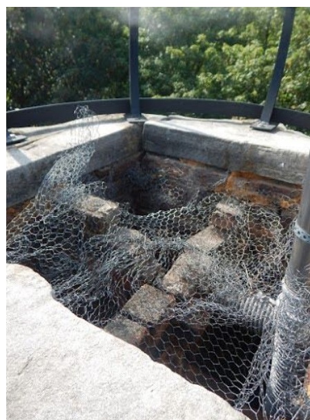
Schoorsteen [5]-zuidoost: niet-duurzame afscherming van het schoorsteen- kanaal met fijne, beschadigde gaasdraad
