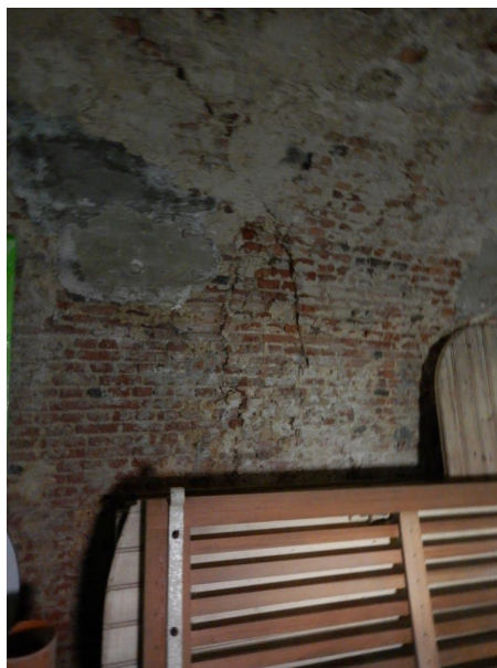
Noordwestelijke kelder: scheurvorming gewelf
