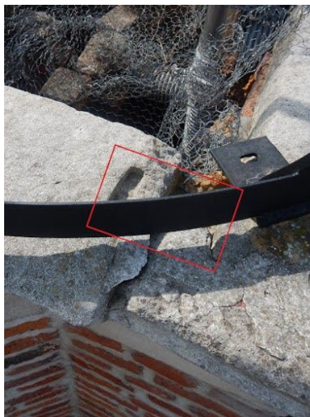
[5]-zuidoost: ontbrekende kram tussen de dekstenen
