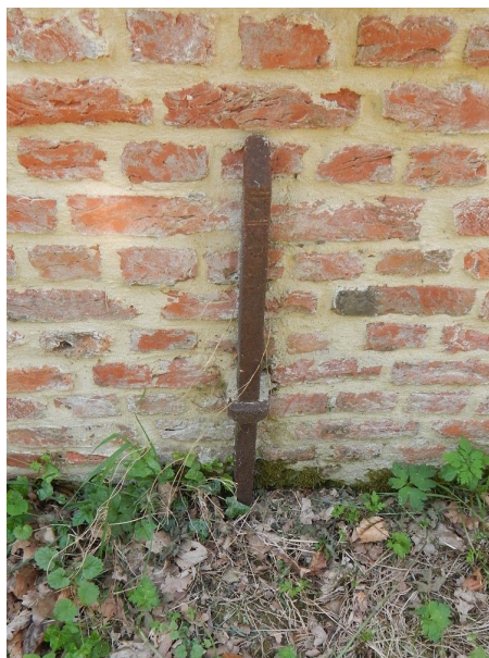
[19]-noord: roestig muuranker
