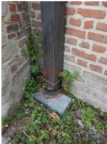
Dak [7]-noordwest: vuilophoping onderaan de afvoer (door MoWa gekuist)
