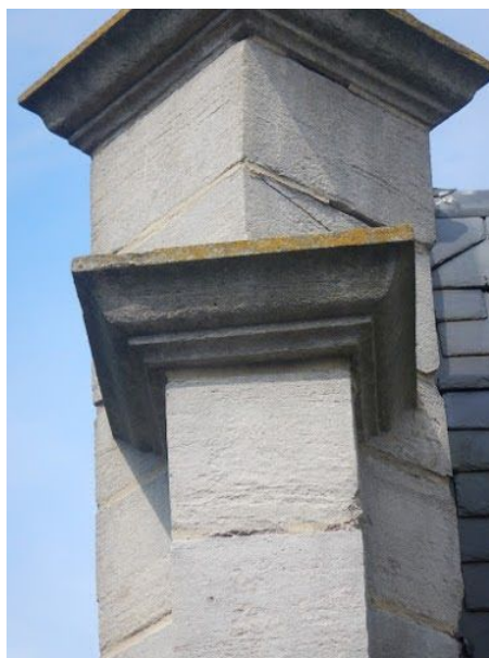
Vleugel [12]: het voegwerk valt plaatselijk weg
