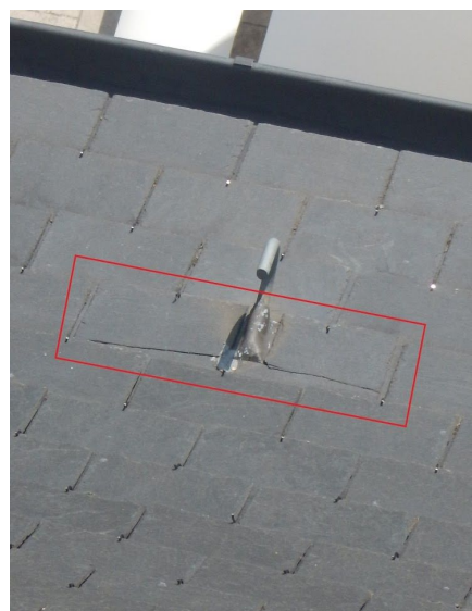
Dak [9]-noordoost: gebroken leien
