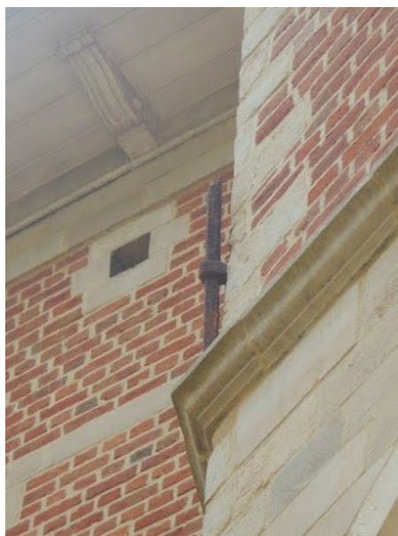
Toren [2]: de schieter van het muuranker drukt niet tegen de gevel. Het anker vervult niet langer zijn verstevigende functie
