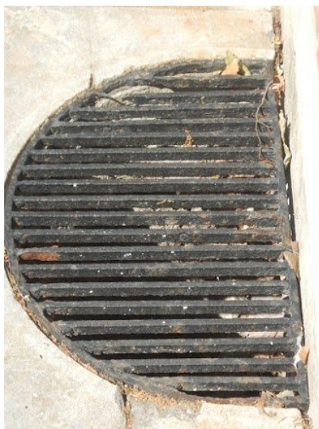
Vleugel [6]-zuid: roestig rooster keldergat
