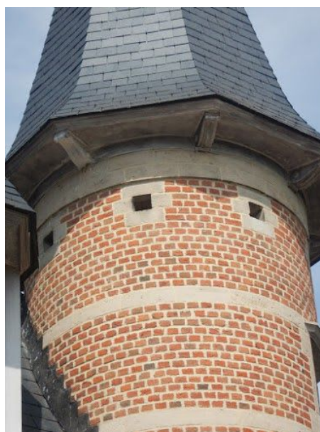
Toren [3]: niet-afgedichte stellinggaten
