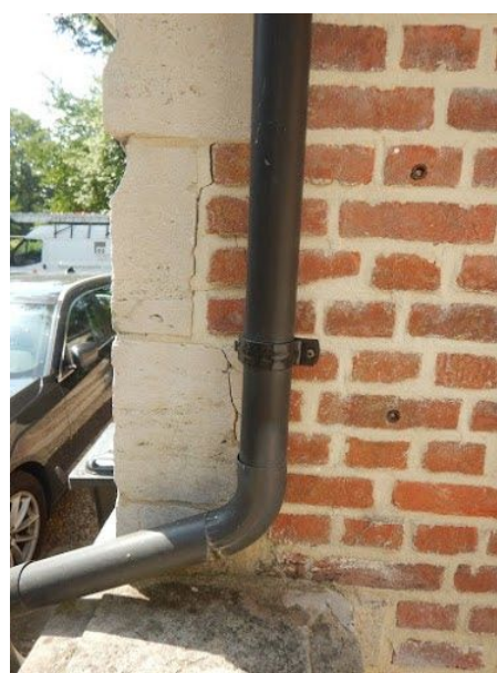
[16]-noordoost: scheurvorming op de hoek
