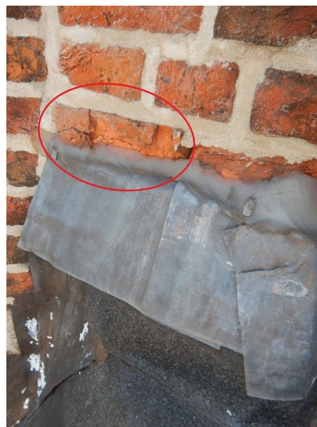
[5]-noordwest: beschadigde baksteen
