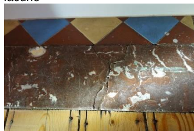
gebroken en losliggende boordsteen
