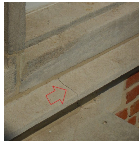
Vleugel [9]: gescheurde waterlijst
