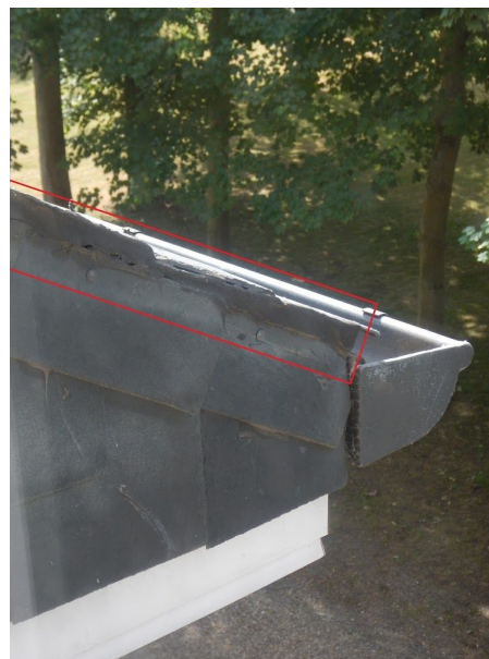
Dak [6] (ter hoogte van dakkapel [13]): blote vernageling en onoordeelkundige aan- werking met kit
