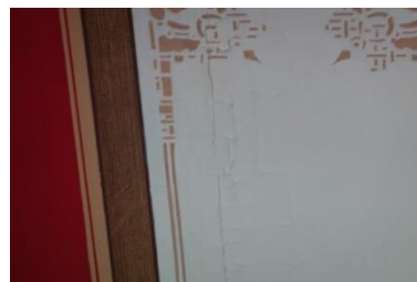
mobiele opstuwingen in zone voor schouw
