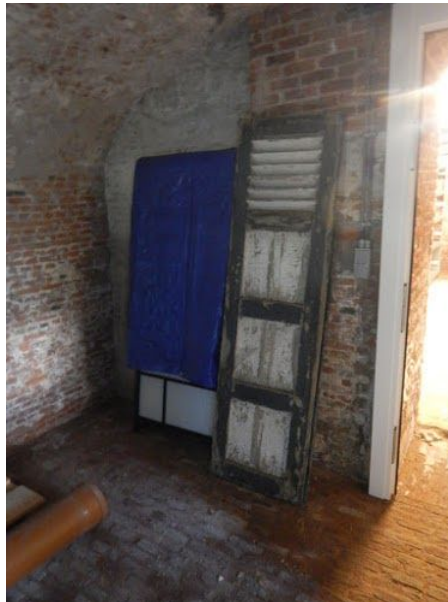
Noordwestelijke kelder: houten slagluiken in direct contact met de vochtige vloer
