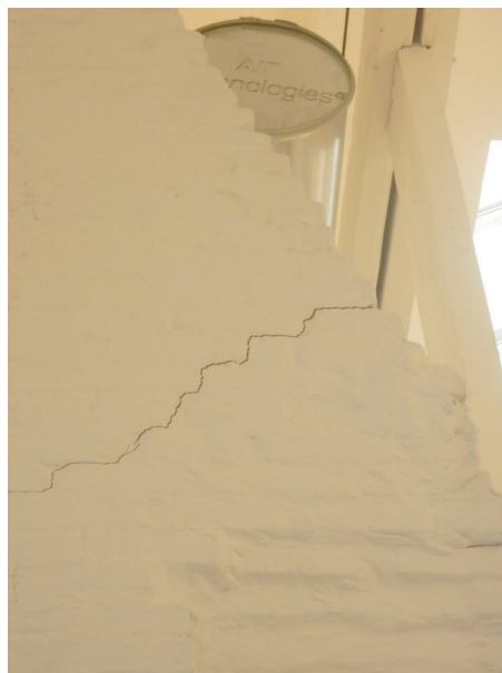
[5]-noordoost: scheurvorming (detail noordkant)
