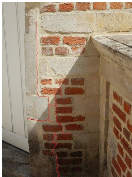
Toren [18]: scheurvorming naast de deur
