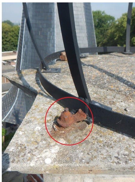
[5]-noordwest: roestige bevestiging van de oude bekroning
