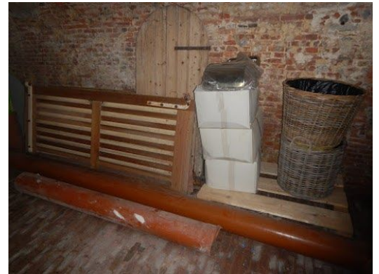
Noordwestelijke kelder: houten paletten en schrijnwerk in direct contact met de vochtige vloer
