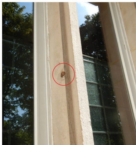
De roestige grendelogen (van de slagluiken) in de monelen kunnen scheurvorming veroorzaken
