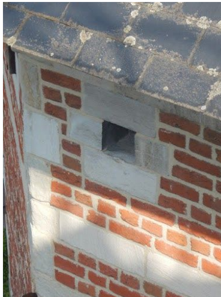
Toren [2]: niet-afgedicht stellinggat
