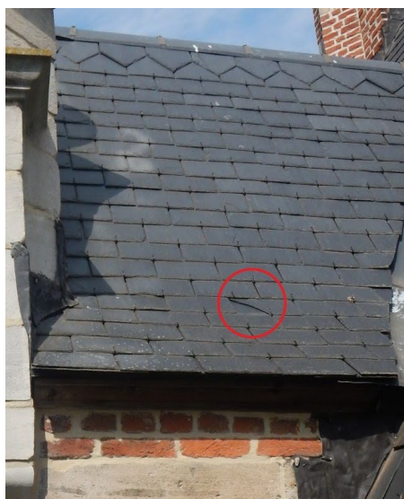
Dak [13]-oost: beschadigde lei
