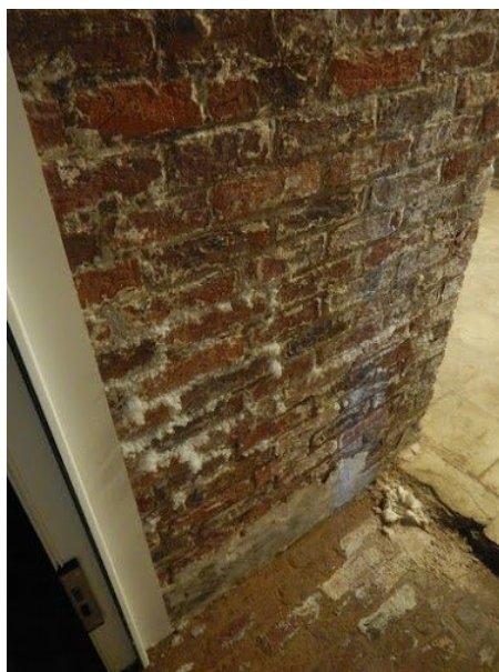
Noordwestelijke kelder: zoutuitbloeiingen
