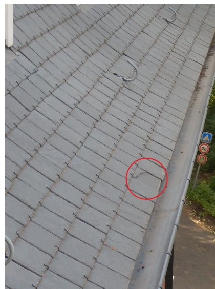
Dak [7]: beschadigde lei, hersteld met koper of zink
