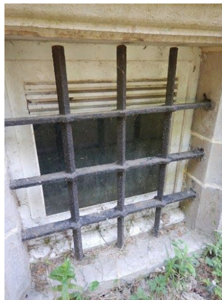
Vleugel [8]: roestig diefijzer kelder
