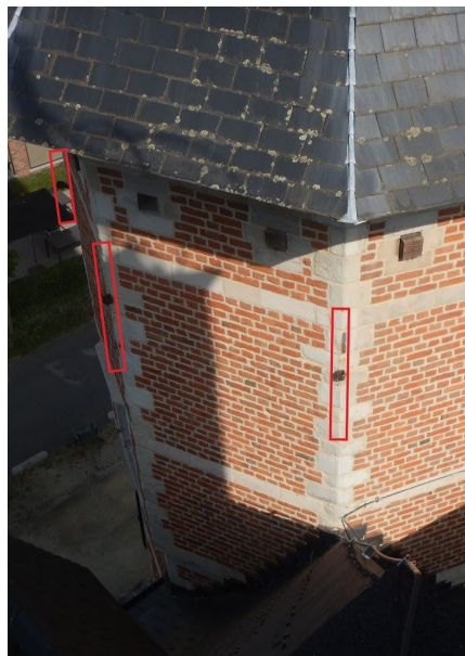
Toren [2]: 3 ontbrekende schieters van de muurankers
