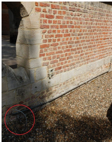
Vleugel [16]-zuidoost: niet-aangesloten leiding
