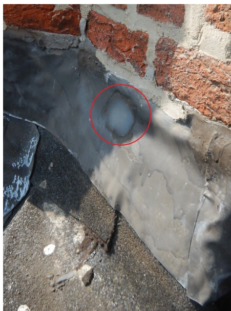
Dak [5]-zuidoost: onoordeelkundige herstelling met kit van de loodaansluiting met de schoorsteen
