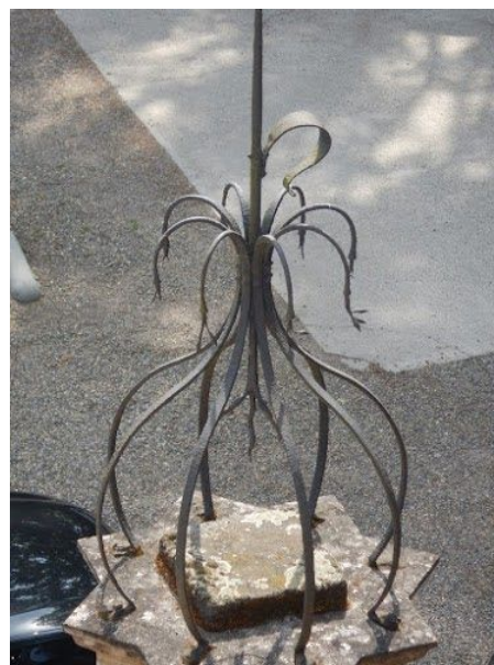
Bekroning schoorsteen dak [16]: ontbrekende onderdelen
