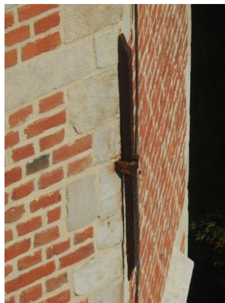
Toren [2]: roestig muuranker
