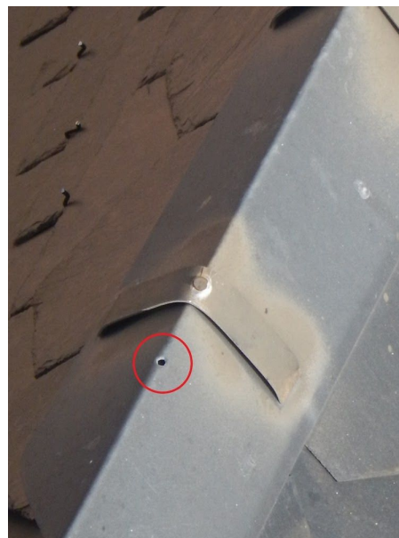
Dak [8] - westelijke dakkapel: geperforeerde zinken nok
