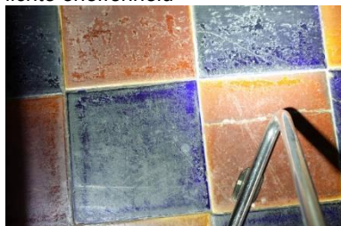
matte en afgesletten glazuurlaag
