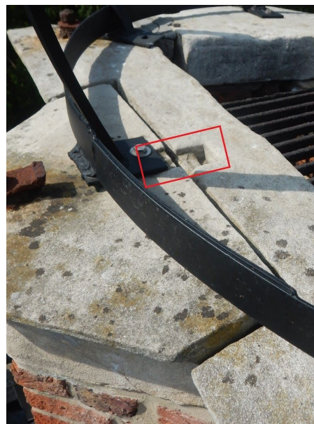
[5]-zuidwest: ontbrekende kram tussen de dekstenen
