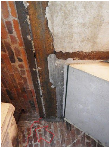
Scheurvorming aan een van de oplegpunten
