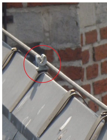
Dak [10]: de daalleiding zit niet (meer) in de bevestiging
