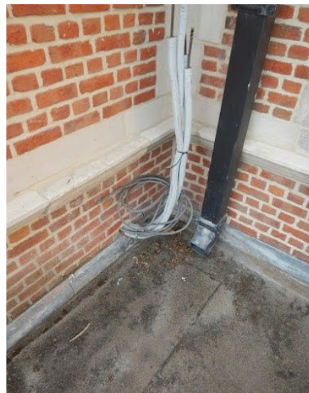
Vleugel [14]-noord: niet-aangesloten leiding
