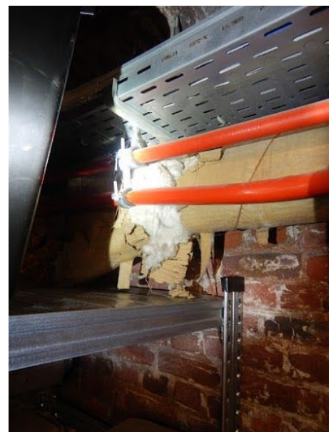
Eventueel asbesthoudende isolatie rond de leidingen in de kelder
