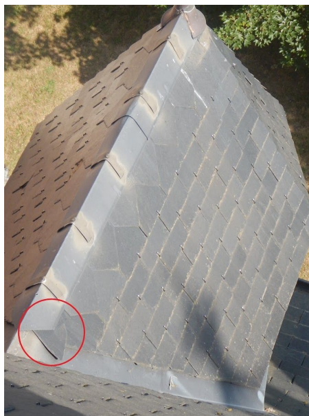
Dak [8] - westelijke dakkapel: scheefgezakte lei
