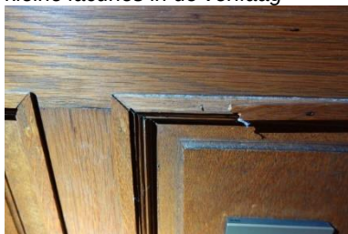
afgebroken en loskomend latje
