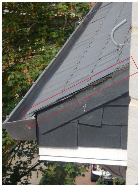
Dak [6] (ter hoogte van dakkapel [12]): blote vernageling en onoordeelkundige aan- werking met kit
