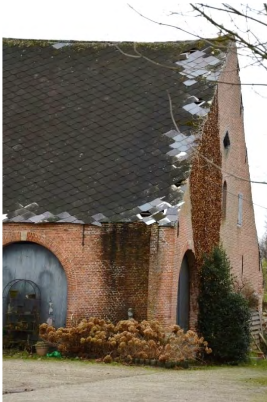
Fig. 242 - Detail van de lekke dakbedekking van de schuur en de waterschade en mosgroei op de gevels.
