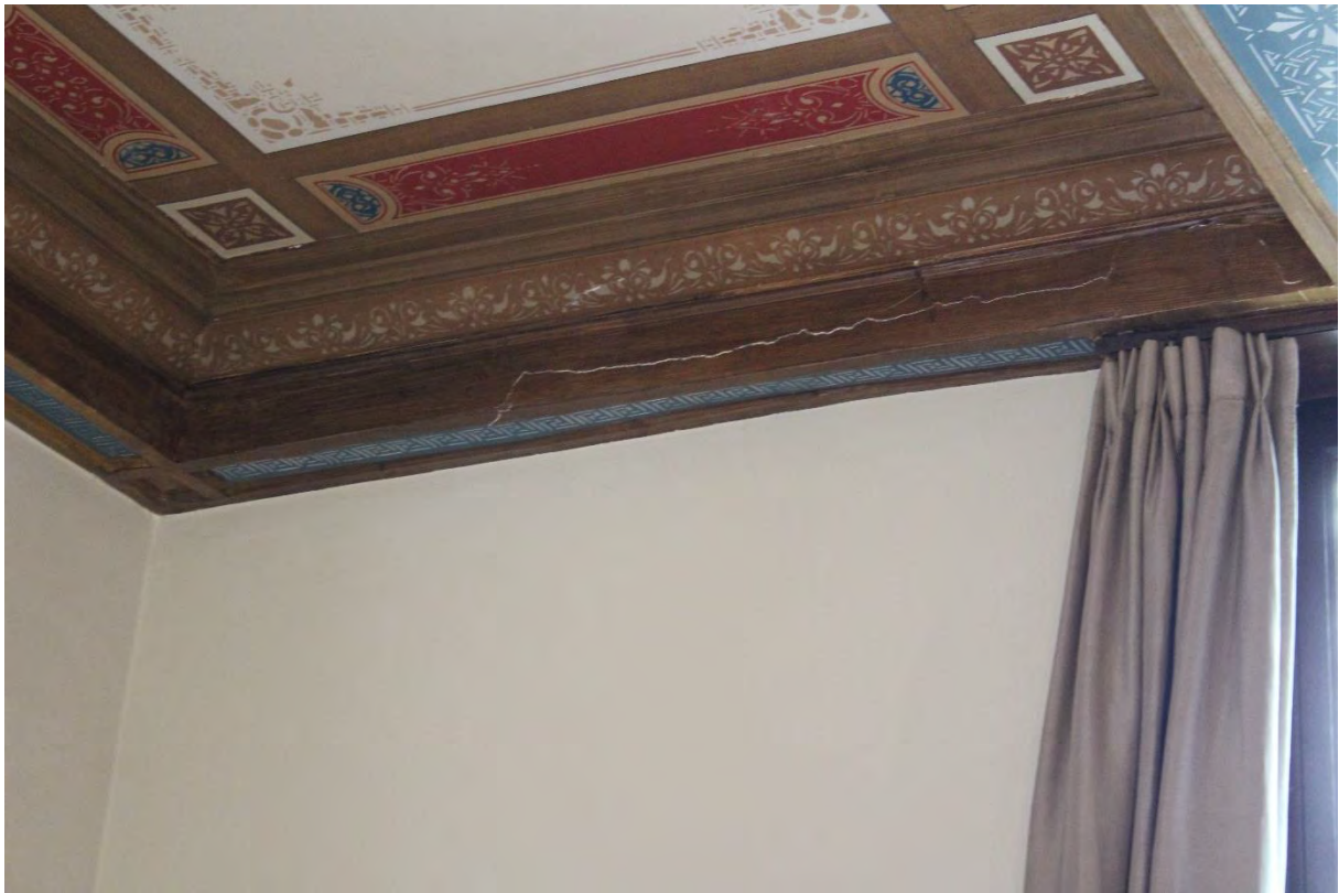
Fig. 130 - Een barst in het plafond van lokaal 009.
