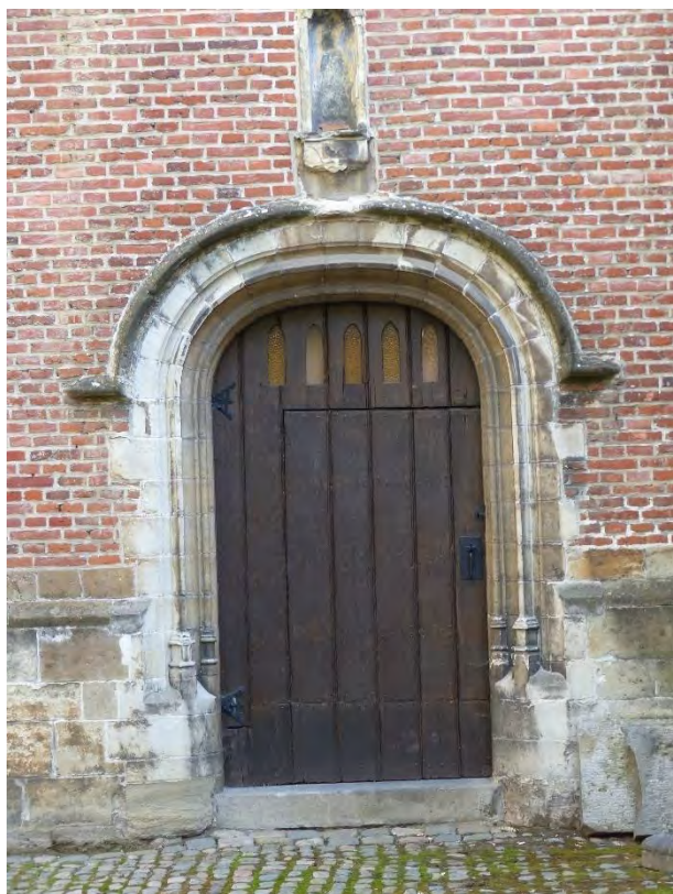
Figuur 92 (links) kapel, W: Plint en deurlijst in kalkzandsteen (AS, 17.10.2023)
