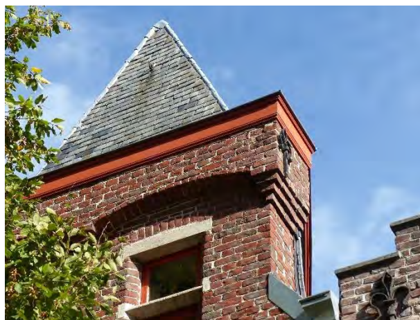
Figuur 679 neogotische vleugel noord, W: Gecorrodeerd oog (AS, 17.10.2023)
