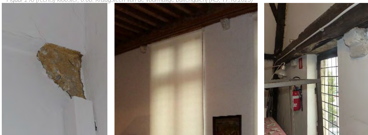
Figuur 299 (links) klooster, 1.07: Sterk verweerde en gebarsten kraagsteen ter hoogte van later ingevoegde wand (AS, 17.10.2023)
