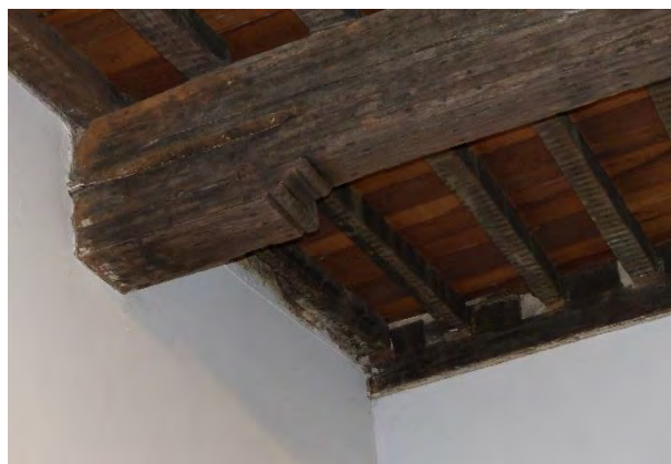
Figuur 313 (rechts) klooster, 0.04: De moerbalk vertoont aan de bovenzijde vochtschade. Georroedeerde beugel. Op de kinderbalken zijn de bevestigingen van verwijderde rinkellatten zichtbaar (AS, 17.10.2023)
