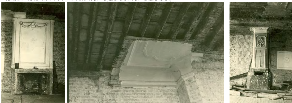
Figuur 66 (links), Figuur 67 (midden) en Figuur 68 (rechts) Details restauratiewerken interieur (S.N., Restauratie – Oud-Hospitaal – Oude Vismarkt – Aalst, 1959-1964, © SAA: nr. Oud-Hospitaal.047, Oud-Hospitaal.044, Oud-Hospitaal.048.)
