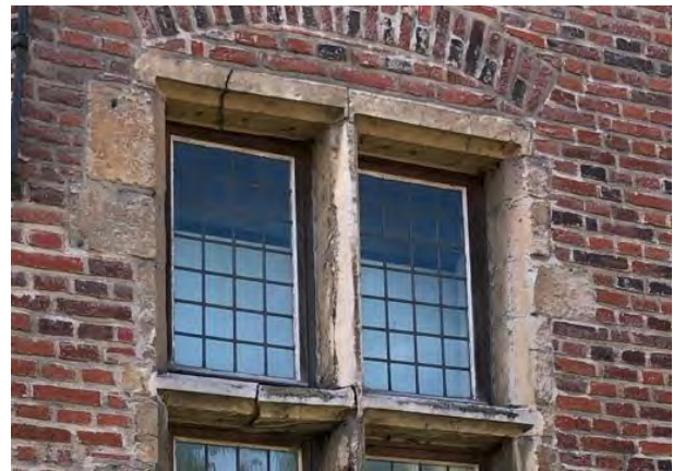
Figuur 169 (rechts) Klooster, noordvleugel, O: Linteeel en kruismoneel gebarsten en verzakt (AS, 17.10.2023)
