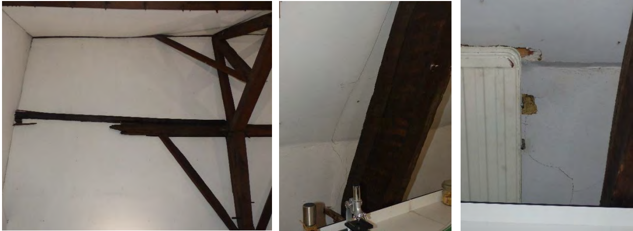
Figuur 332 (links) klooster, 2.02: Openstaande naad tussen afwerking hellend dak (AS, 17.10.2023)
