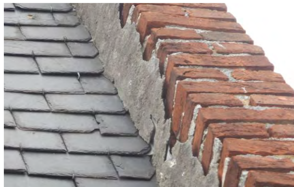
Figuur 101 (rechts) kapel, Z: Aansluiting zuidelijk dakvlak met oostgevel (Monumentenwacht, 2021)
