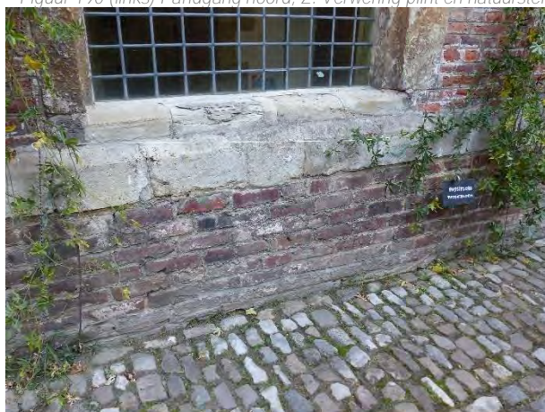
Figuur 191 Pandgang, noord Z: Verwering natuurstenen plintlijst (AS, 17.10.2023)
