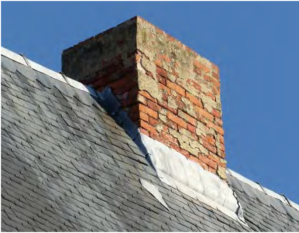
Figuur 178 Klooster, noordvleugel: Voegen schouwen verweerd door ontbreken deksteen (AS, 17.10.2023)
