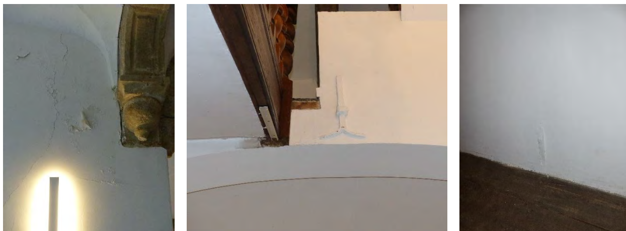
Figuur 294 (links) klooster, 0.09 (Z): Vochtschade door vochtdoorslag ter hoogte van de regenpijpen (AS, 17.10.2023)
