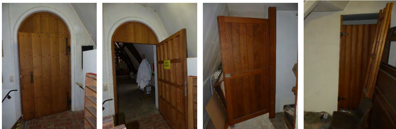
Figuur 434 (links) en Figuur 435 (midden links) klooster, 2.08-2.02: Opgeklampte deur geplaatst in 1987 (AS, 17.10.2023) Figuur 436 (midden rechts) en Figuur 437 (rechts) klooster, 2.08: Twee opgeklampte toiletdeuren (AS, 17.10.2023)
