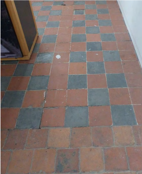
Figuur 139 (links) kapel, koor: Uitgesleten voegen en beschadigde tegels (AS, 17.10.2023)
