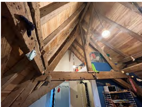
Foto's boven en links: oorspronkelijk (17 e eeuws?) dakgebinte. In restauratiefase 2013 voorzien van zichtbare onderdakbeboording in abeel.
