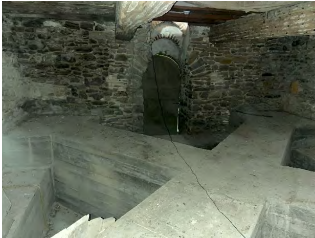
Onderste torennivo met betonverstevingen met deur aan westkant naar loopbrug in middenbeuk.
