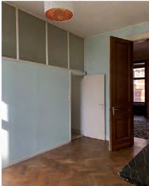
+01.06 nieuwe scheidingswand die de ruimte onlogisch indeelt; storende wand- en plafondaafwerkingen
