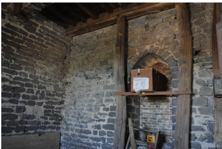
Afbeelding: derde verdiep van de toren: toegemaakt galmbordopening
