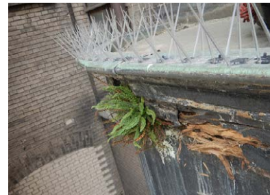
noordkoer: schade aan kroonlijst en pleisterwerk als gevolg van losse soldeernaad (MoWa, 2022)
