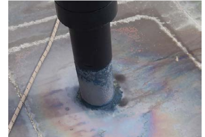
corrosie koper dak aan achtergevel (MoWa, 2022)
