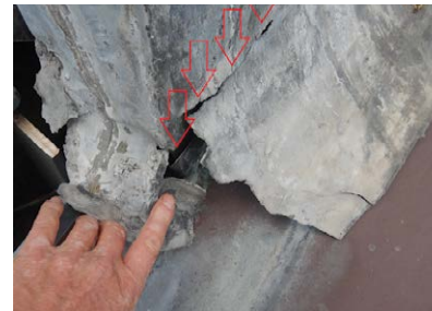
gescheurd lood, opstand dak 2 (MoWa, 2022)
