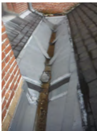
dak [9]: weggefallen stroken zink
