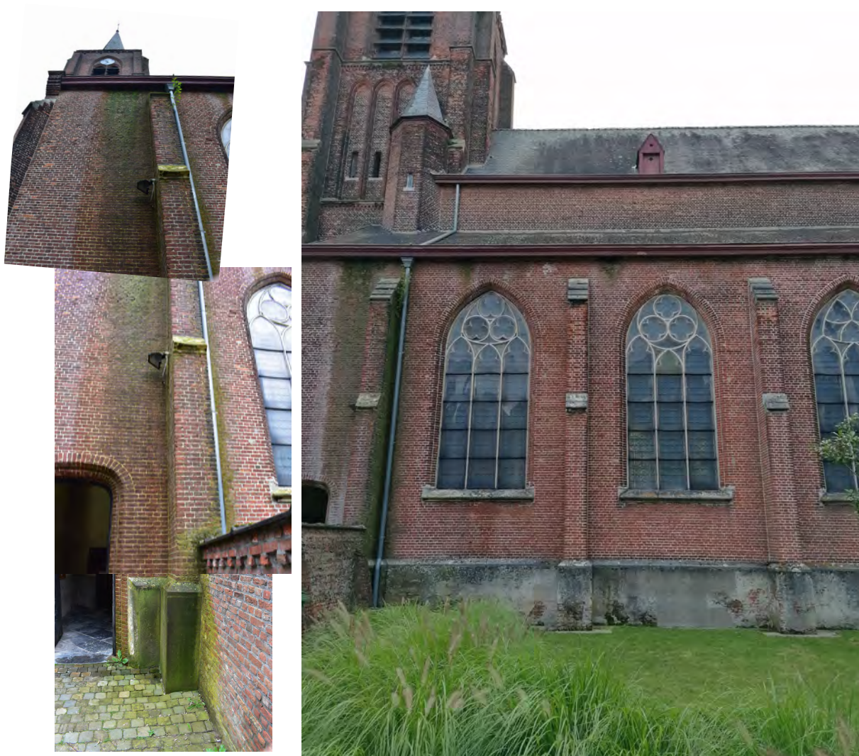
Figuur 24: Schadepatroon vochtinsijpeling door malfunctie dakgoten westgevel
