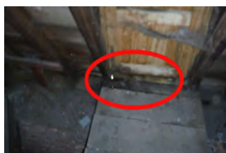
dak [5]-zuid: vochtinslag onderaan
