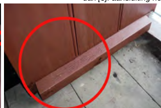
dak [5]-west: losse vijzen en schraal schilderwerk
