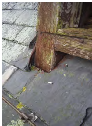
verweerd houtwerk en slechte dakaansluiting
