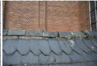
nok met slecht voegwerk
