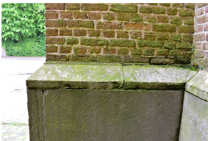
Figuur 75: mosvorming eerste travee westgevel Figuur 76: vochtschade aan zijdeur eerste travee westgevel (toren) Figuur 77: schade en zoutresidu aan natuurstenen elementen poort voorgevel Figuur 78: mostvorming natuurstenen plint voorgevel Figuur 79: mosvorming en vochtschade aan natuurstenen plint voorgevel
