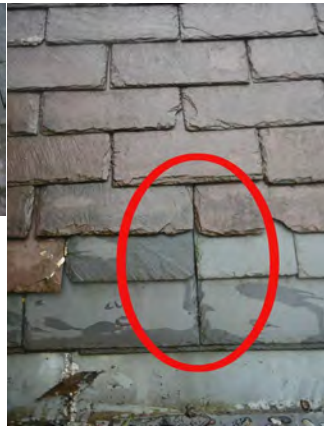
onoordeelkundige herstelling (doorlopende verticale naad)
