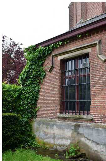
Figuur 80: vochtschade gecementeerde plint aanbouw koor oostgevel Figuur 81: detail vochtschade gecementeerde plint aanbouw koor oostgevel, imitatievoegen Figuur 82: detail en bioturbatie schade gece- menteerde plint Figuur 83: detail schade gecementeerde plint Figuur 84: detail schade gecementeerde plint Figuur 85: detail mos- en algvorming gecemen- teerde plint Figuur 86: overzicht schadezicht aanbouw Figuur 87: detail schade hoekstructuur gece- menteerde plint
