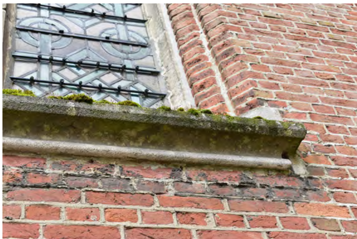
Figuur 91: zijdeur toren Figuur 92: spitsboog glas-in-lood venster oostgevel Figuur 93: detail vochtschade natuursteen venster
