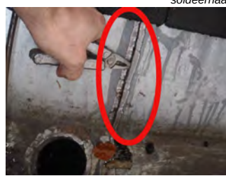
dak [8]: gescheurde soldeernaad
