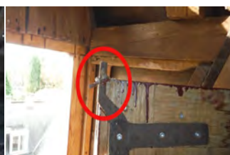
dak [5]-zuid: losgekomen scharnier
