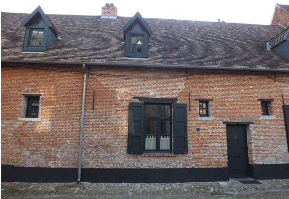
Foto 85 voorbeeld van slecht plaatselijk herstel van voegwerk
