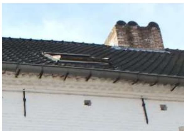
Foto 148 Kerkstraat 11: Kraaieneststraat 13: dakvlakramen: storend element
