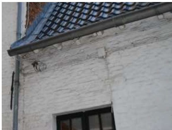
Foto 96 Storende bekabeling aan de voorgevels van de begijnhoven.
