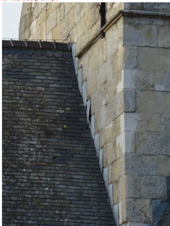
Fig. 154 – Losgekomen loketten aan de verbinding van het dak van de zuidelijke dwarsbeuk met de toren.
