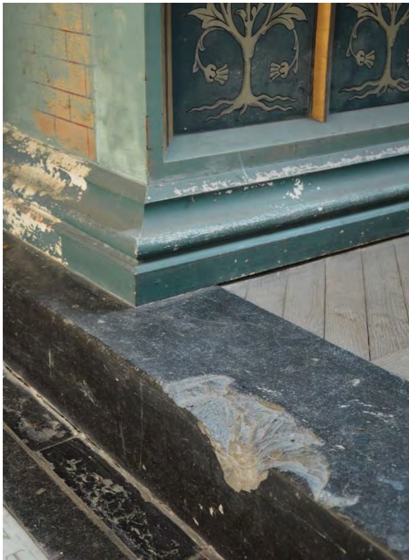
Fig. 166 – Verdwenen verlaag op hoofdaltaar en gebroken natuurstenen trede.
