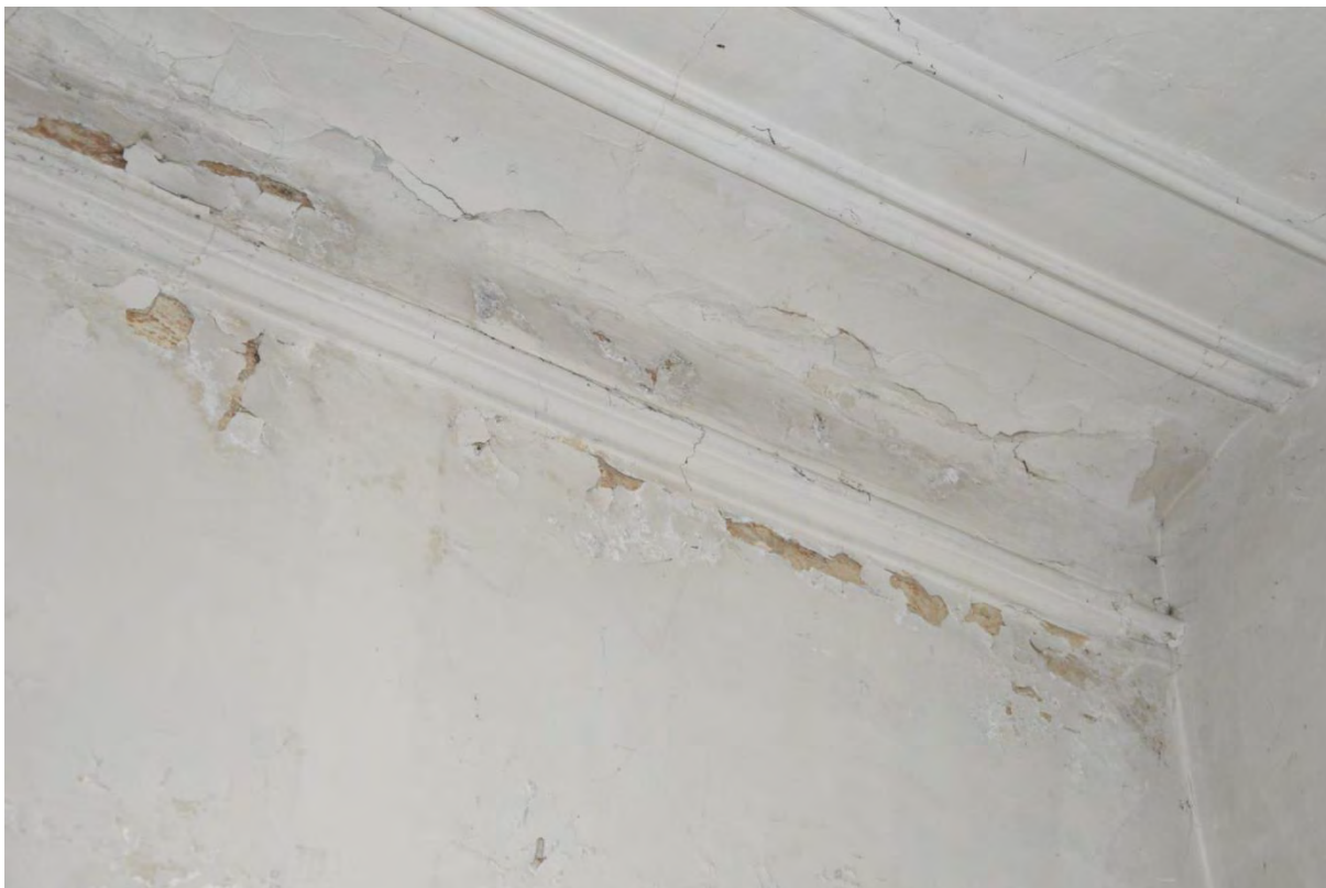
Fig. 168 – Vochtschade op het plafond in de sacristie.
