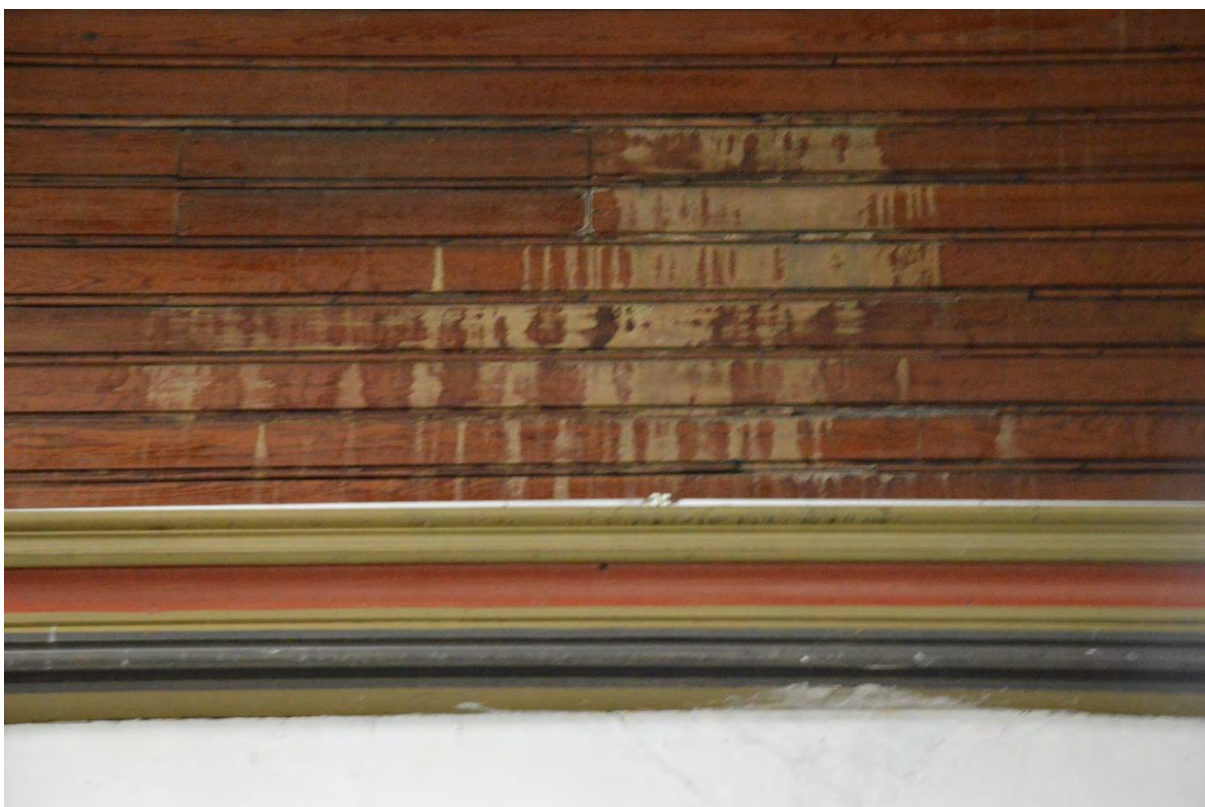
Fig. 169 – Vochtschade door waterinfiltratie op het tongewelf in het kerkinterieur (oorzaak reeds hersteld).
