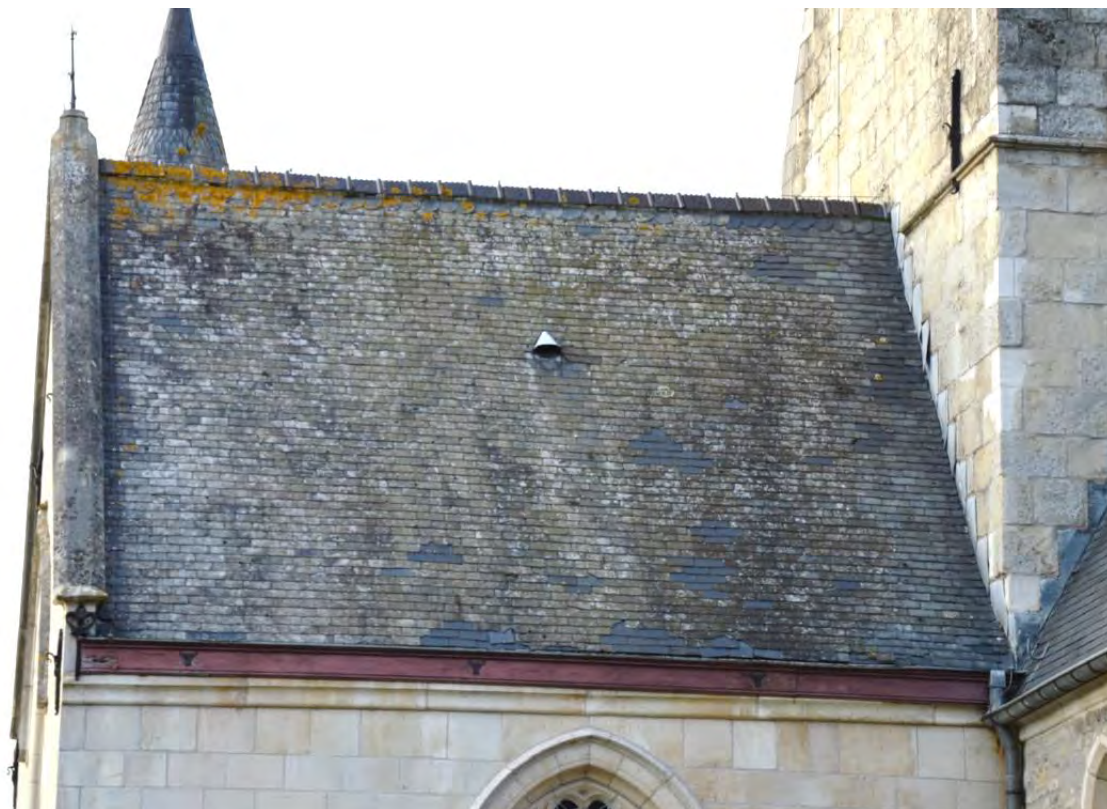
Fig. 152 – Dak van de noordelijke dwarsbeuk: mosgroei, enkele weggevallen leien, een losgekomen loodloket bij de aansluiting op de torenwand, verweerd schilderwerk van de boeiplank,...
