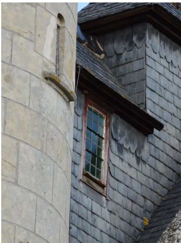
Fig. 159 – Verweerd houten buitenschrijnwerk.
