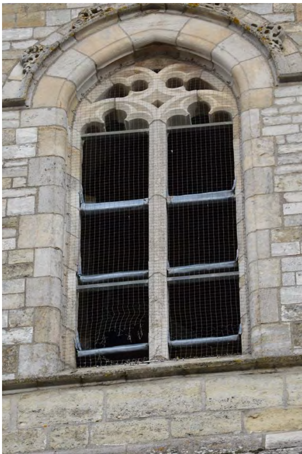
Fig. 175 – Beschadigde vogelwering op de toren.
