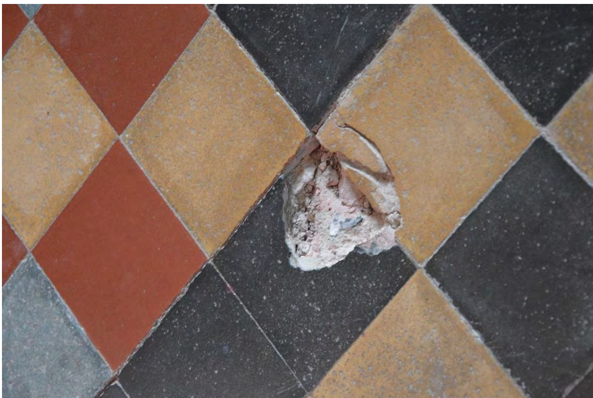
Fig. 171 – Beschadiging tegelvloer in kerk.
