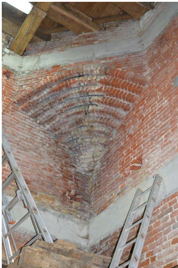
Fig. 176 – Vochtschade in toren, t.h.v. de afzaten.
