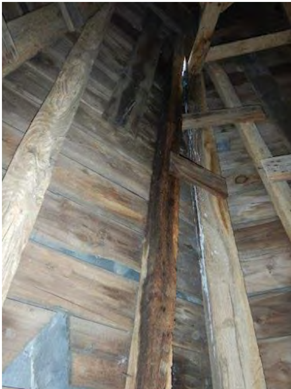
Fig. 173 – Vochtschade op een rib in de toren. (foto: Monumentenwacht, 2021)
