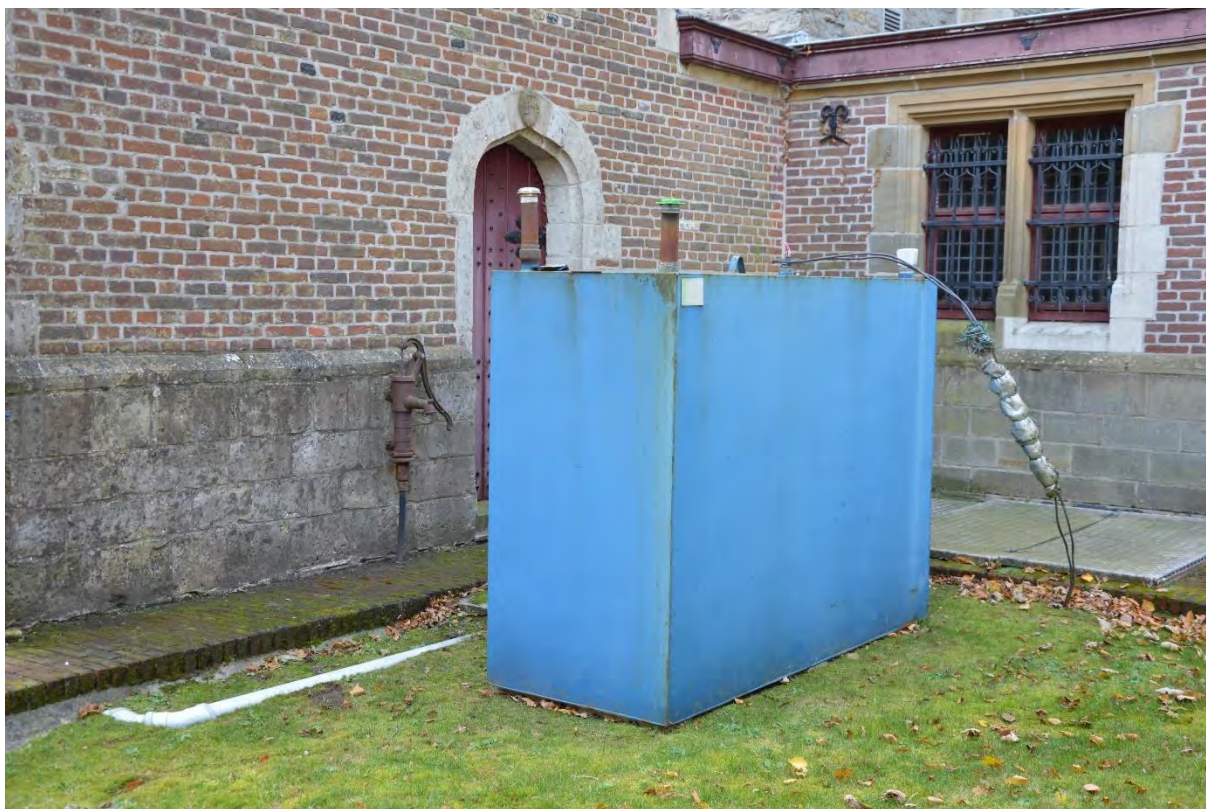
Fig. 182 - Bovengrondse stookolietank en achterliggend toegangsluik naar de stookruimte.
