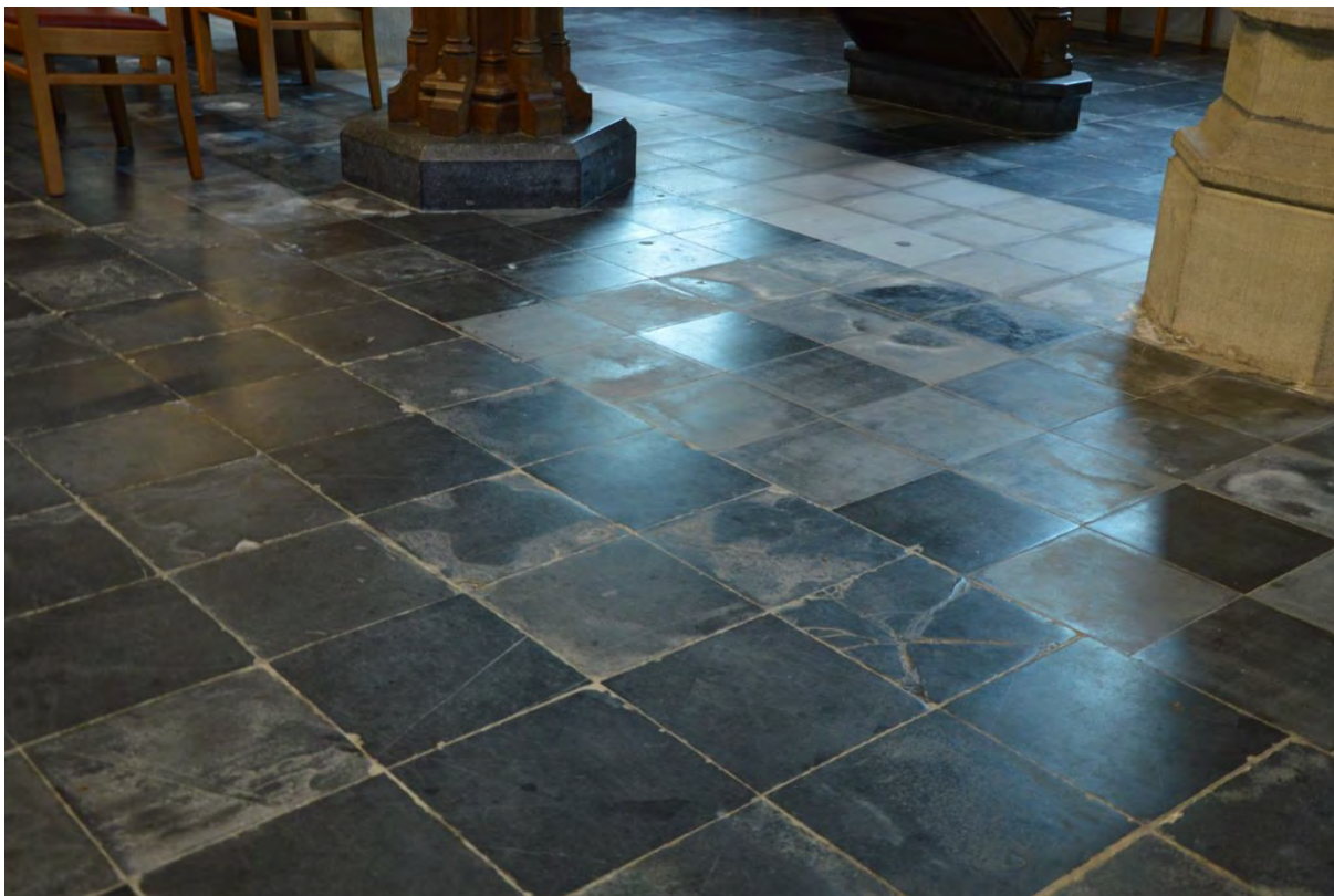
Fig. 170 – Gebarsten en verkleurde tegels.
