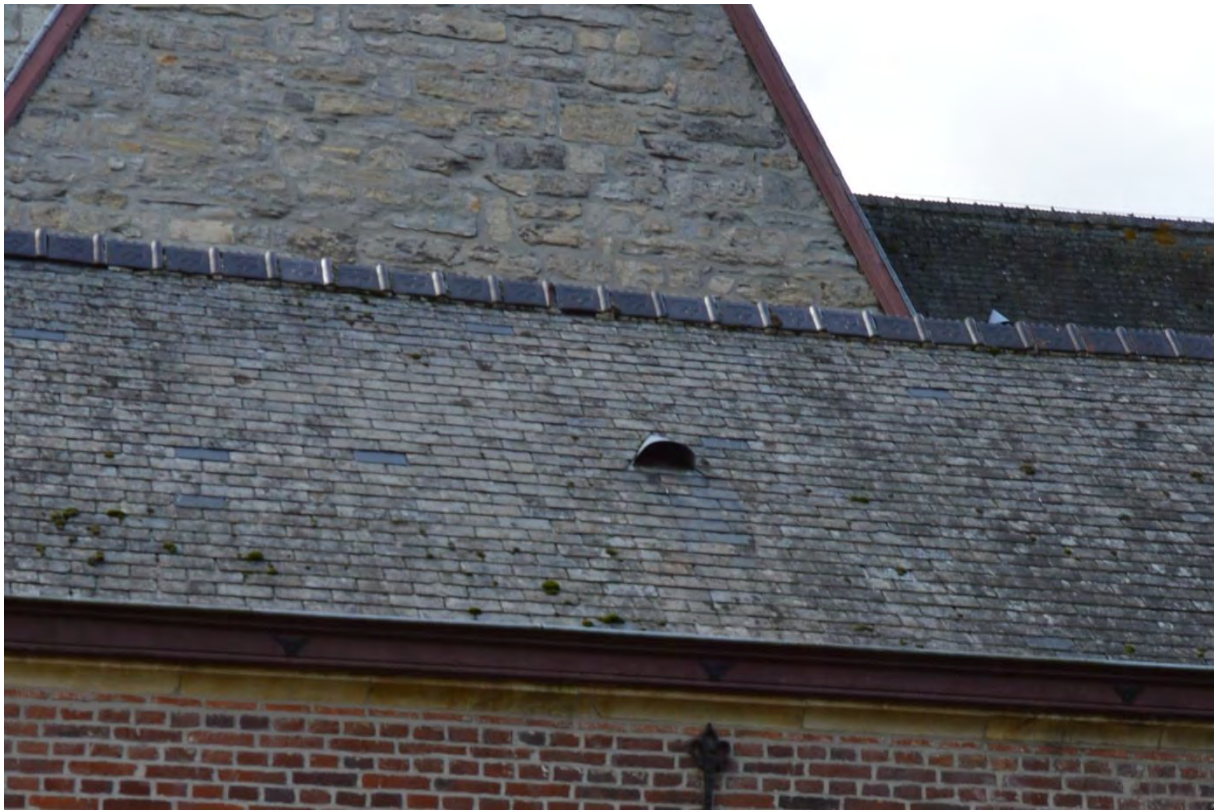
Fig. 155 – Weggefallen voegmortel onder de nokpannen.
