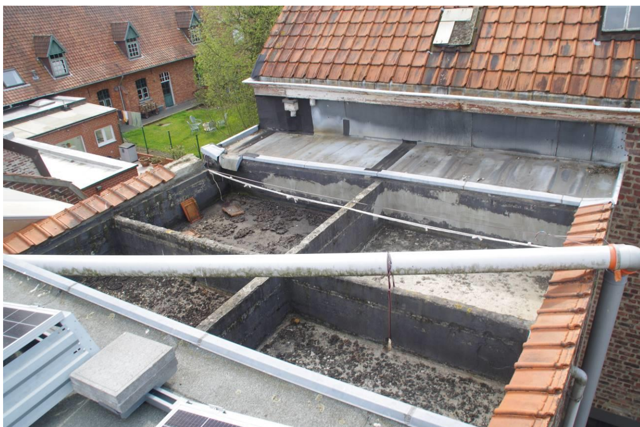
Figuur 115: wateropvang bakken op het dak van het doorgangsvolume
