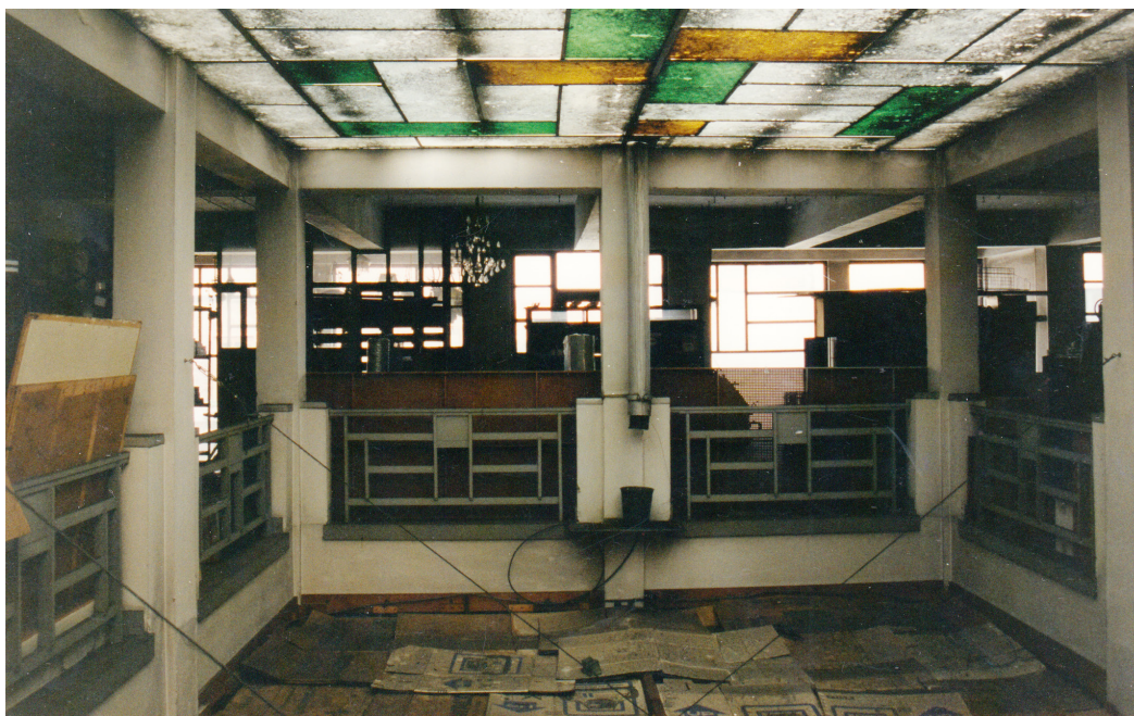
Figuur 37: Gesloopte trap en verlaagd plafond in de vide (© Vlaamse Overheid, 22/03/2000)
