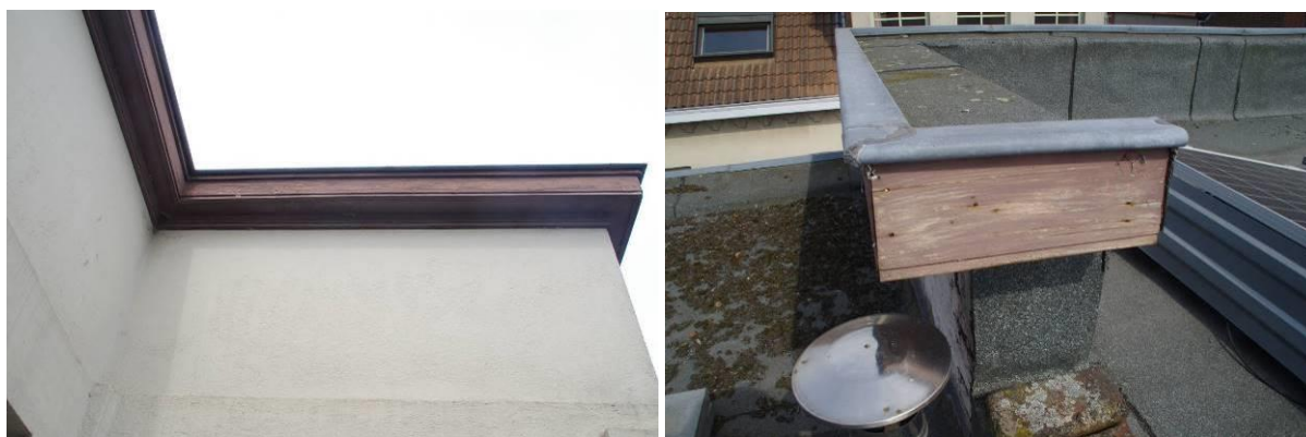
Figuur 79 - 80: detail van de doorlopende kroonlijst aan de voorgevel
