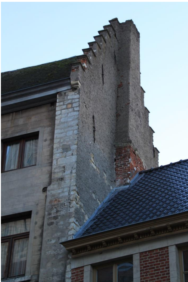
Afb. 15 Tienen, Wolmarkt 15: zijtrapgevel met buiten werking gestelde schoorsteen buurpand Wolmarkt 13 - © Hekate, 2016
