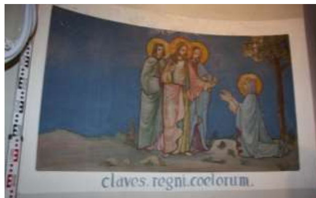
33 Zuidelijk absidiool: muurschildering met schade (verfafschildering, druipsproen, ed).
