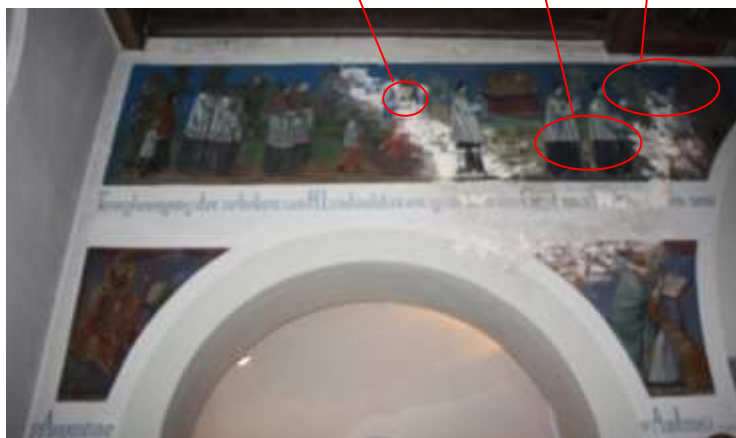
30: muurschildering boven het noordelijk absidiool: schade en aanpassingen van de details.
