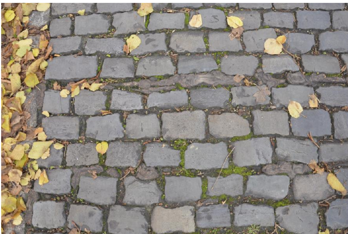
Figuur 33. - Sophie Van Akenstraat. Boomwortels tussen de gerecupereerde kasseistenen.
