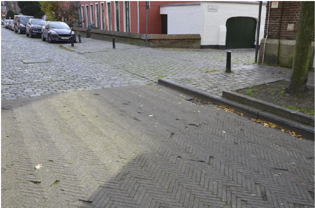
Afb. 45. - Niet passend type bestrating aan het begin van de E. Boonenstraat.
