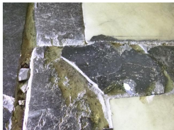
Verbrijzeling van de natuursteen nabij open voegen.
