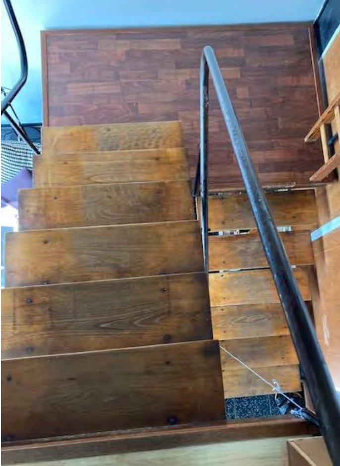
Gebruikssporen houten treden, donker laminaat halfweg
