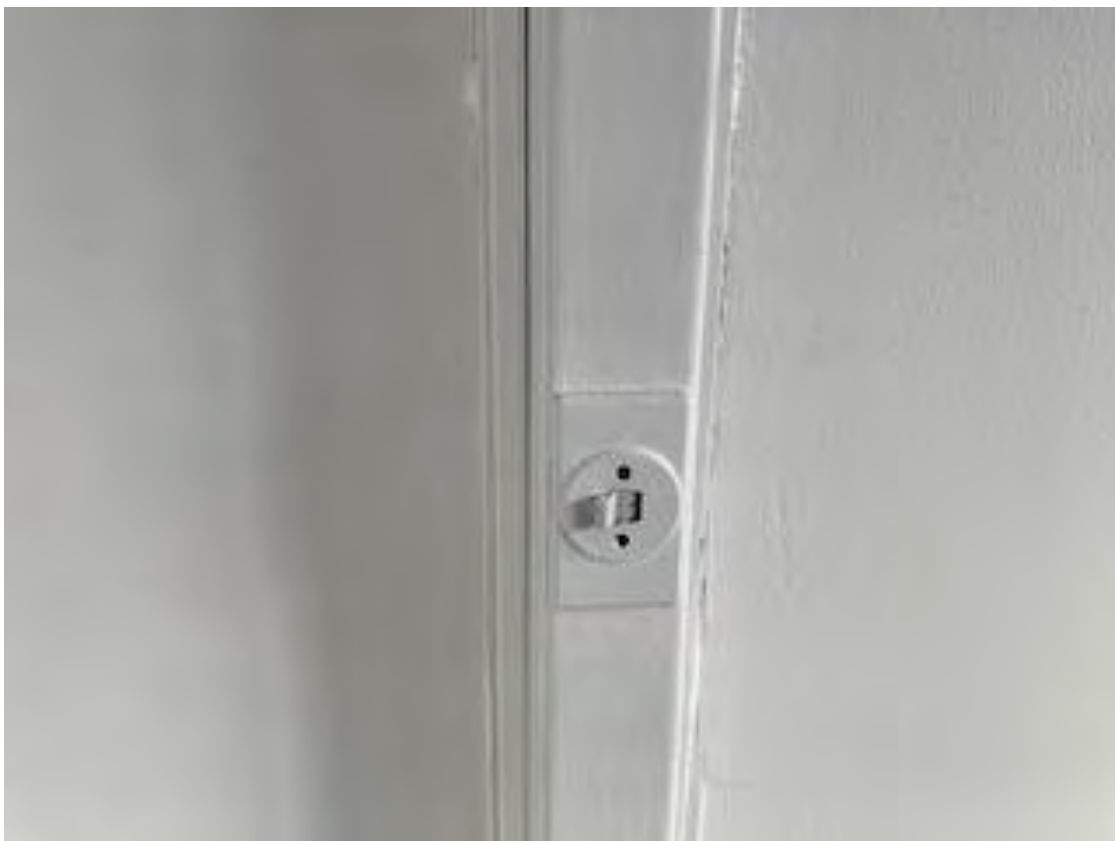
Oorspronkelijke positie van schakelaars op het metalen frame
