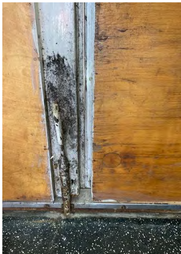
Schimmel onderkant deur remise
