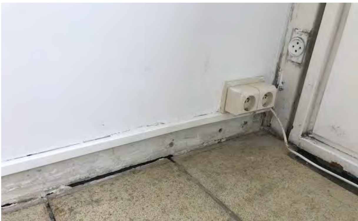
Origineel stopcontact op frame, en latere stopcontacten/bekabeling, afwerking vloer en zwarte plint ontbreekt
