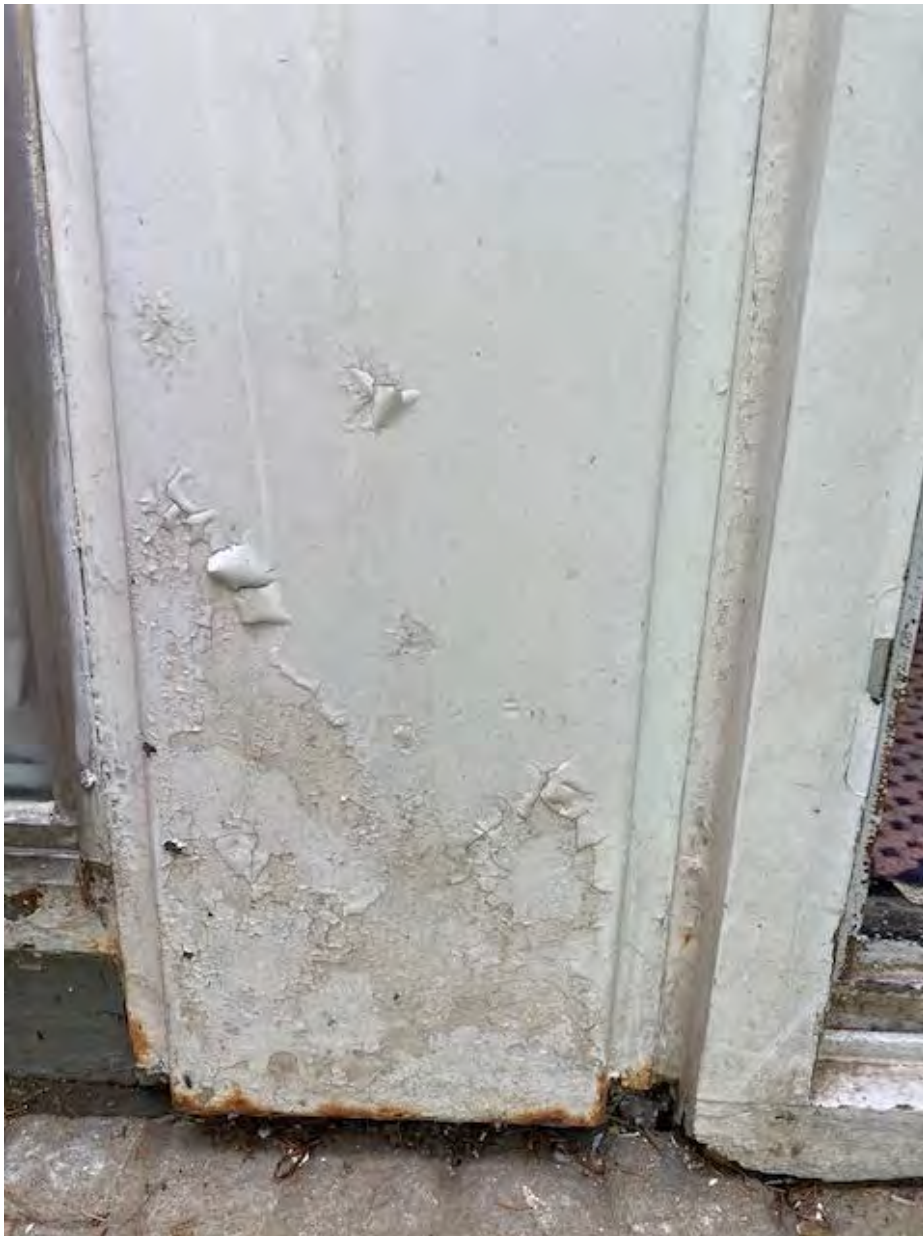
Achtergevel: Roest en afschilfering portiek
