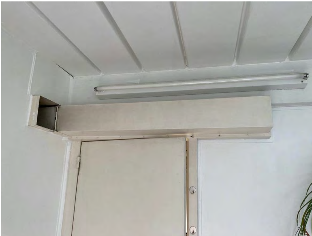
Buizensysteem met luik voor verwarming, originele neon
