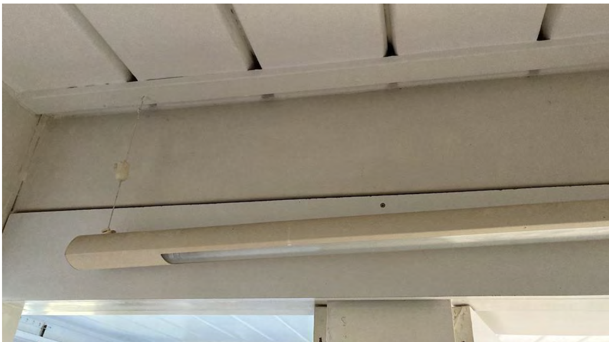
Recent multiplex panel voor stalen portiek, structuur van recentere neonlamp hangt los
