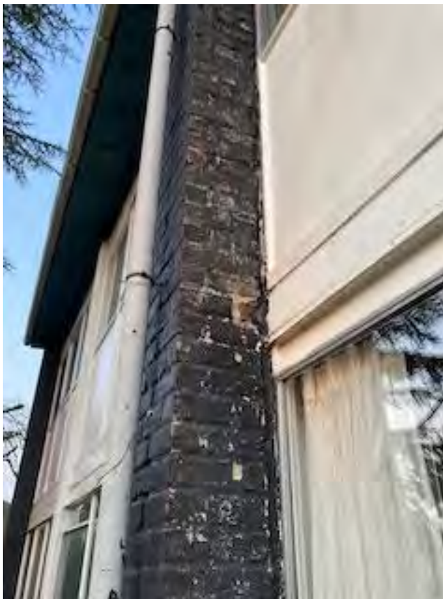
Bakstenen kolom, achtergevel, zwart, afbladerend
