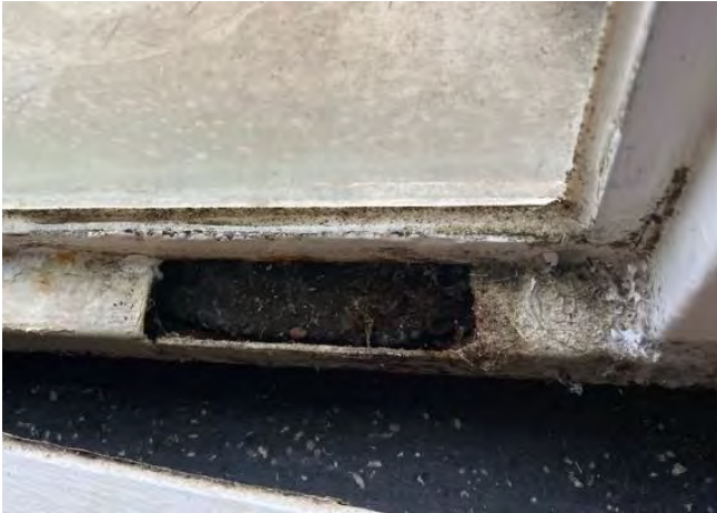
Gat metalen frame, water komt hier binnen bij regen, schimmel
