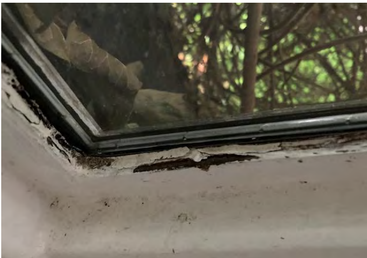
Mastiek en verf rond raamranden verduurd (badkamer)
