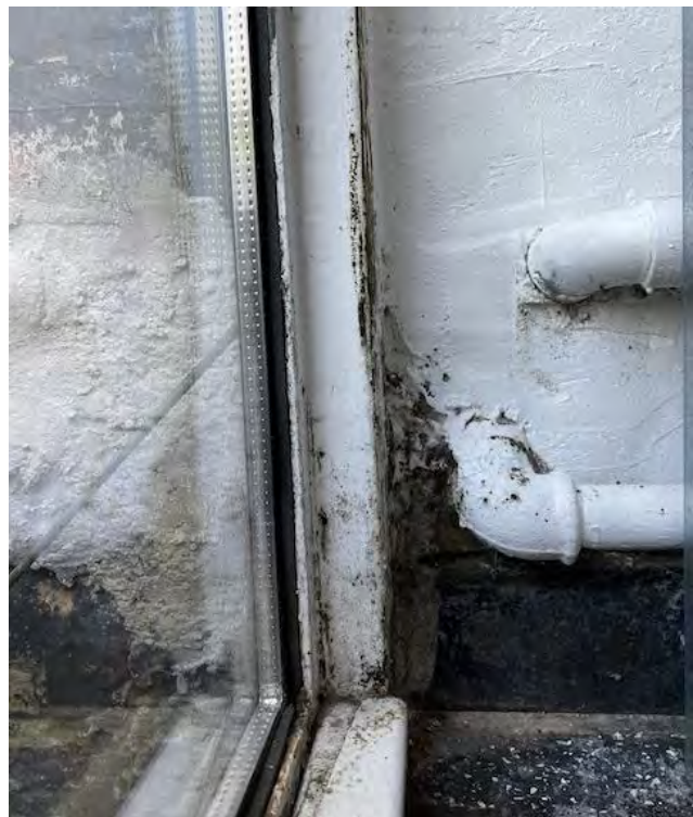
Vochtplek hoek eetzone, schimmel op muur en frame
