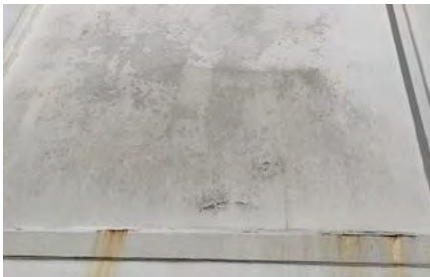
Roest, barsten, gaten, afschildering metalen panelen
