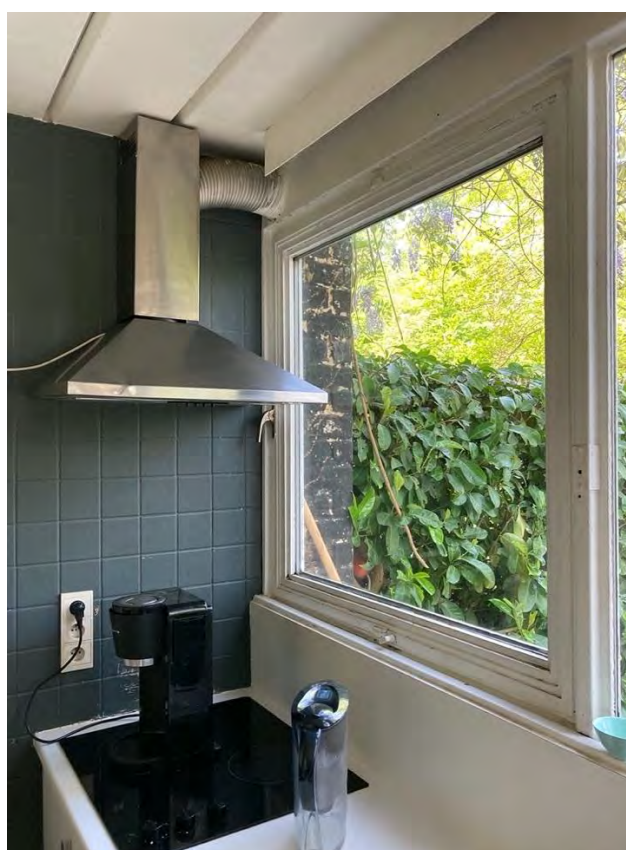
Dampkap blokkeert verplaatst draairaam
