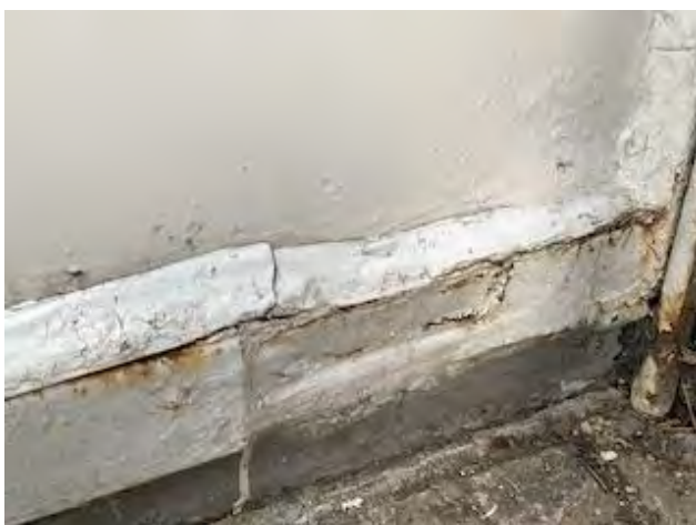
Gaten en roest metalen structuur en raamkaders achtergevel
