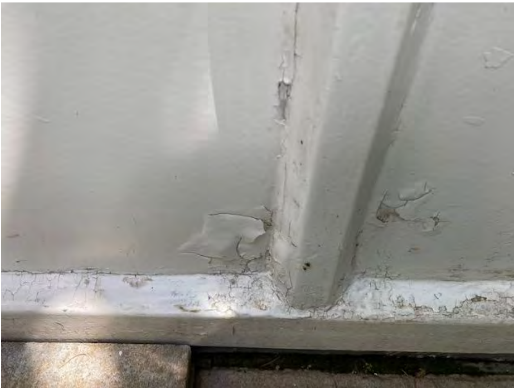
Afschilferende verf metaalvlieswanden achtergevel
