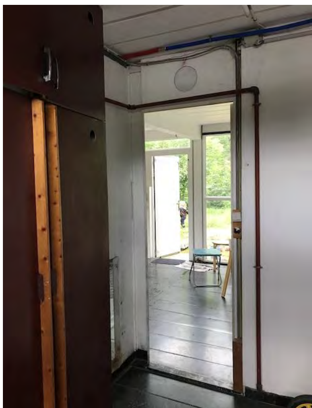
Zicht van remise op leefruimte, zicht op bekabeling
