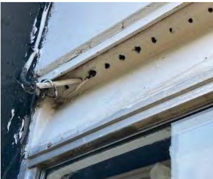
Verluchtingsgaten later gebruikt om kabels binnen te trekken
