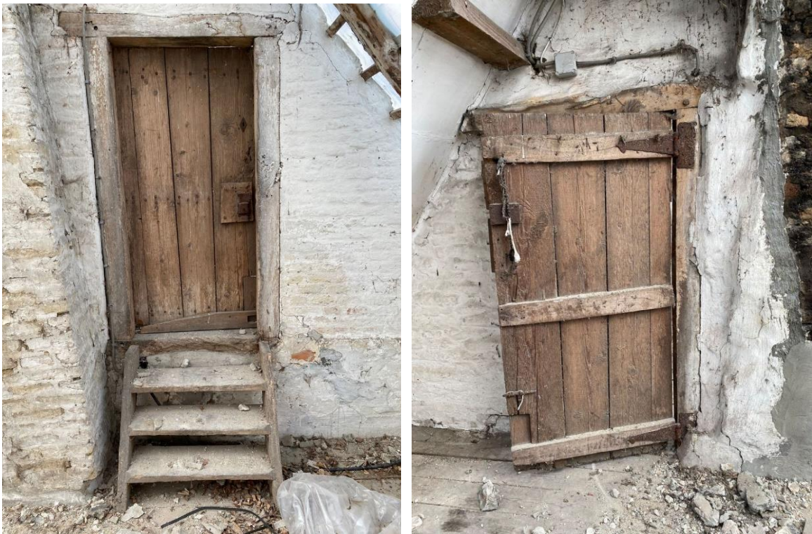
De opgeklampte deur naar de zolder boven de voute.
