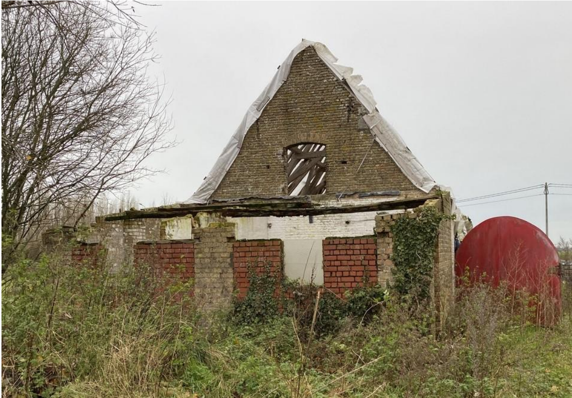
De zuidelijke puntgevel met daarvoor de bouwvallige zuidelijke aanbouw.
