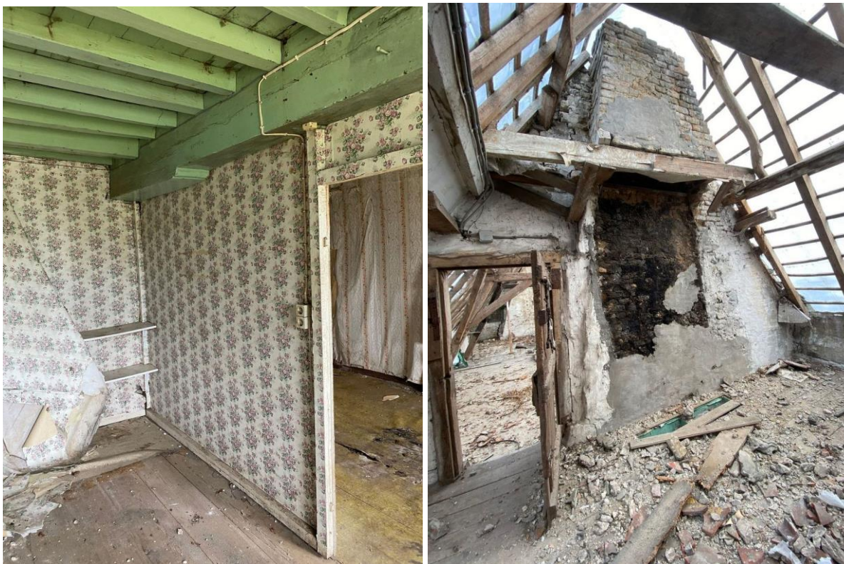
De voutekamer vanuit het noordoosten (links); de resten van de schoorsteenpijp van de verdwenen openhaard (rechts) op de opzolder.
