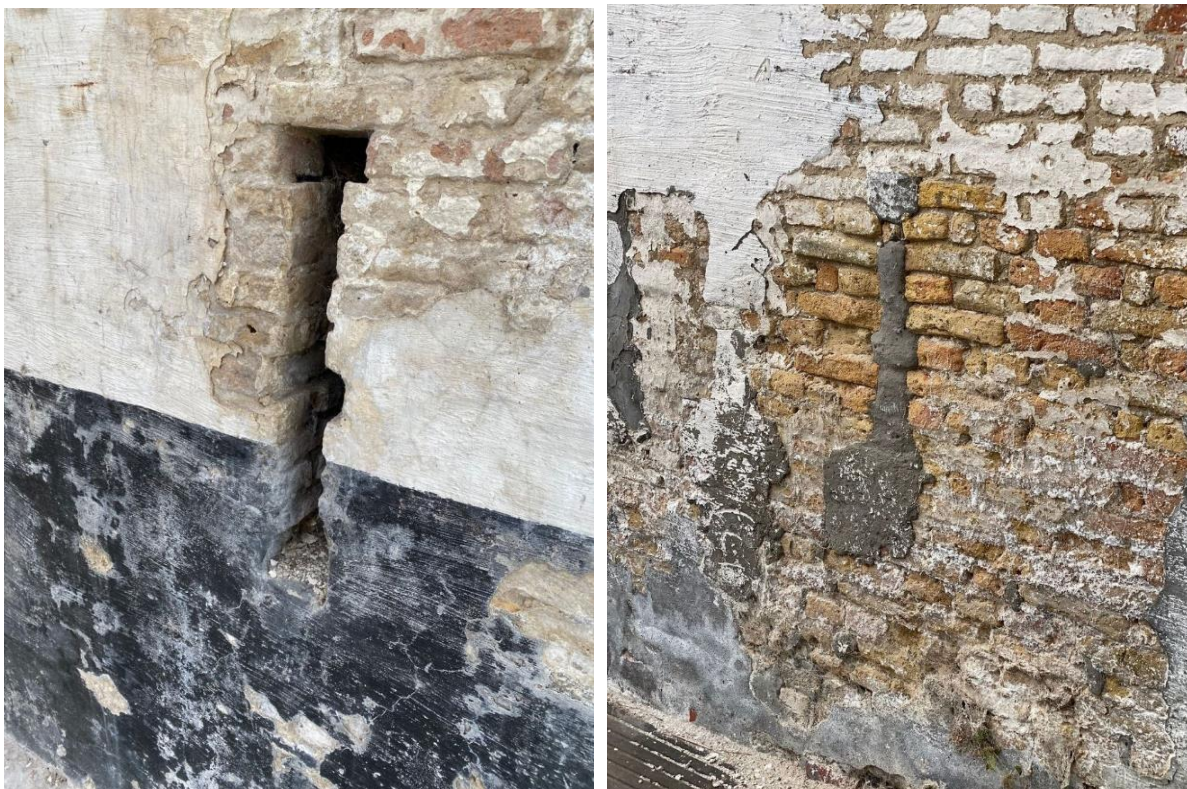
De verluchttingsgaten. Deze werden van buitenuit allemaal slordig gedicht.
