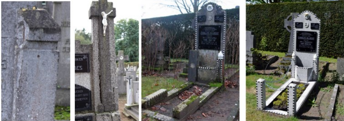
Graftekens met betonrot (2_H_13 en 3_H_5.)
