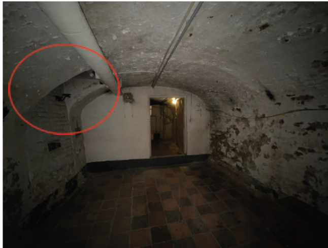
F3: Kelder 2 (aewelfd is erfgoedelement): Relatief recente vloer Aanduiding van vermoedelijk oud trapgat/ oud keldergat voor leveringen?
