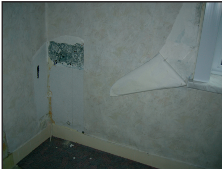
fig. 5: Isomoplaten onderaan de muren - A. Mechelincklaan 8
