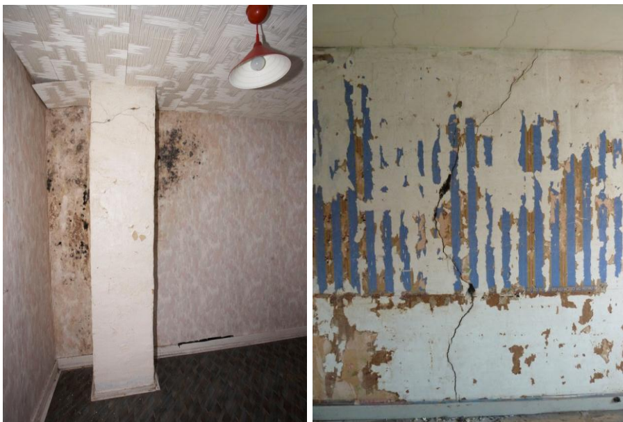
Foto 28 / 29 : Kardinaal Mercierplein nr4 (schimmelvorming op vochtplekken pleisterwerk) (© Onroerend Erfgoed)
