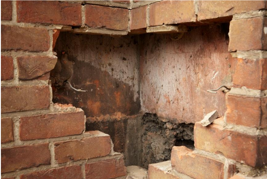
Foto 14 : Kardinaal Mercierplein 15 :bakstenen voorzetwand, wand in asbeton met beschadigde plint(© Onroerend Erfgoed)
