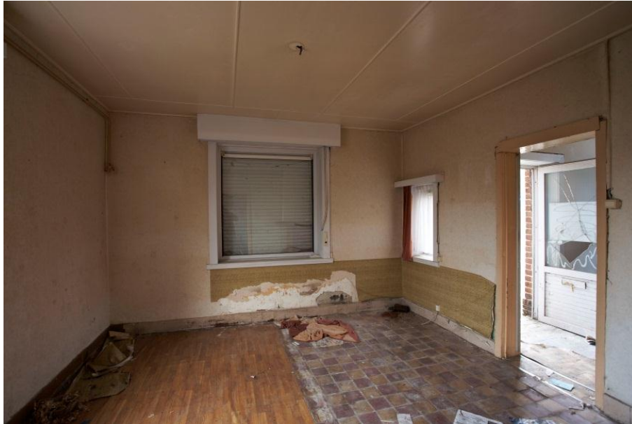
Foto 25: Kardinaal Mercierplein nr4 : beschadigde tegelvloer afgedekt met kunststofvloer (© Onroerend Erfgoed)
