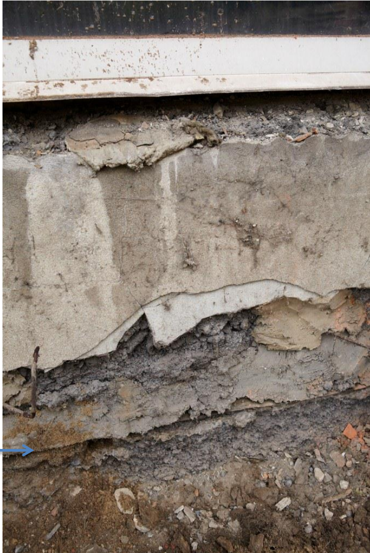
Foto 13: Kardinaal Mercierplein 15: buitenzijde buitenmuur: vochtwerende slab in asbeton (© Onroerend Erfgoed)
