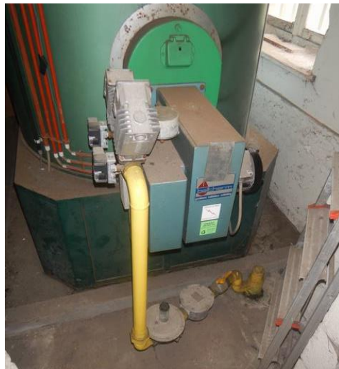
Cv-installatie op gas
