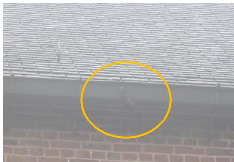
Scheef hangende gootbeugel dakvlak [17]
