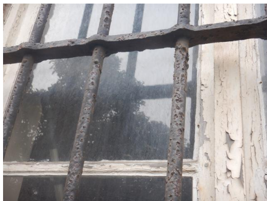
Diefijzers berging/stooklokaal. Deze ijzers vertonen een grotere oppervlakte roestvorming
