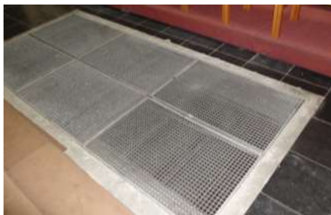
Vloerrooster verwarming in zijbeuk noord.
