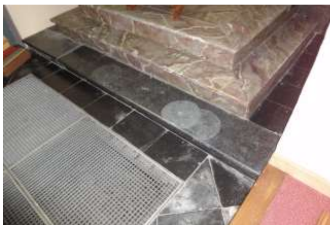
Vloerrooster verwarming in zijbeuk noord.
