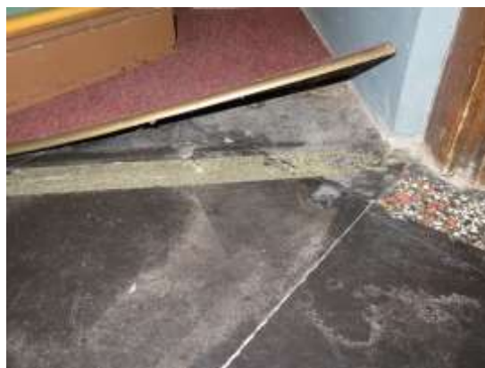
Beschadiging vloer door kleefstroken van tapijt
