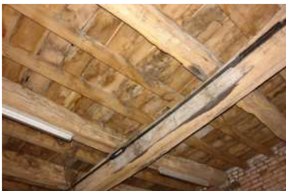
Vloer klokkenzolder, aangetaste balken.
