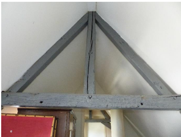
Figuur 164 Nummer 4: getelmerkt A-spant, korbelen ontbreken, makelaar gebarsten (13.10.2021)
