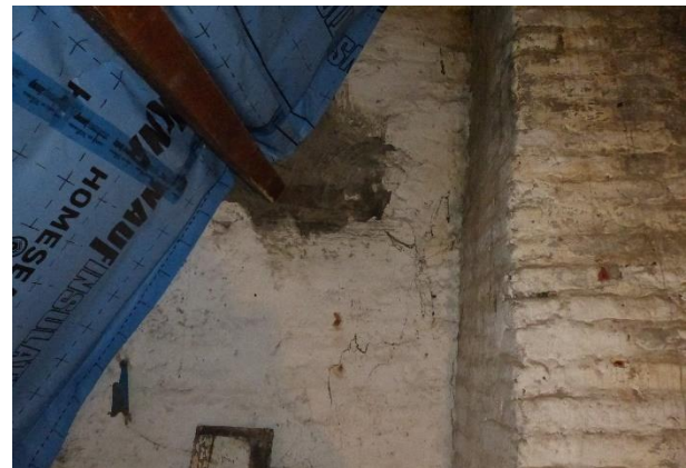
Figuur 184 Nummer 17: gekaleide afwerking vervuild, sporen van vochtinfiltratie op schouw kanaal (13.10.2021)
