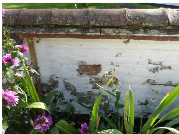
Figuur 105 Staat metselwerk gezien vanuit tuin. Rechts bloeit een viooltje in een metselwerkvoeg (13.10.2021)
