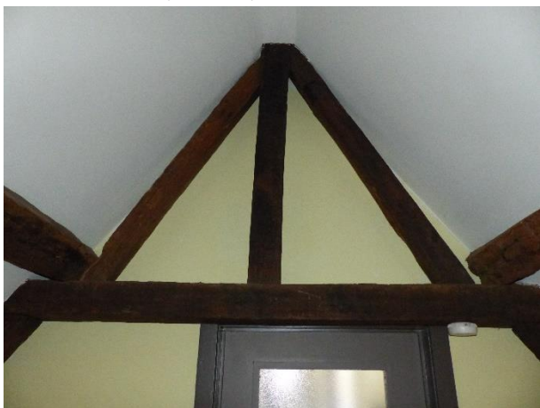
Figuur 166 Nummer 6: Getelmerkt A-spant opgenomen in scheidingswand (13.10.2021)
