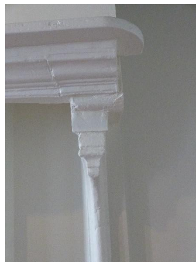
Figuur 226 Nummer 9: detail bovenzijde schouwwang (13.10.2021)
