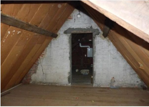
Figuur 153 Nummer 2: scheuren in metselwerk voormalige scheidingsmuur (13.10.2021)
