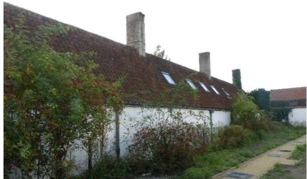
Figuur 111 Achtergevel Gloribus: gedeelde schouwen tussen woningen nummer 2 en 4 en tussen woningen nummer 4 en 6 en schouw van woning nummer 6 (13.10.2021)
