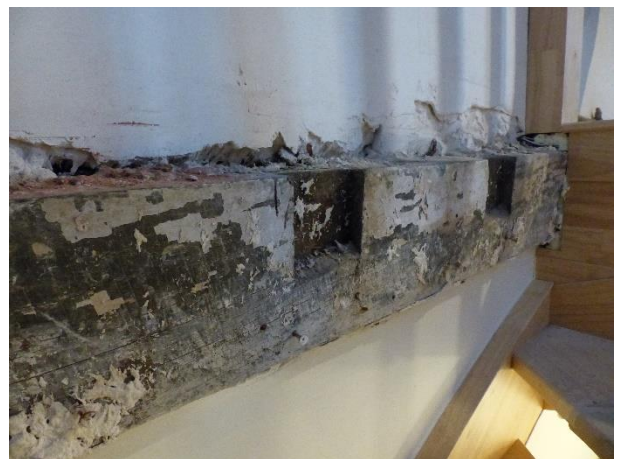
Figuur 175 Nummer 9: strijk balk langsheen trapgat. Uitsparing voor moerbalken loopt door tot voormalige achtergevel: trapgat was oorspronkelijk kleiner. (13.10.2021)
