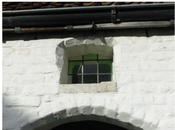
Figuur 148 Nummer 2: glas-in-loodvenster boven toegangsdeur; een van de kalibers is gebroken (13.10.2021)
