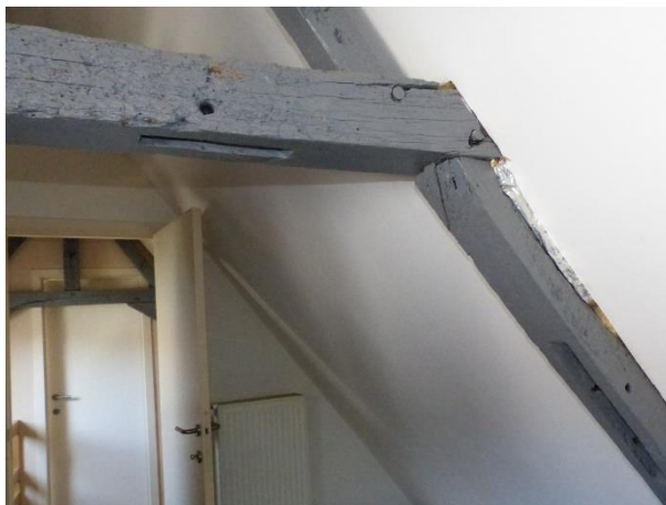
Figuur 165 Nummer 4: detail spant: (recente?) sporen van houtborende insecten, diverse scheuren vermoedelijk door brand (13.10.2021)
