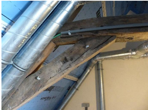
Figuur 156 Nummer 9: detail spant: zichtbare aantastingen en scheurvorming (13.10.2021)
