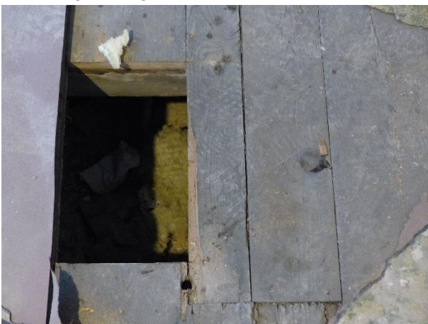
Figuur 187 Nummer 9: opening in vloer toont isolatie onder zoldervloer (13.10.2021)
