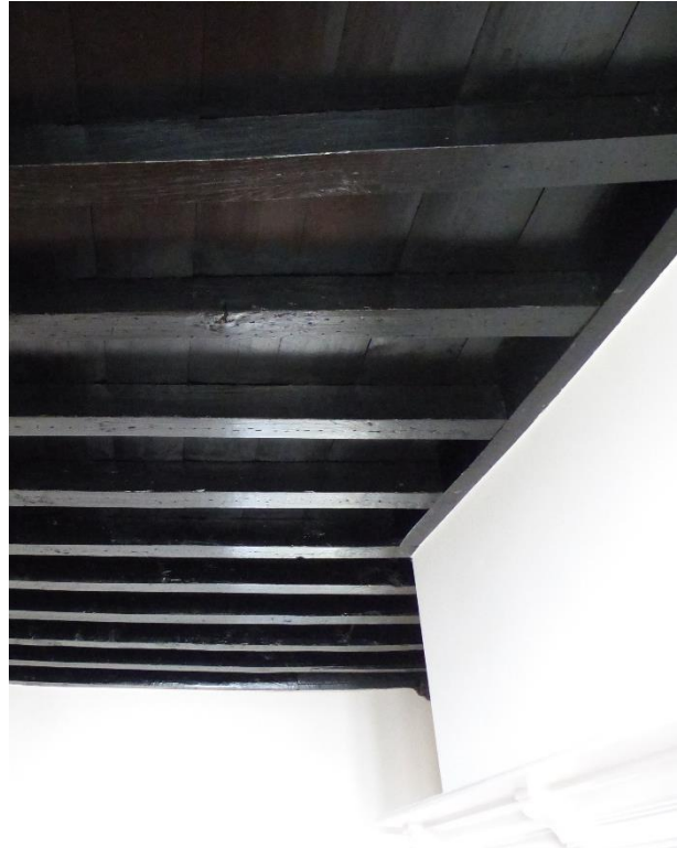
Figuur 177 Nummer 11: ravelconstructie rond schouwmantel. Onderzijde kinderbalken bevat spijkeropeningen in langsrichting (13.10.2021)
