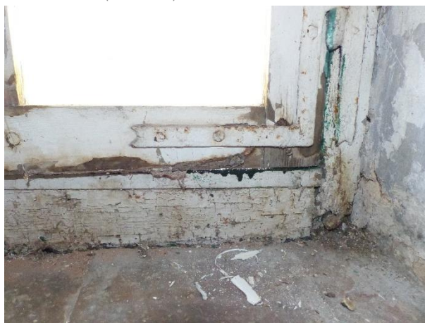
Figuur 140 Nummer 11: detail staat houten onderdelen zolderraam (13.10.2021)
