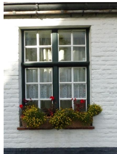
Figuur 94 Raamopening met zichtbaar houten linteel en gebroken tegeldorpel (13.10.2021)
