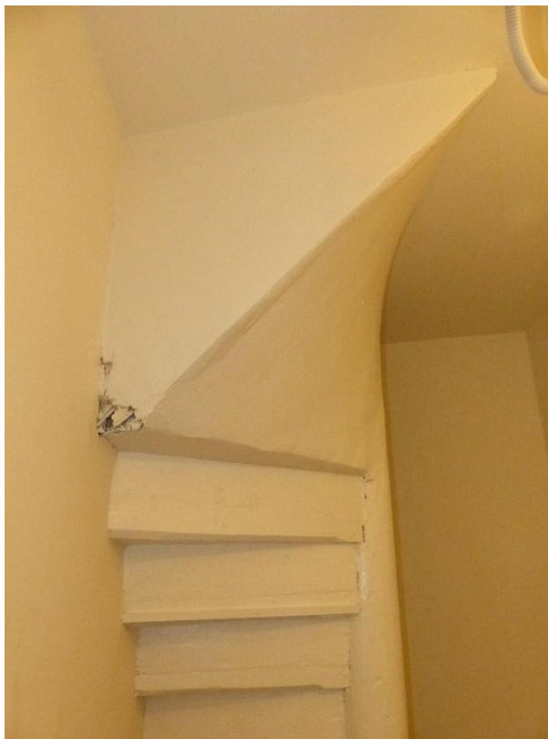
Figuur 211 Nummer 17: Onderzijde van het bovenste gedeelte is uitgepleisterd (13.10.2021)
