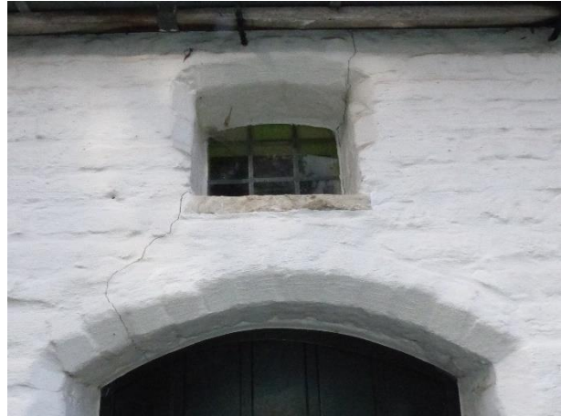
Figuur 91 Verticale barst boven vensteropening en diagonale barst tussen vensteropening en deuropening bij nummer 6 (16.10.2021)
