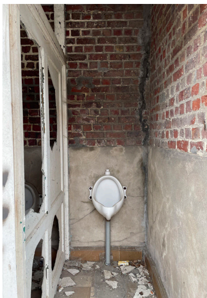
Afb. 78. — D0.23 - barsten in bakstenen wand en beschadigde tegelvloer
