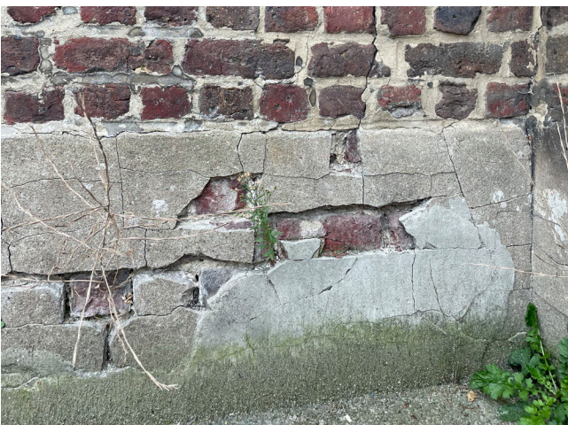
Afb. 92. – Detail gebarsten wandcementering
