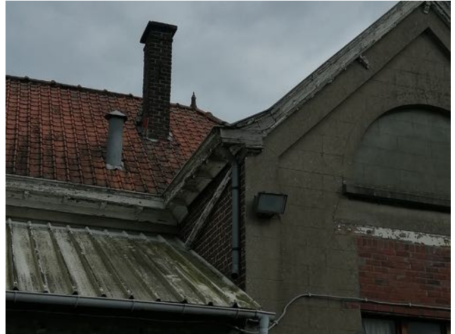
Afb. 60. — Detail van afgevalen, houten boordplank
