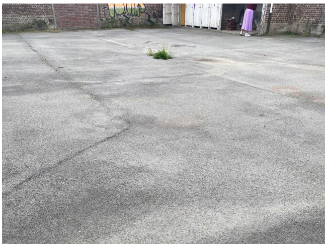
Afb. 65. – Zicht asfaltlaagmet lange barstvorming
