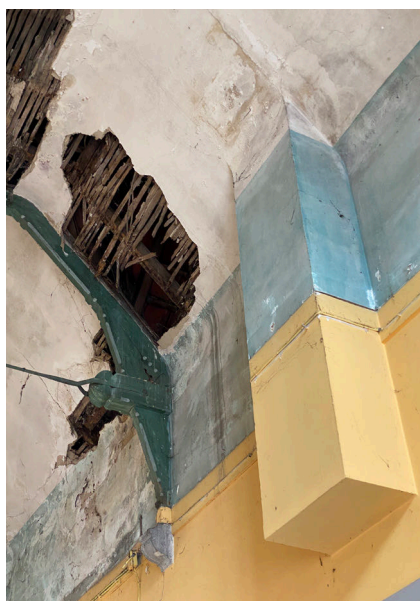
Afb. 128. – Beschadigd plafond werkklas
