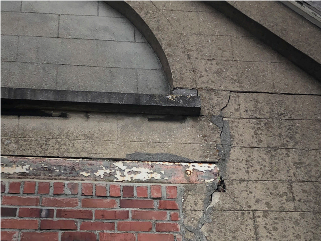
Afb. 59. — Detail scheuren aan ijzeren latei - R0.09 en R0.10
