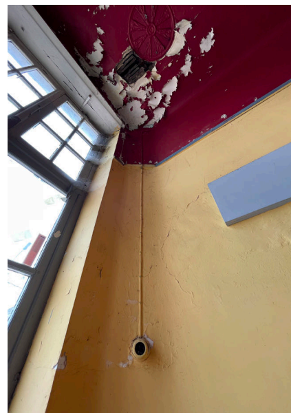
Afb. 171. – Zicht beschadigd plafond
