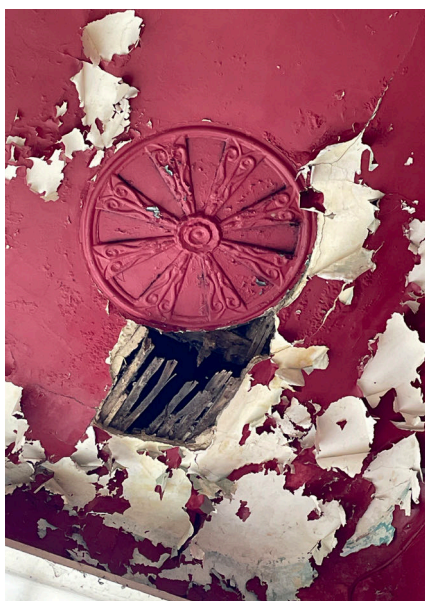
Afb. 172. – Zicht beschadigd plafond
