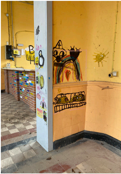
Afb. 145. – Zicht bekladde muur
