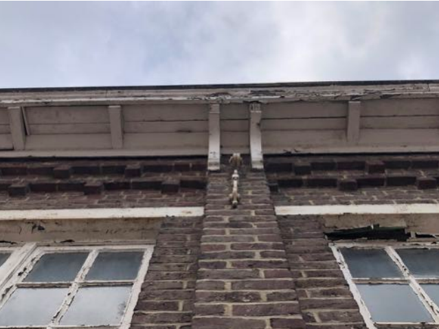
Afb. 13. – Detail dakoversteek, losse verfschijfers t.h.v. de ijzeren latei
