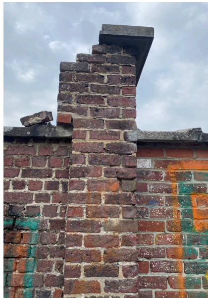
Afb. 119. – Detail gebroken deksteen en kolom
