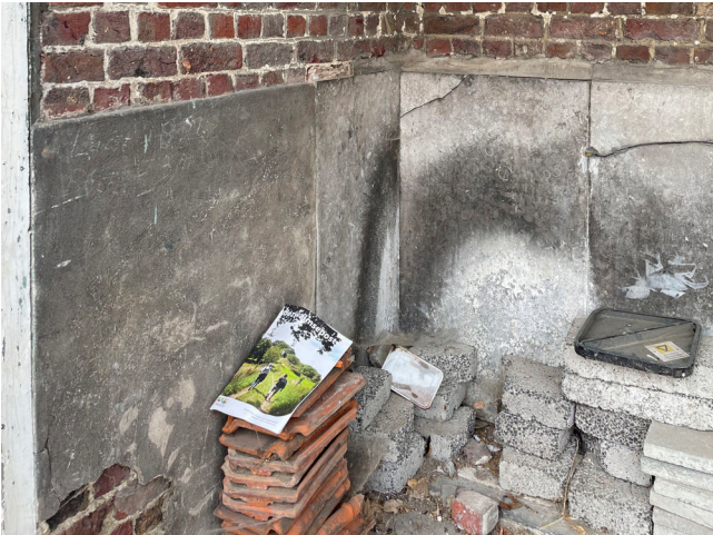
Afb. 88. – Detail gebarsten arduin en wandcementering van de pissijns
