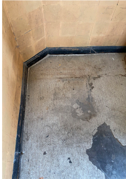
Afb. 140. – Zicht afgeschuinde hoek en beschadigde vloer werkklas
