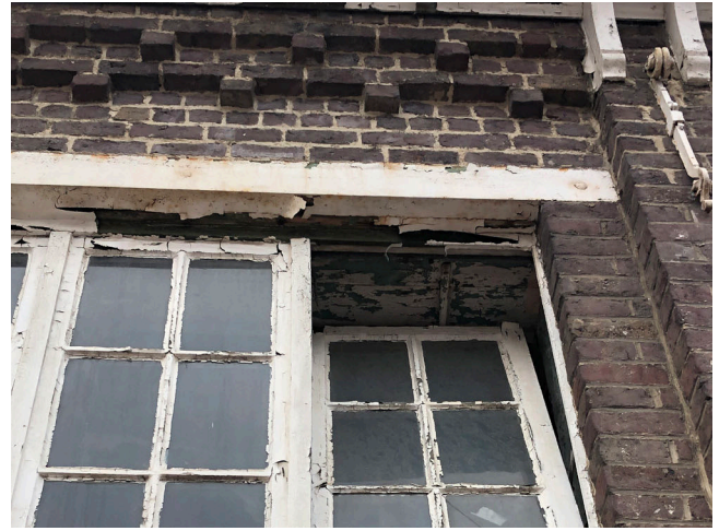
Afb. 16. – Ijzeren latei vertoont roest en afbladerende verf
