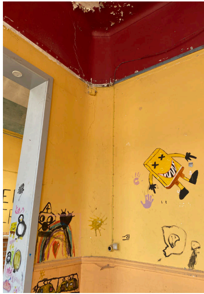
Afb. 146. – Zicht bekladde muur
