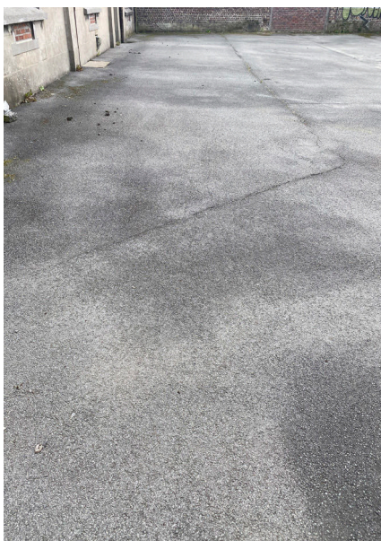
Afb. 69. –Asfaltlaag met barstvorming
