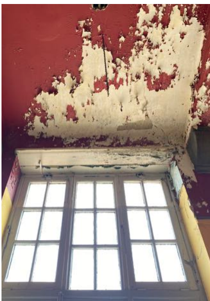
Afb. 151. – Zicht beschadigd plafond
