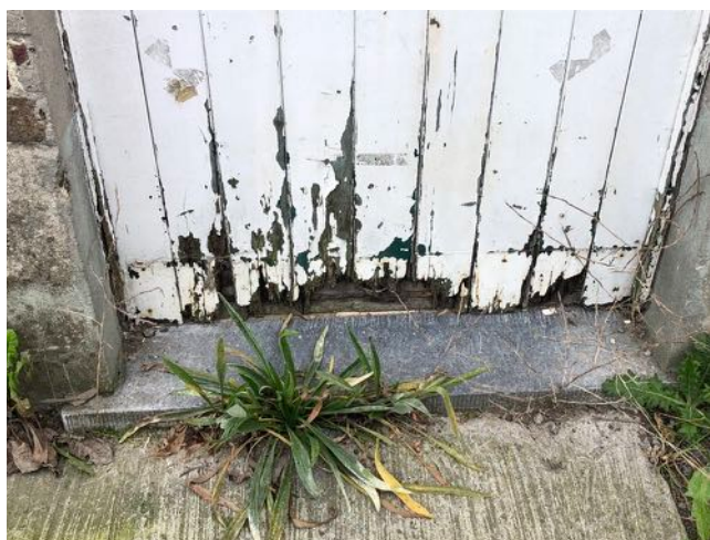
Afb. 22. — Detail van schade plankendeur
