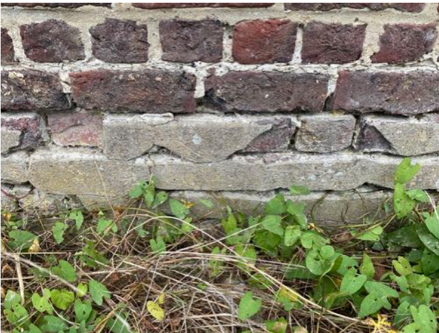
Afb. 41. — Detail scheuren en barsten in de gecementeerde plint
