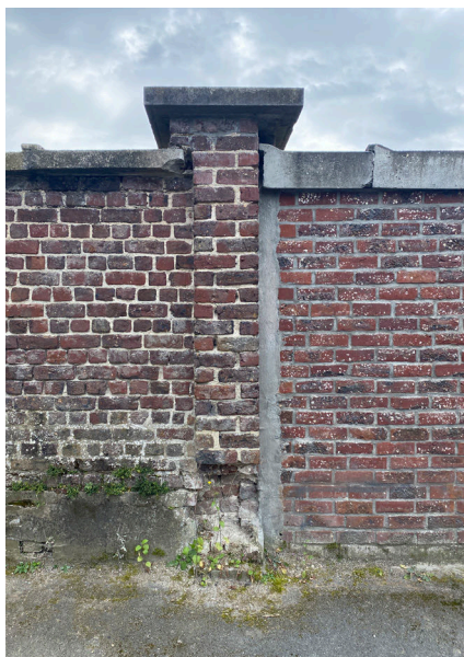
Afb. 111. – Recentere invulvoegwerk en gebarsten kolom
