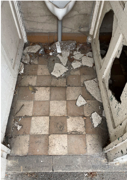
Afb. 80. – Deatil gebroken tegelvloer
