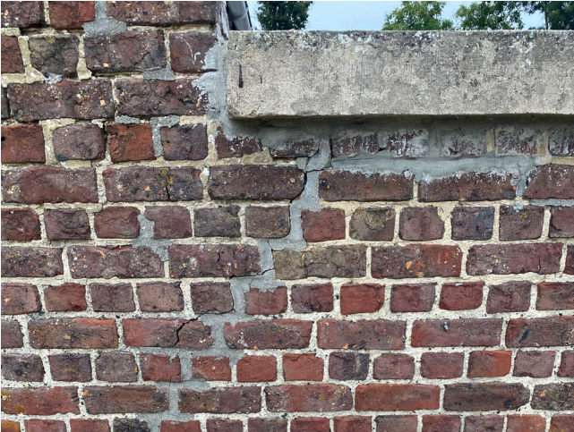
Afb. 39. — Detail van imperfecte steenvoegen die reeds vervangen werden door donkerder voegwerk / recenter voegwerk
