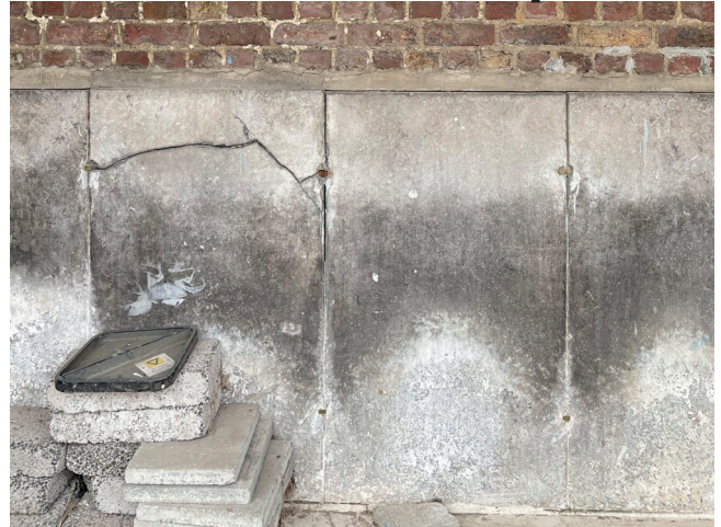
Afb. 89. – Detail gebarsten arduin en wandcementering van de pissijns
