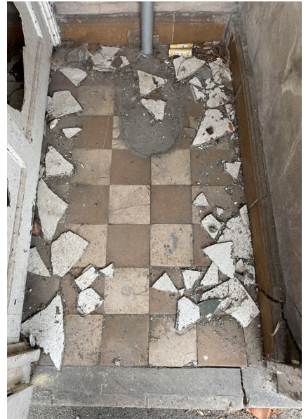
Afb. 82. – D0.23 - gebarsten tegelvloer en dorpels
