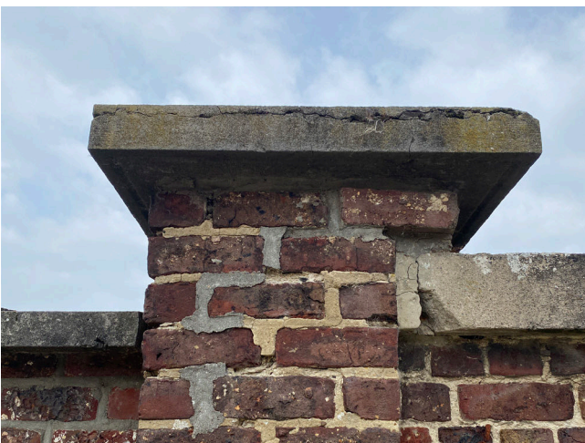
Afb. 37. — Detail metselwerk en verbrede kolommen staan niet 100% pas
