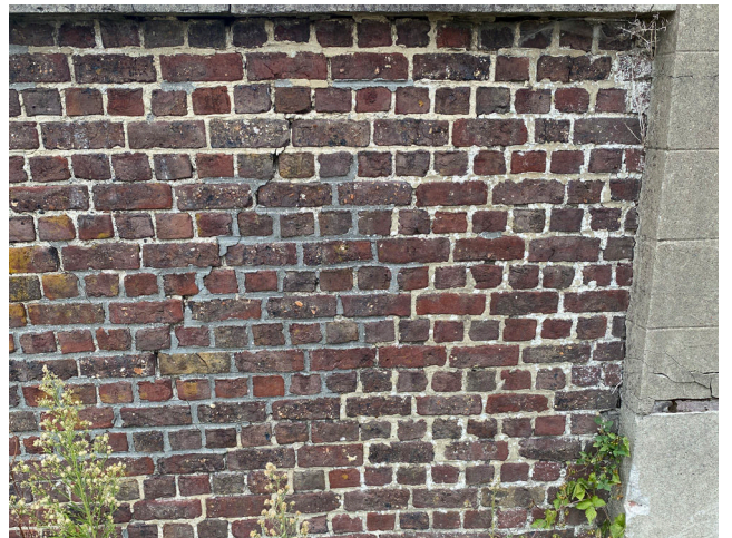
Afb. 36. — Detail van scheuren in bakstenen wand
