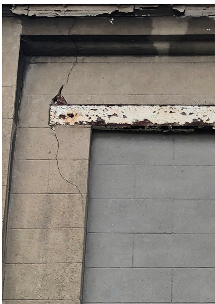
Afb. 27. — Verticale scheur aan ijzeren latei
