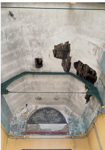
Afb. 127. – Beschadigd plafond werkklas
