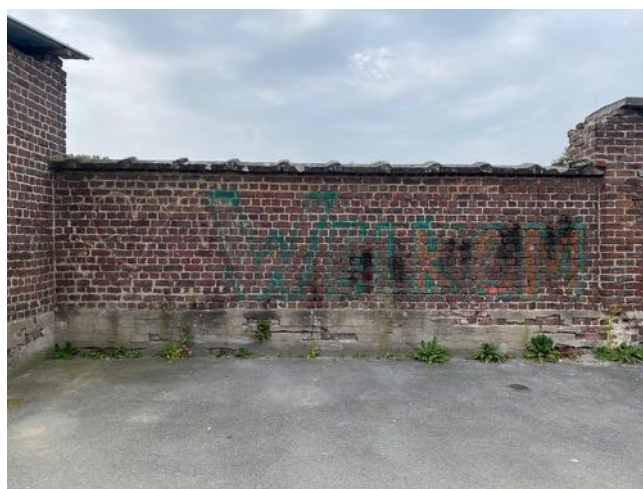
Afb. 115. – Graffiti op binnenzijde schoolmuur
