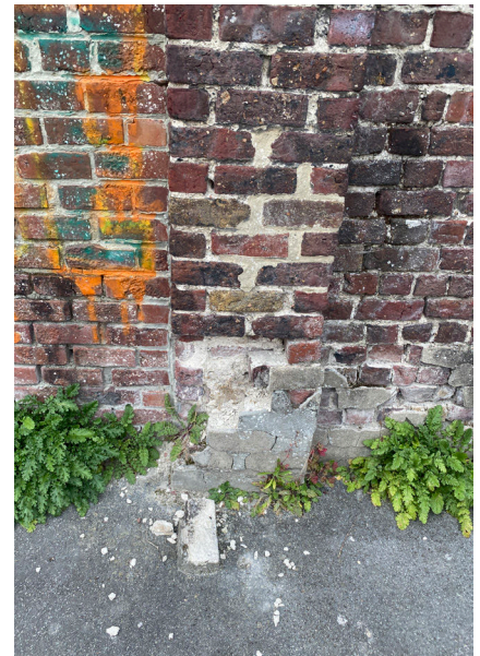
Afb. 120. – Afbrokkeling onderzijde kolom schoolmuur
