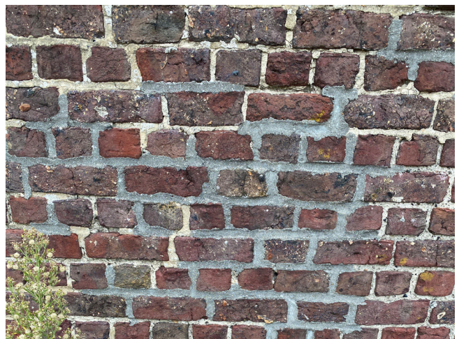
Afb. 38. — Detail van imperfecte steenvoegen die reeds vervangen werden door donkerder voegwerk / recenter voegwerk
