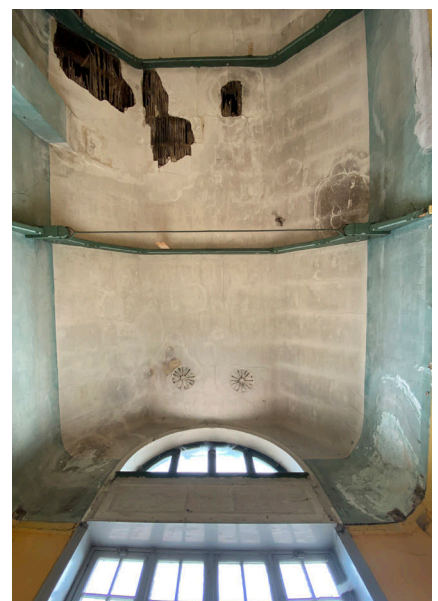
Afb. 129. – Beschadigd plafond werkklas
