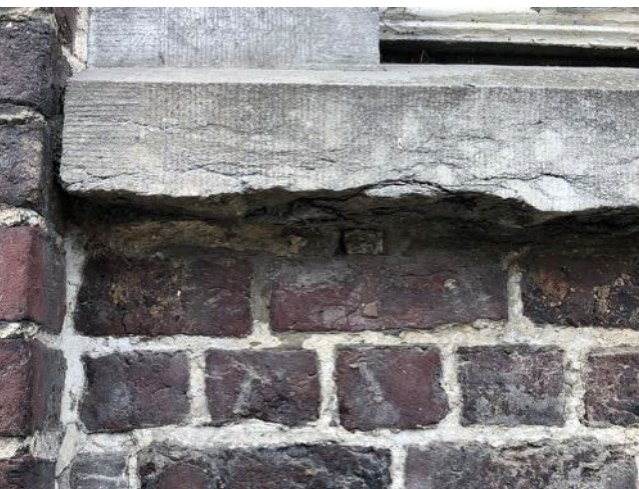
Afb. 17. – Detail beschadigde hardstenen dorpel
