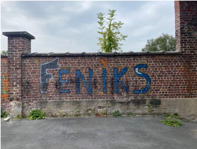
Afb. 116. – Graffiti op binnenzijde schoolmuur
