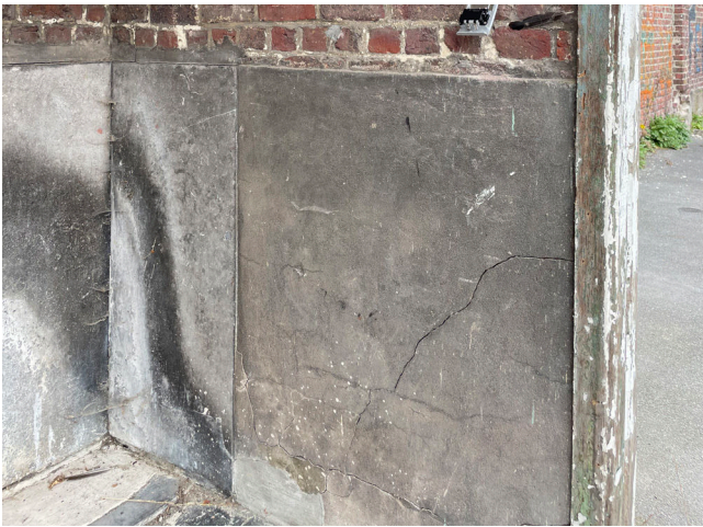
Afb. 90. – Detail gebarsten arduin en wandcementering van de pissijns
