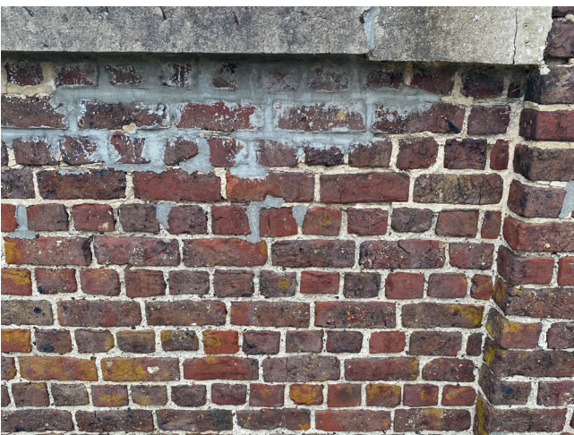
Afb. 43. — Detail van imperfecte steenvoegen die reeds vervangen werden door donkerder voegwerk / recenter voegwerk
