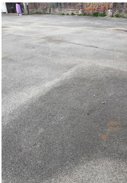
Afb. 70. – Asfaltlaag met barstvorming
