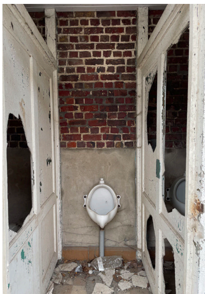
Afb. 77. — D0.22 - zichtbaar, gebroken asbestplaten
