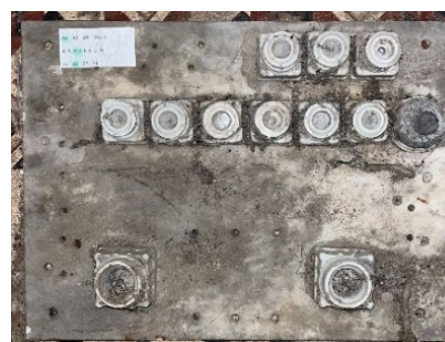
Deel van oude zekeringskast
