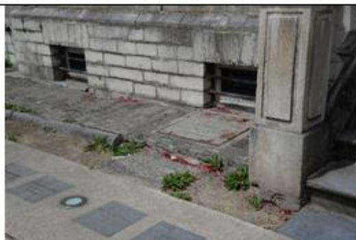
Zettingen ter hoogte van de kelderramen
