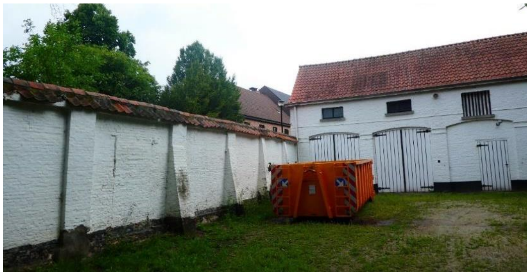
Figuur 3.2-75: Dichtgemetselde deuropening in de tuinmuur tussen twee steunberen. Ten westen van de deuropening P3 zijn de steunberen minder dik en recht dan ten oosten ervan. Mogelijk was de muur oorspronkelijk minder lang (Antea Group 2020).
