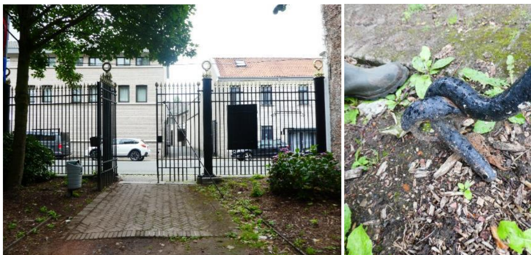
Figuur 3.2-62: Toegangspoort Kerkstraat. De grondpin voor het vastzetten van een deel van de poort is sterk verroest (Antea Group 2020).
