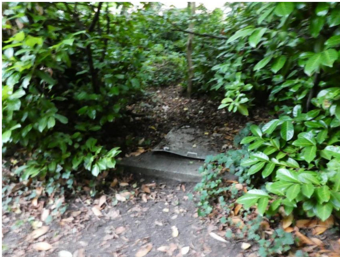
Figuur 3.2-80: Toezichtdeksel van de watermeterput tussen kasteel en Gentstraat. Het deksel sluit niet meer goed aan (Antea Group 2018).
