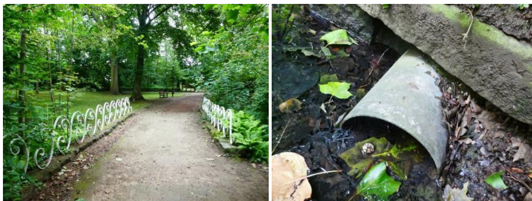
Figuur 3.2-90: Zicht op de 'brug' tussen beide kasteelvijvers. Eén van de duikers (P18) is mogelijk met asbest opgebouwd (Antea Group 2020).
