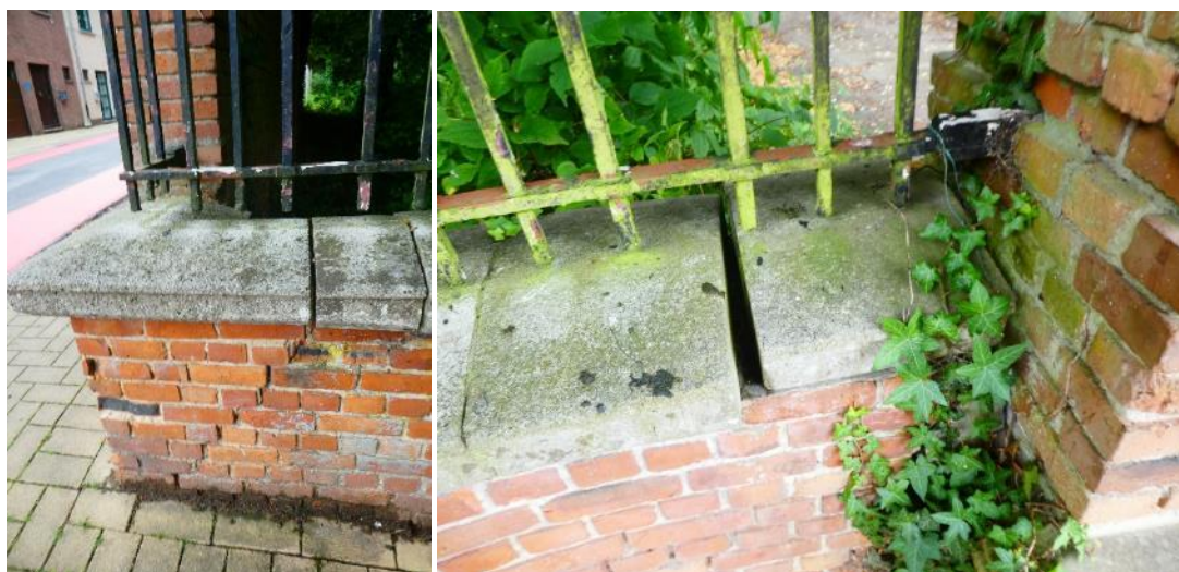
Figuur 3.2-73: (Links) barst in het voegwerk; (rechts) losse deksteen (Antea Group 2020).
