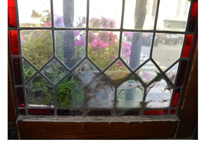
11. Beschadigd glas-in-lood voorgevel, 21 augustus 2019
