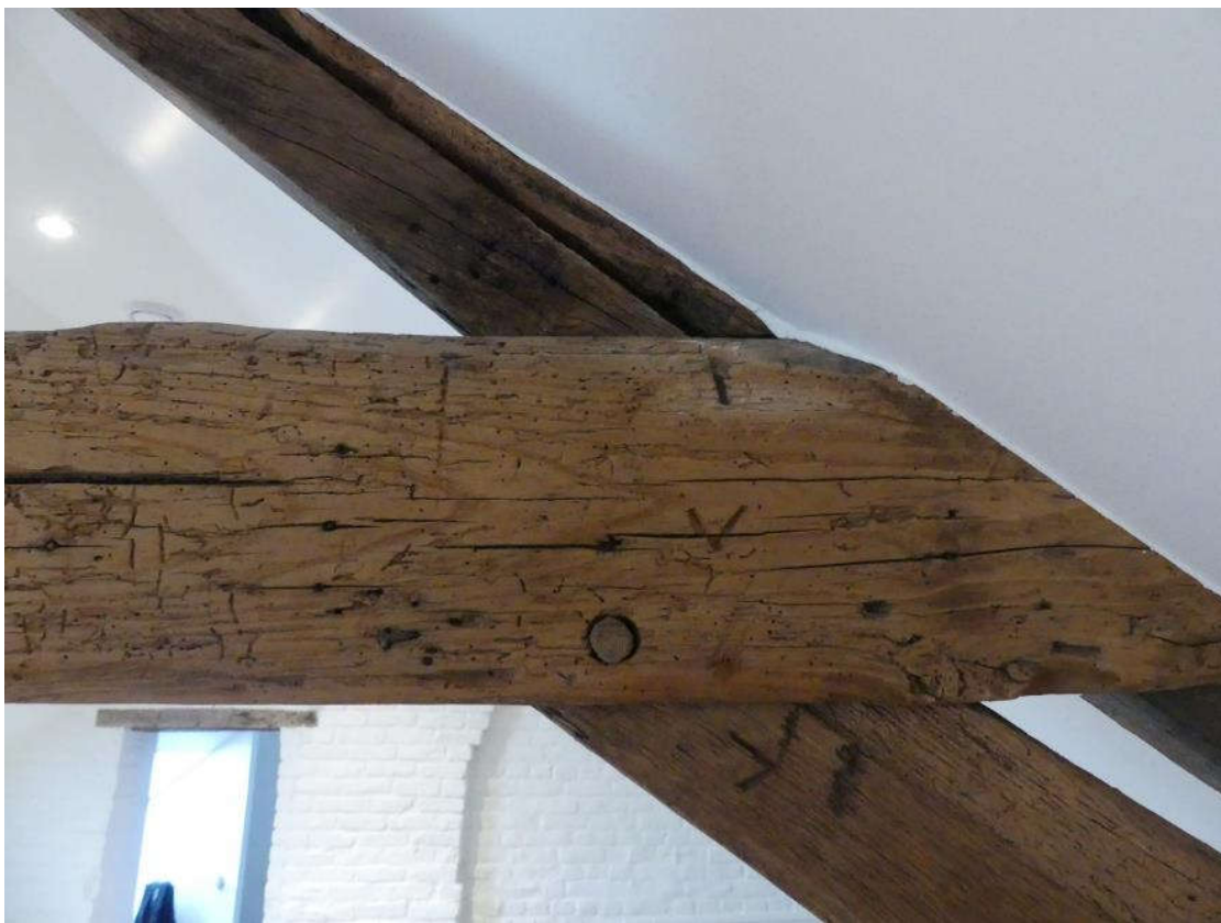
Foto 13 : pen- en gatverbinding spant zolder thv trekker en korbeel.
