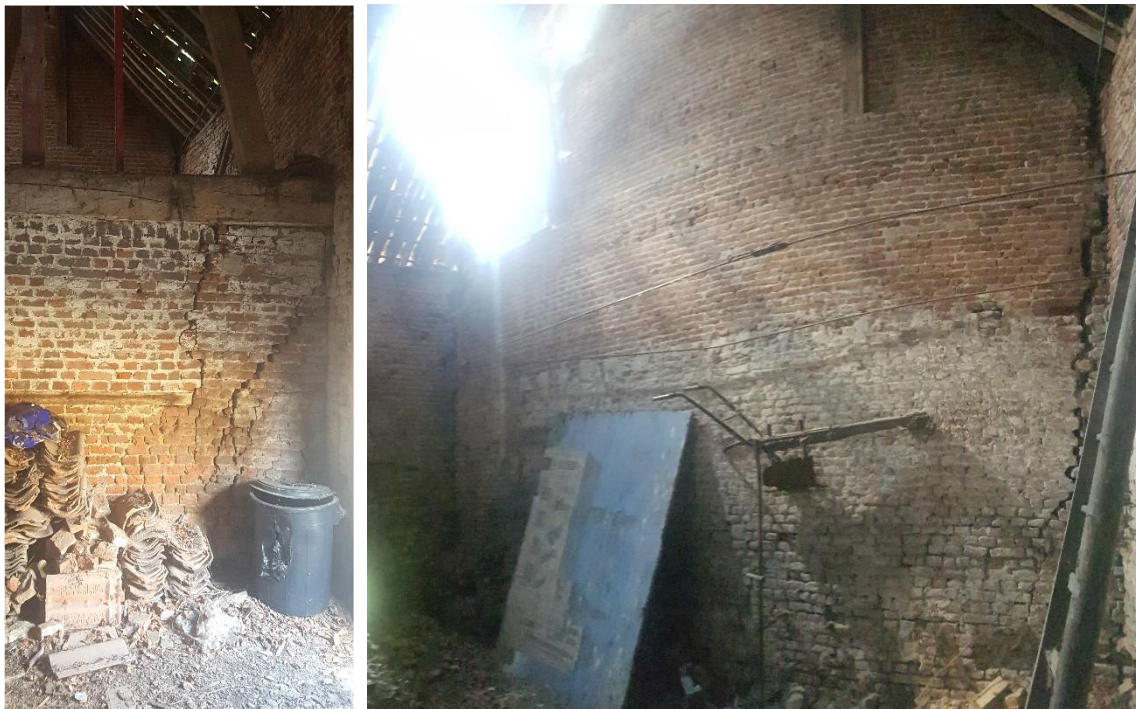
Fig. 73: Scheurvorming in alle scheidingswanden (links) en afscheuren van de kopse gevel (rechts).
