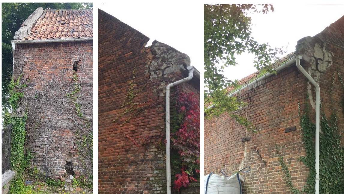
Fig. 69: Uitgevallen bakstenen door scheurvorming en beschadigde cementering (links), afgescheurd schouderstuk (midden) en schouderstuk met cementopvulling en ernstig uitgebuikte muur ter hoogte van de goot (rechts).
