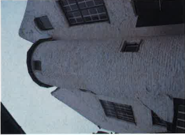
Huidige toestand achtergevel woning 31.
