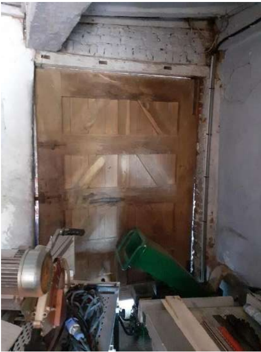
Afb. 96: Toegangsdeur molenhuis voorgevel.
