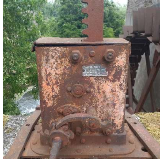
Afb. 125: Detail tandheugelsysteem voor bediening sluisdeuren.
