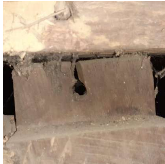
Afb. 91: Pen verzakte tussenstijl as 4 met gescheurd toognagelgat.
