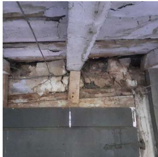
Afb. 76: Aantasting door vocht in wand tussen voor en achterkamer derde travee.
