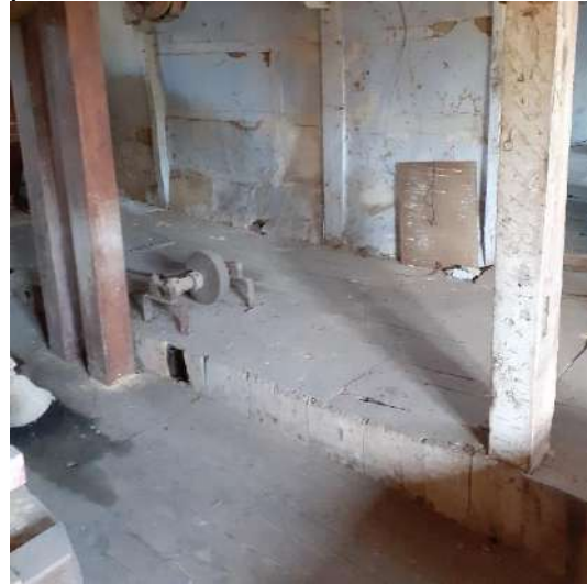
Afb. 109: Verschil hoogte vloer tussen travee 4 en 5.
