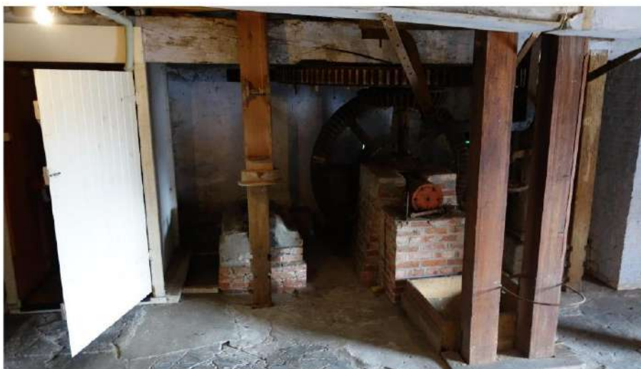
Afb. 8: Interne moleninstallatie gelijkvloers.
