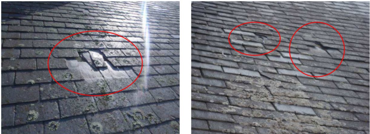
Figuur 42: Schadebeeld van de leienbedaking, Inspectie verslag Monumentenwacht 2015
