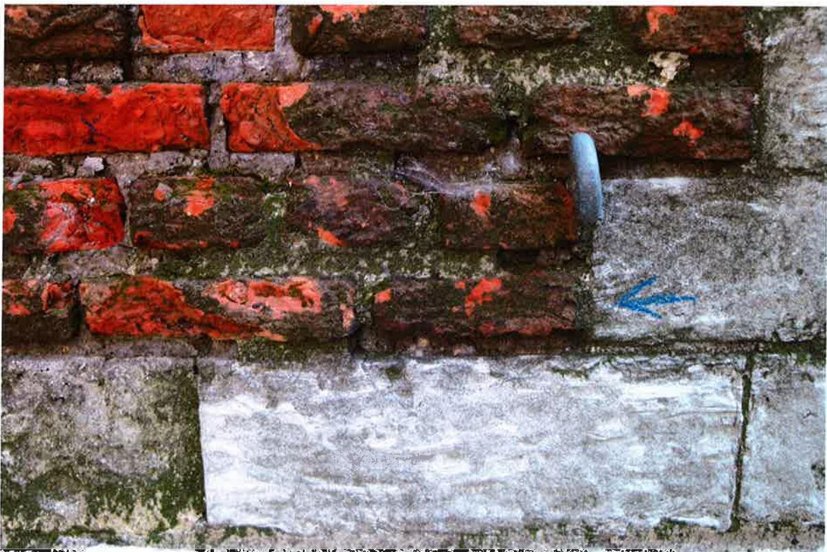
Illustratie: Typisch schadebeeld van afgebroken stukken baksteen door vorst.
