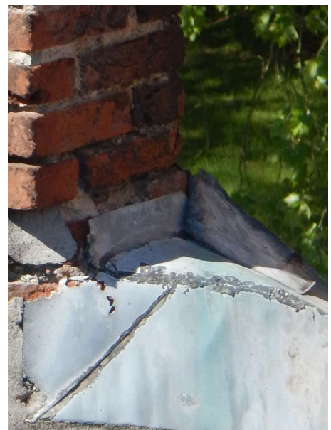
Topgevel [5]-zuidwest: de aansluiting van de zinken kap met het topstuk staat open
