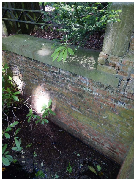
Beschadigd metselwerk onder boordsteen
