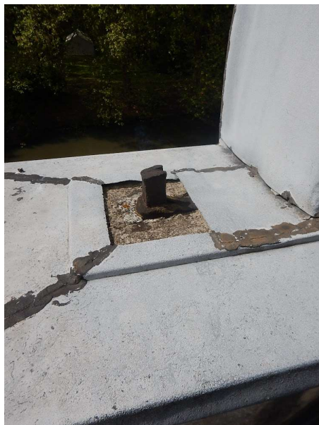
Topgevel [5]-zuidwest - zuidelijk schouderstuk: ontbrekende bekroning
