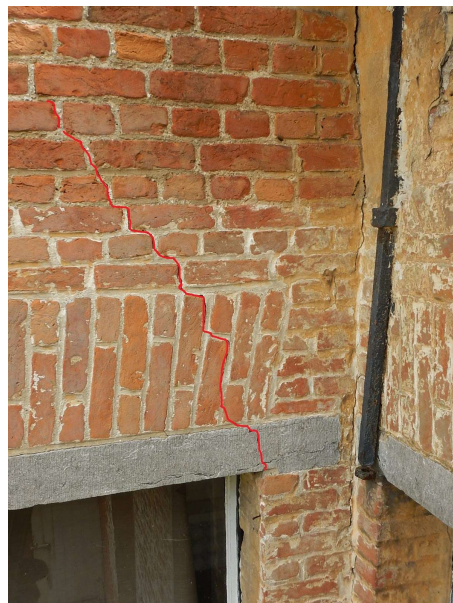
Vleugel [4]-zuidwest: diagonale scheurvorming, gebroken raamlatei
