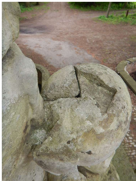
Oostelijke gebeeldhouwde 'wapenuitrusting': uitgespoeld voegwerk
