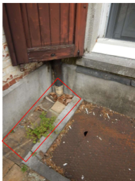
Beschadigde bestrating van de binnenplaats ter hoogte van de afvoer van daken [3]/[5]
