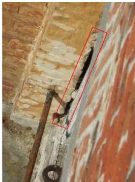
Vleugel [2]-noordoost: weggefallen aansluiting tussen het schrijn- en muurwerk
