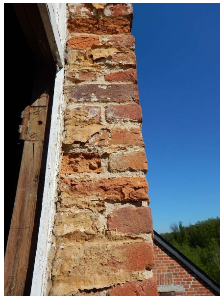
Vleugel [2] - noordoostelijke gevel uitbouw - dagkant: grotendeels verdwenen kaleilaag, verweerd en beschadigd baksteenmetselwerk
