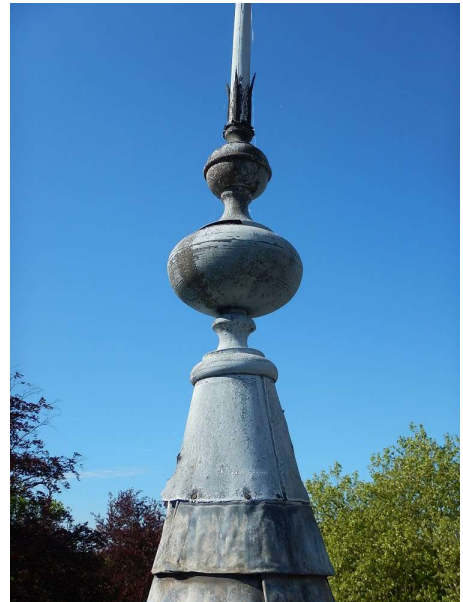
Toren [1]-zuidoostelijke hoektoren: sterk verweerde piron
