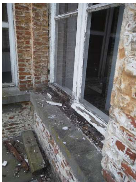
Vleugel [5]-noordwest: weggerotte waterlijst en dorpel
