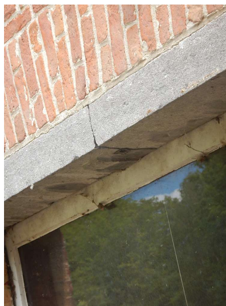
Vleugel [4]-zuidwest: gebroken raamlatei
