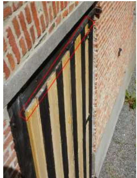
Oostelijke deur voorgevel vleugel [11]: het kopse hout kan bovenaan inrotten
