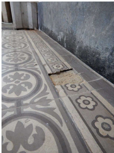
Vleugel [2]-zuidwest: beschadigde cementtegel
