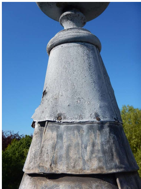
Toren [1]-zuidoostelijke hoektoren: gescheurde muts
