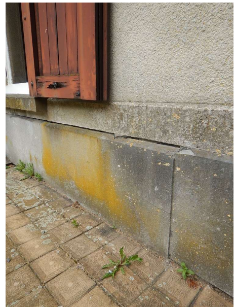
Vleugel [2]-zuidwest: plint komt los van het achterliggend muurwerk met vochtinsijpeling tot gevolg.
