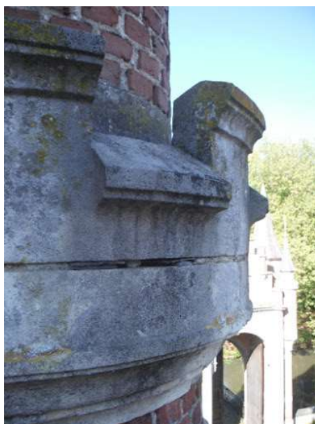
Toren [1]-noordwestelijke hoektoren: uitgespoeld voegwerk
