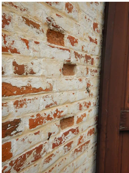
Vleugel [5]-oost: verweerde kaleilaag, verweringsgevoelige bakstenen
