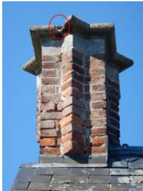
Zuidoostelijke schoorsteen: beschadigde deksteen
