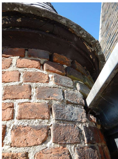
Toren [1]-zuidoostelijke hoektoren: uitgespoeld voegwerk
