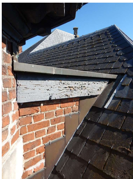
Zakgoot [1]/[2]: afbladderend schilderwerk boordplank
