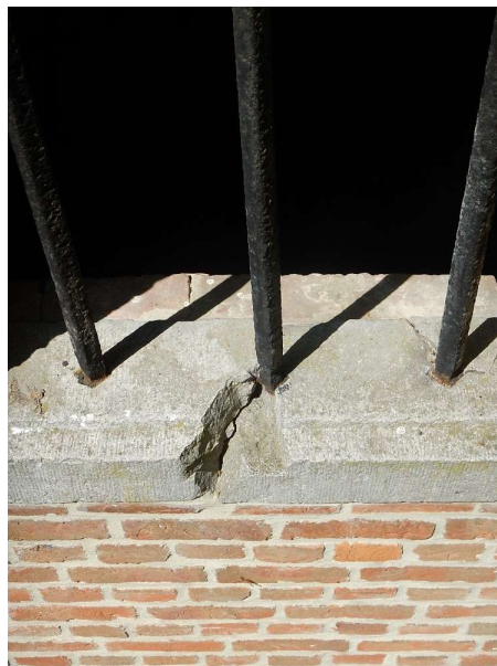
Vleugel [11]-oost: beschadigde raamdorpel
