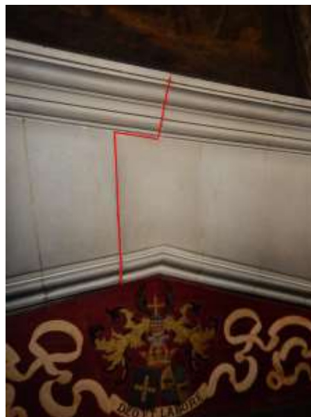
Vleugel [2]-noordoost: licht ingescheurde schoorsteenmantel
