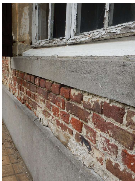
Vleugel [5]-zuidoost: verhoogde vochtbelasting onder gelijkliggende raamdorpel
