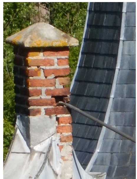
Topgevel [5]-zuidwest: roestige ankerstaaf
