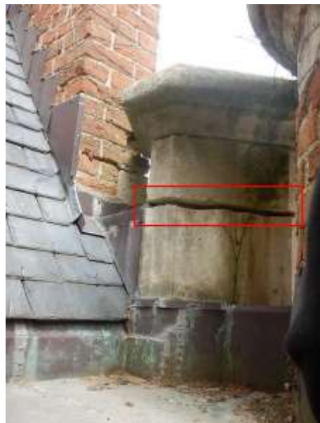
Vleugel [8]-noordoost - oostelijk topstuk kordonlijst: uitgespoeld voegwerk; opgedrukt door roestig ijzerwerk?
