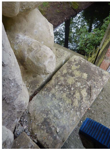
Oostelijke gebeeldhouwde 'wapenuitrusting': uitgespoeld voegwerk
