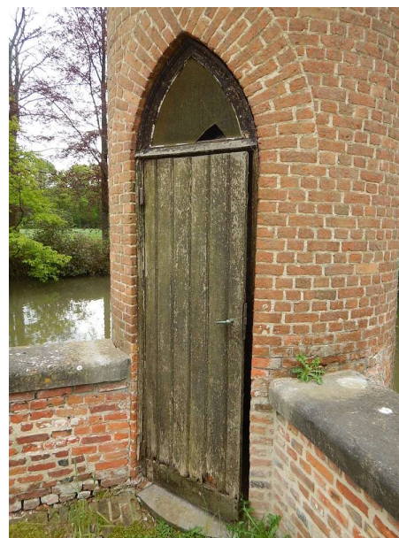
Toren [9]: sterke inrottingen onderaan de deur, gebroken bovenlicht
