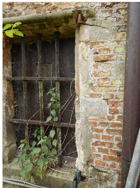
Vleugel [2]-oost: verweerde en beschadigde raamomlijsting
