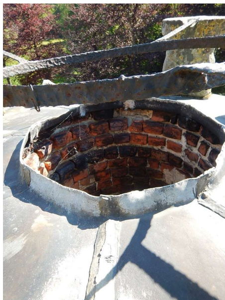
Uitspoeling van het inwendige voegwerk
