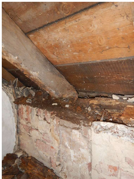
Dak [3]-oost: ingerotte muurplaat
