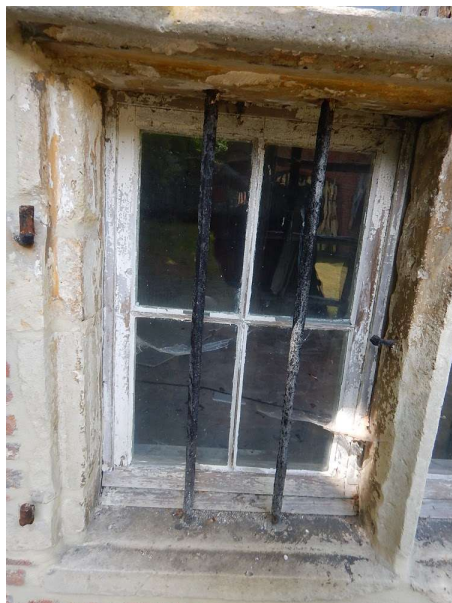
Vleugel [11]-zuidoost: verweerd schilderwerk en ontbrekende stopverf
