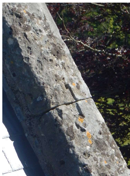
Uitgespoelde stootvoeg en verdwenen kram
