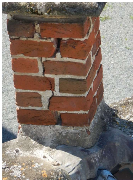
Dakkapel [5]-oost: ingescheurde topstuk
