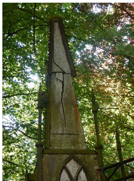
Beschadigde natuurstenen pinakel
