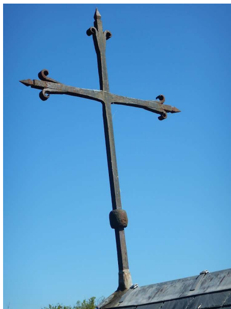
Roestig kruis dak [4]
