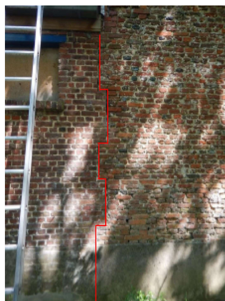
Scheurvorming in aansluiting met de westelijke vleugel
