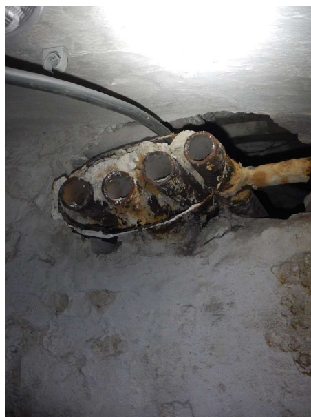
Beschadigde isolatiemantel in een kelder van het kasteelgebouw
