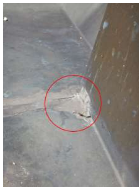
Goot [5]-zuid: gescheurde soldeernaad gootbodem ter hoogte van dakkapel
