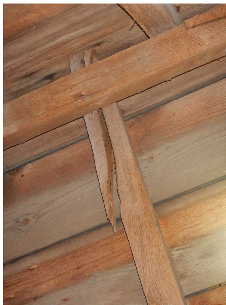
Dak [2]: beschadigde keper t.h.v. nokbalk
