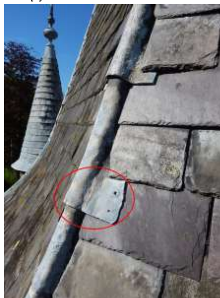
Toren [1]-oost: uitgezakt hoekkeperlood
