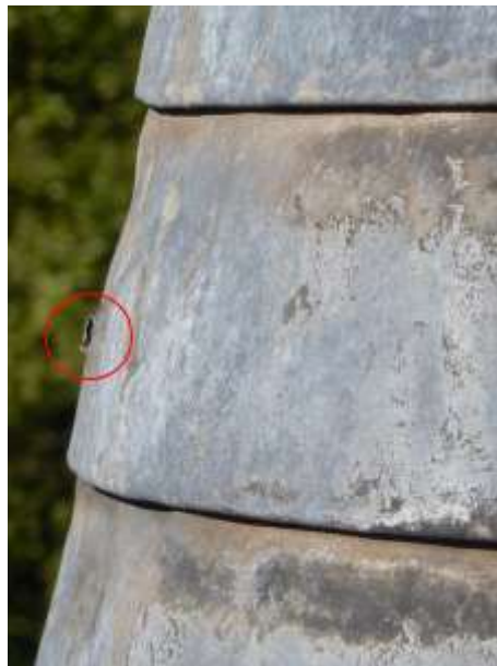
Zuidoostelijke hoektoren: perforatie
