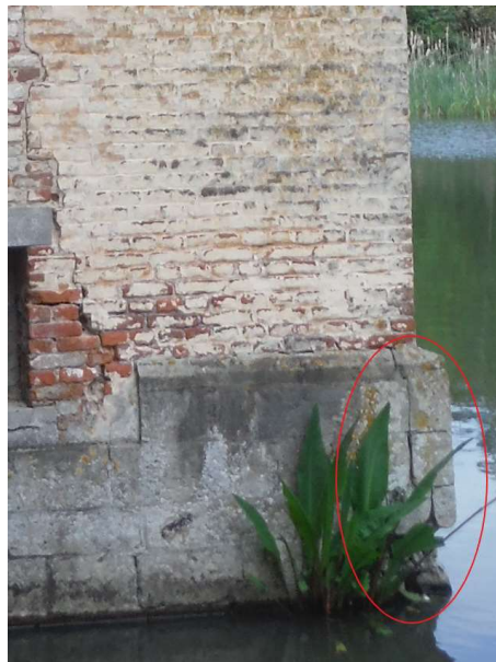
Vleugel [3]-oost: beschadigde plint
