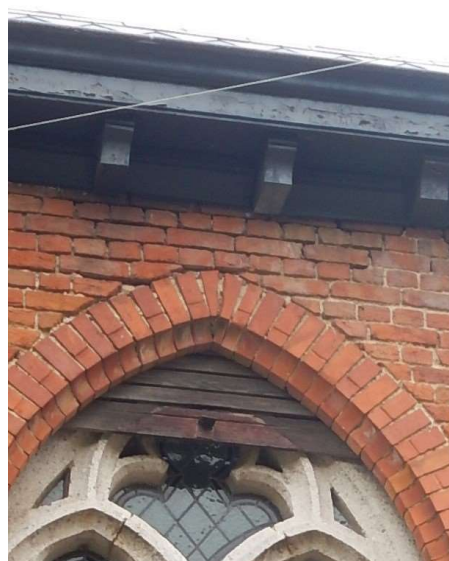
Vleugel [4]-zuidwest: uitgespoeld voegwerk onder de kroonlijst ten gevolge van (oude) lekken in de goot
