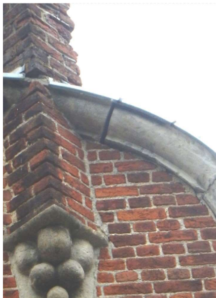
Topgevel [5]-zuidwest: uitgespoelde stootvoeg
