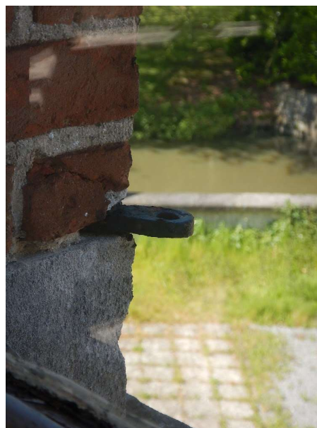
Vleugel [5]: beschadigde steen t.g.v. roestig oog van luik
