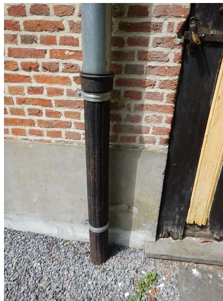
Vleugel [11]: roestige standpijp
