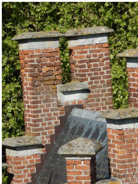
Topgevel [8]-zuidwest: uitgespoeld voegwerk topstukken
