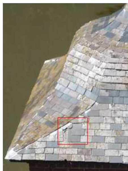
Dak [7]: beschadigde en weggevallen leien
