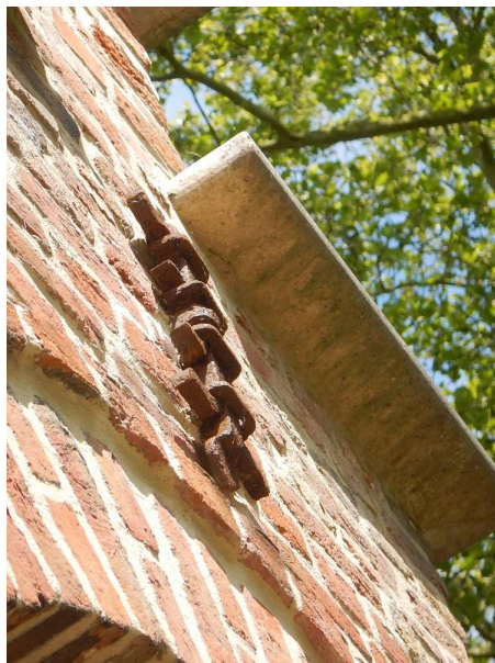
Vleugel [11]: roestig muuranker oostelijke dakkapel
