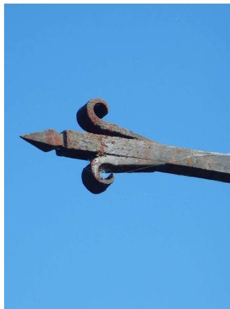
Roestig kruis dak [4]
