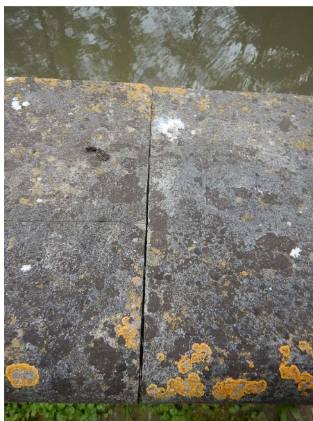
Zuidoostzijde: uitgespoelde stootvoeg
