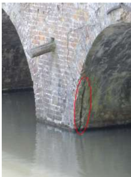
Noordwestzijde: delaminatie buitenste schil metselwerk
