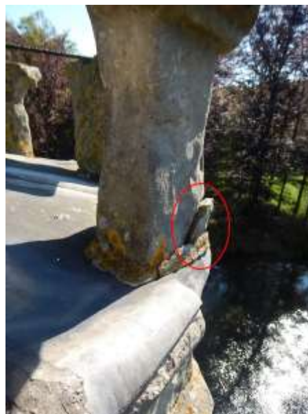
Steenschade onderaan een kanteel t.g.v. roestige verankering
