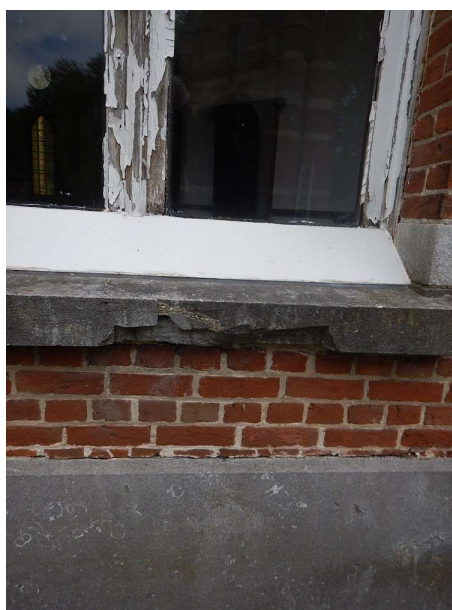
Toren [1]-west: beschadigde raamdorpel
