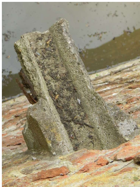
Zuidwestzijde, ten westen van poortgebouw [8]: beschadigde spuer
