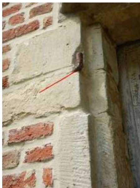
Vleugel [11]-zuid: beschadigde raamomlijsting
