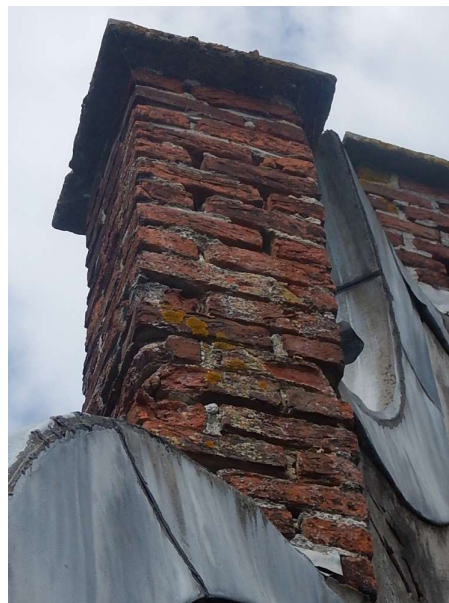
Topgevel [5]-zuidwest - zuidelijk topstuk: sterk uitgespoeld voegwerk, bakstenen beschadigd door vorst
