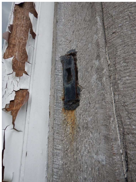
Vleugel [3]-zuid: roestig ijzeren deel in de hardstenen deuromlijsting
