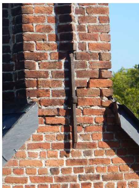
Vleugel [3]-zuidoost: scheurvorming/opgedrukt metselwerk schoorsteen door roestig muuranker
