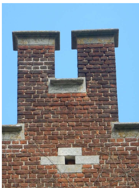
Topgevel [8]-zuidwest: uitgespoeld voegwerk topstukken
