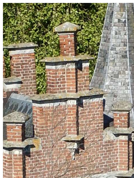
Topgevel [8]-noordoost: uitgespoeld voegwerk topstukken
