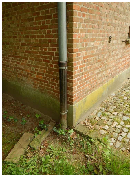
Vleugel [12]: roestige standpijp
