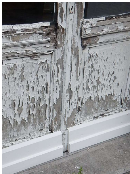
Toren [1]-zuidwest - deur gelijkvloer: sterk ingerot houtwerk. Onderaan is vocht- indringing mogelijk
