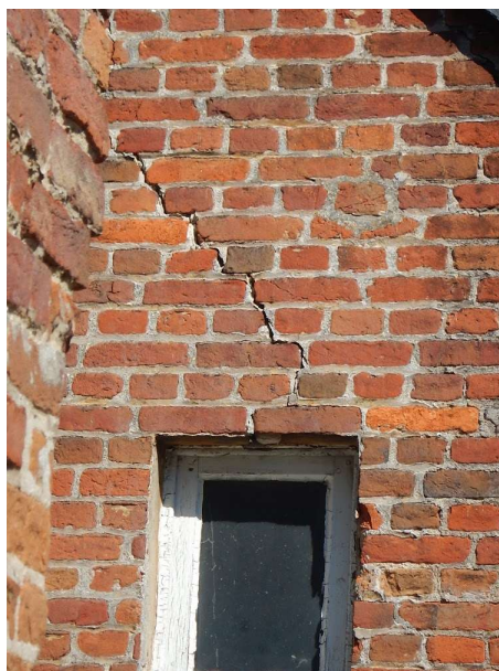
Vleugel [3]-zuidoost: scheurvorming
