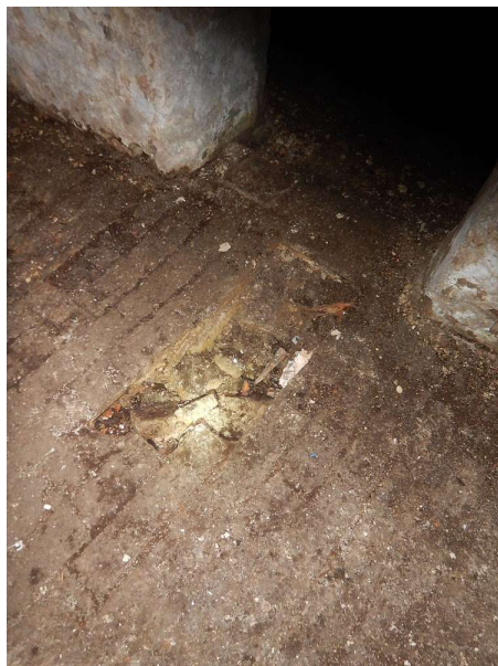
Verzakte vloer in een kelder onder vleugel [2]
