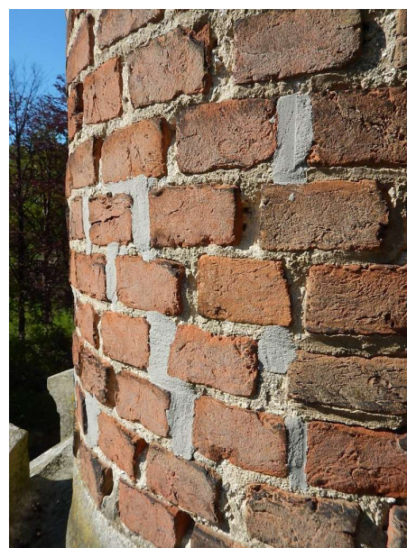
Toren [1]-zuidoostelijke hoektoren: cementrijke voegmortel vriest los
