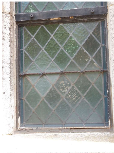
Roestige bindroede (raamvleugel) en roestige raambrug
