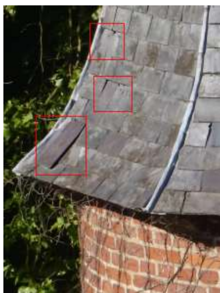
Toren [9]: uitgezakte en weggevallen leien
