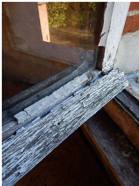
Toren [1]-oost. De waterlijst hangt los
