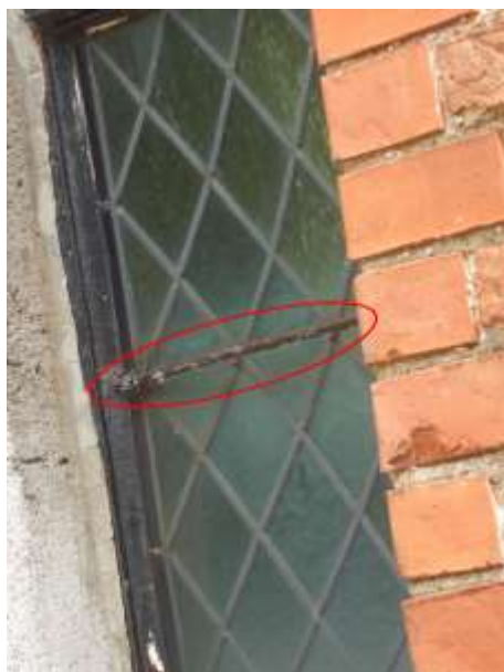
Ontbrekende bindloodjes (raamvleugel)
