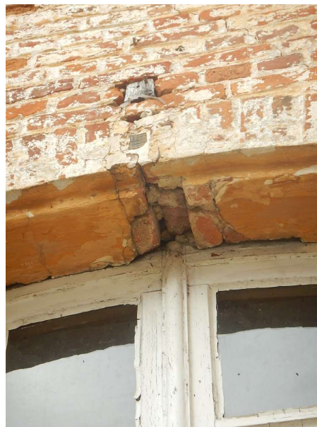
Vleugel [5]-oost: beschadigde deurlatei
