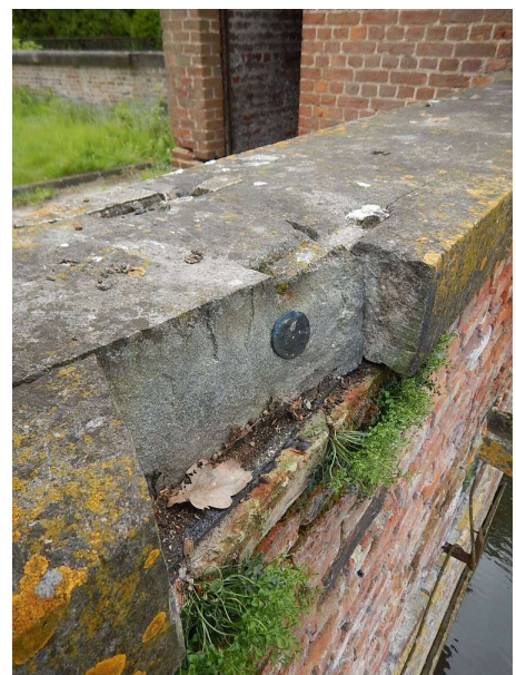
Noordwestzijde: na verwijdering loszittend deel deksteen, herstelling met siliconen (!)
