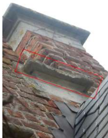
Topgevel [8]-zuidwest: beschadigde druiprand van deksteen
