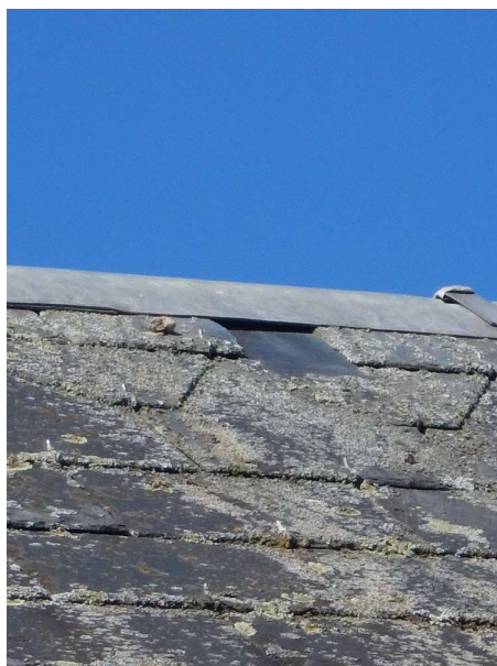
Dak [3]-noordoost - weggevallen lei
