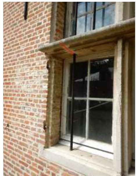
Vleugel [11]-zuid: beschadigde tussendorpel
