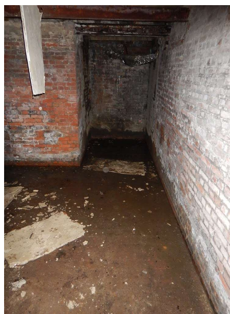
Wateroverlast in een kelder van vleugel [3]-zuidwest
