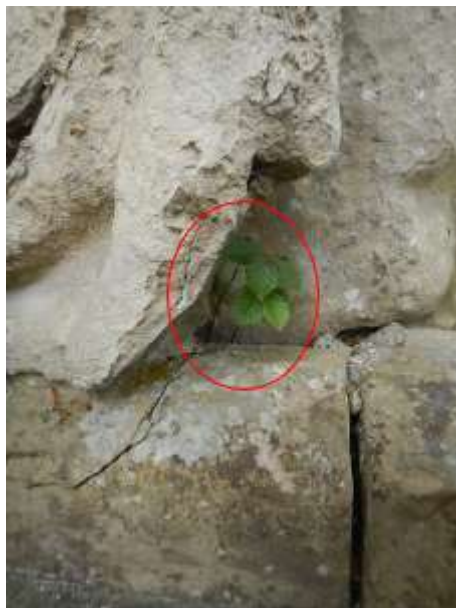
Oostelijke gebeeldhouwde 'wapenuitrusting': beuk in uitgespoeld voegwerk, gebroken natuursteen
