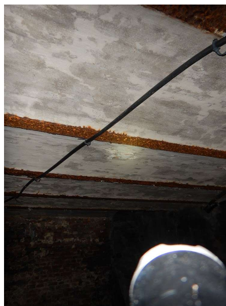
Kelder ten westen van vleugels [4] en [5]: roestige profielen troggewelven
