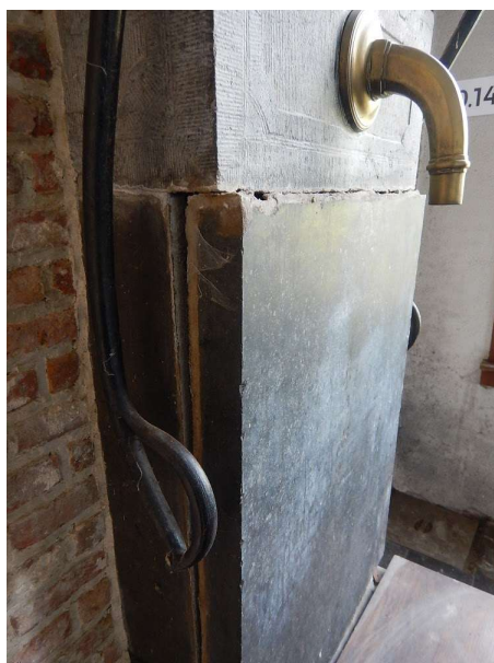
Vleugel [4]-noordwest: hardstenen plaat van hand-pomp komt los
