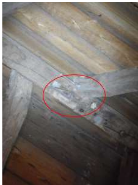
Dak [5]: verzwakking nokbalk
