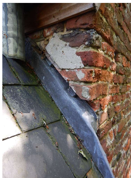
Muuraansluiting niet opgevoegd
