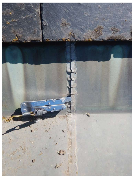
Goot [4]-zuidwest: gescheurde soldeernaad binnenopstand
