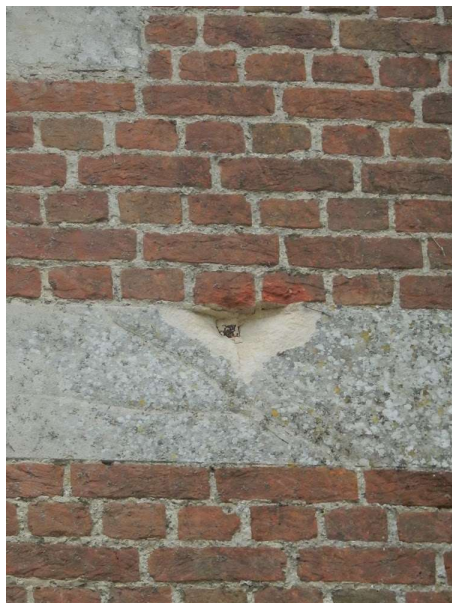
Poortgebouw [8]: beschadigde speklaag
