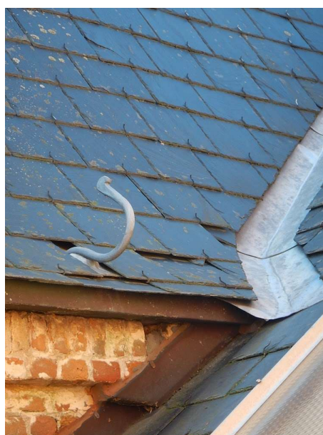
Dak [2] - weggevalen leien boven monding noordelijke kilgoot van de noordoostelijke uitbouw
