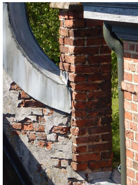
Topgevel [5]-zuidwest: verweerde en beschadigde cementbepleistering en metselwerk
