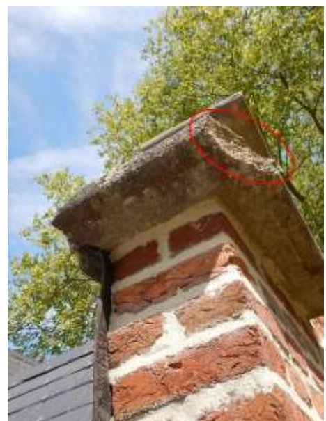
Vleugel [11]-oost: beschadigde deksteen
