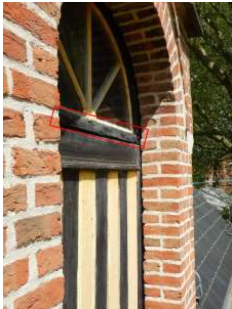
Oostelijke dakkapel vleugel [11]: weggefallen waterlijst
