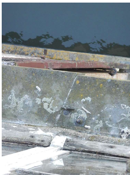
Vleugel [3]-noordwest: gebroken raamdorpel
