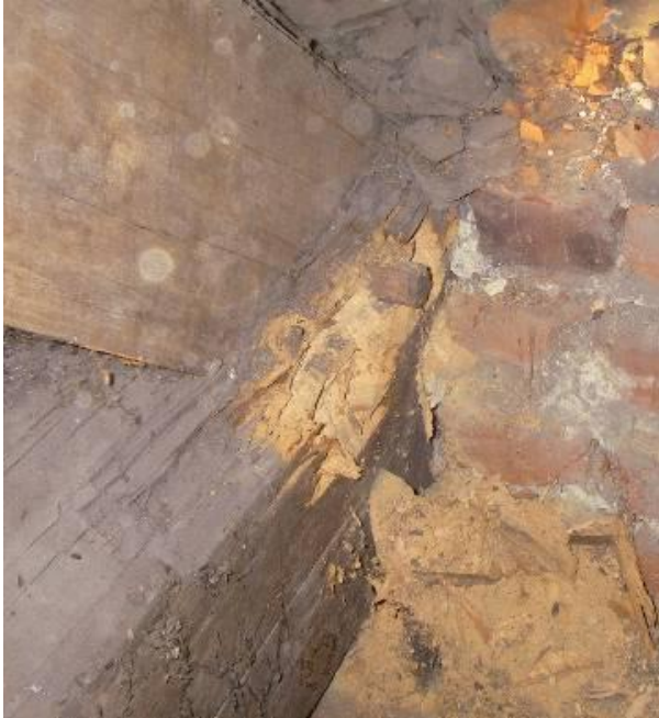
Fig. 126: 2 de spant, te tellen vanaf oost: zuidelijke oplegging; ernstig aangetaste pen- en gatverbinding (MW)
