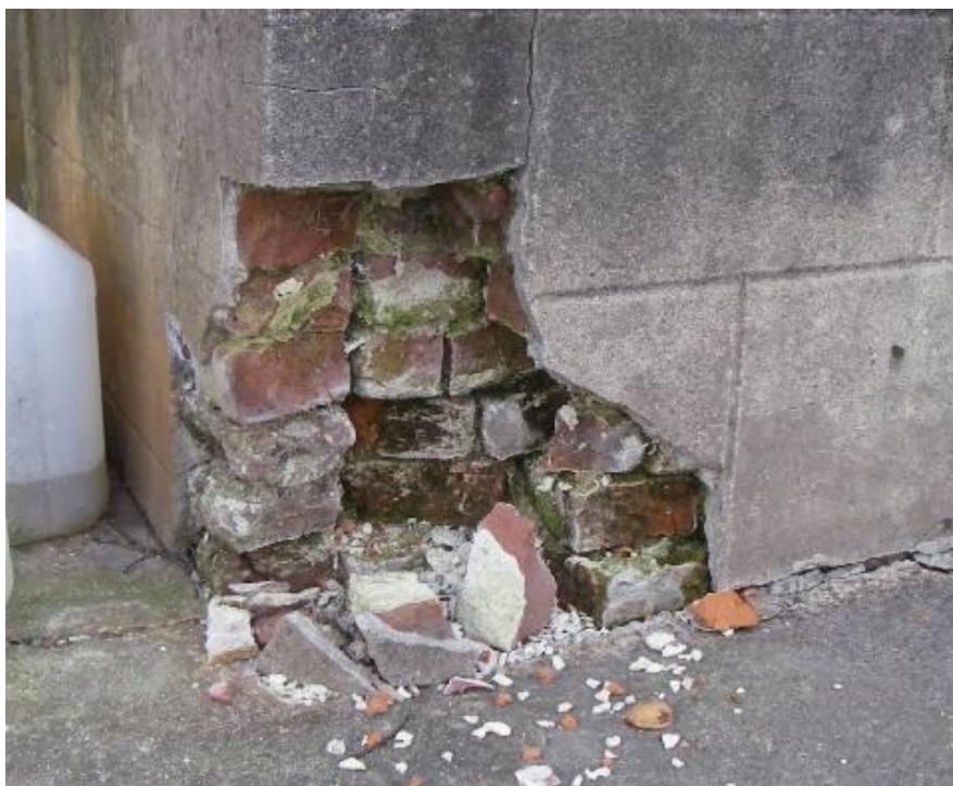
Fig. 134: Schade aan de bepleisterde plint (MW)
