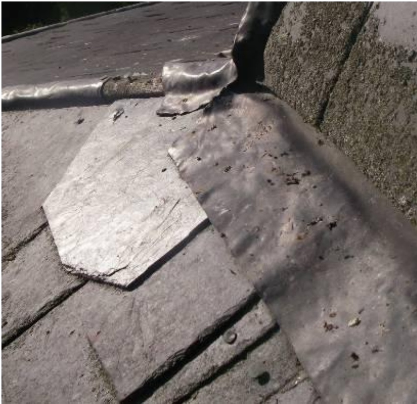
Fig. 118: zuidoostelijke hoekkeper: ontbrekende loodslab (MW)
