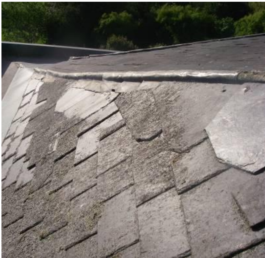
Fig. 117: zuidoostelijke hoekkeper: ontbrekende leien (MW)
