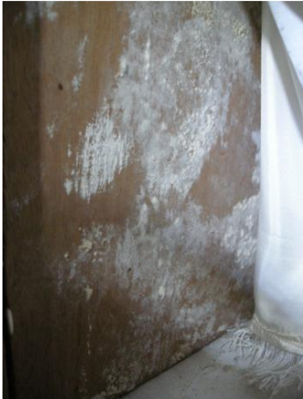
Fig. 173: Schimmels aan de binnenzijde van het tabernakel (MW)
