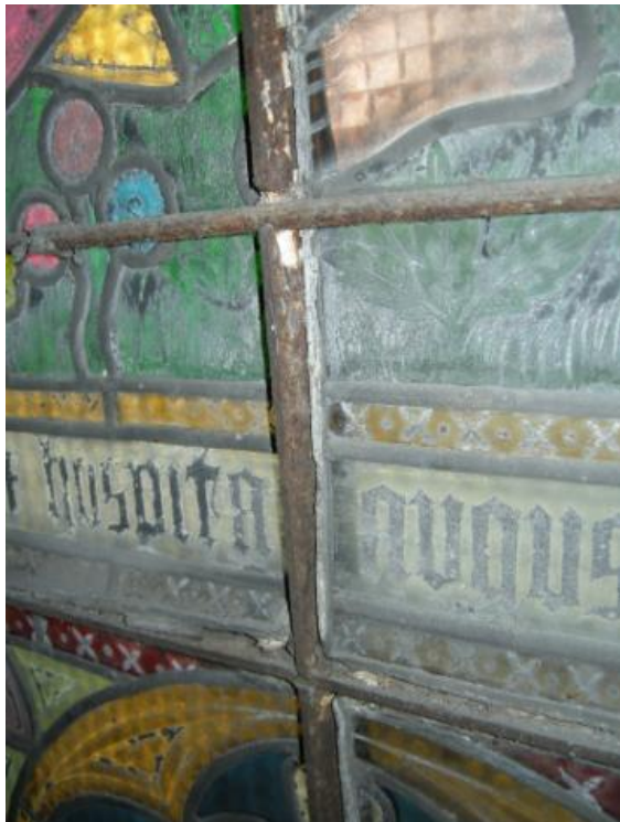
Fig. 145: de metalen onderdelen zijn roestig (MW)
