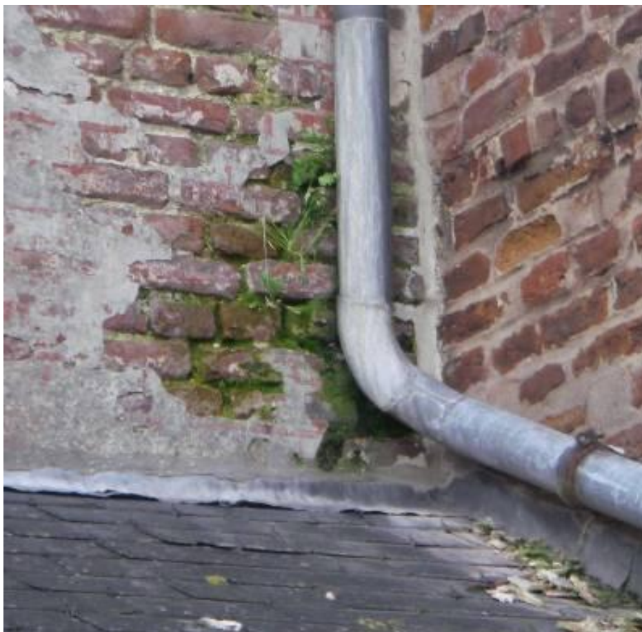
Fig. 130: De zinken afvoer, bevestigd op de westelijke gevel van de noordelijke zijbeuk, is verweerd en lekt. Hierdoor is het muurwerk op de westelijke gevel nat en begroeid met planten en algen (MW)
