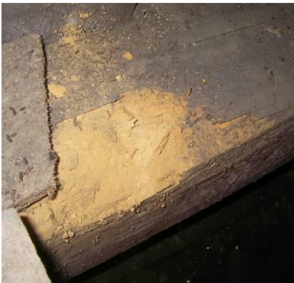
Fig. 127: aantasting centraal in de trekbalke (MW)
