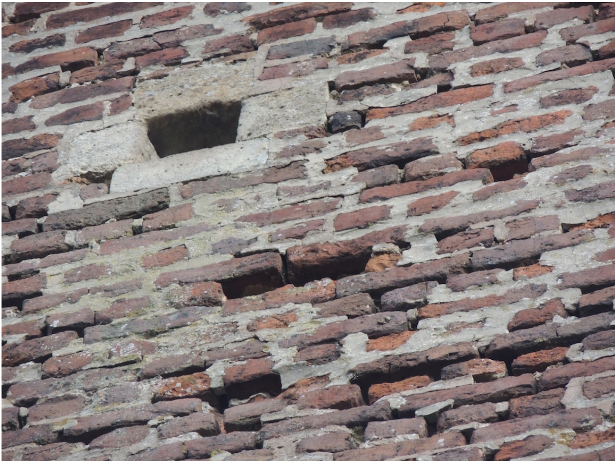
Fig. 132: schade aan metselwerk en voegwerk - Detail westgevel toren (GG)
