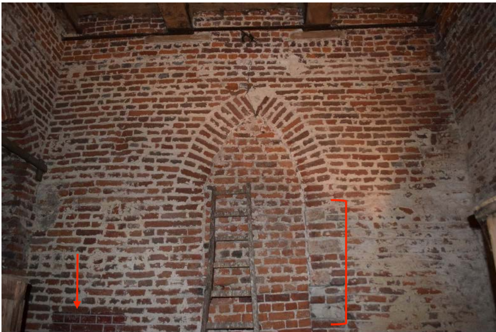
Fig. 14: Spitsboogvenster in de zuidelijke torenwand met vier bewaarde, witstenen negblokken; links ervan het testvlak baksteenimitatieschildering, sporen van vroegere balkenlaag
