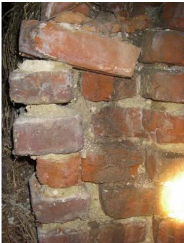
Fig. 157: Loszittende bakstenen bovenaan (MW)
