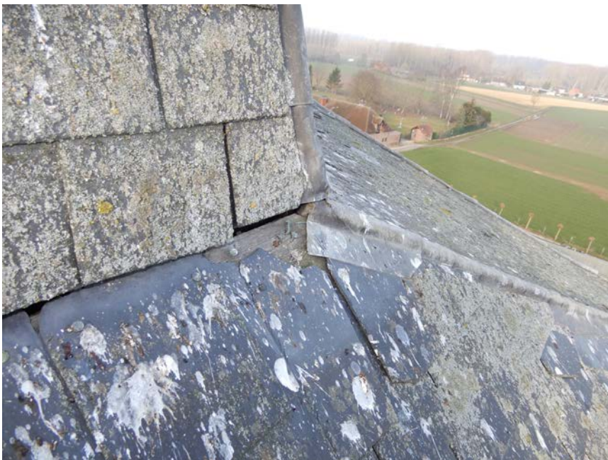
Fig. 119: loodslab is verdwenen ter hoogte van de insnoering
