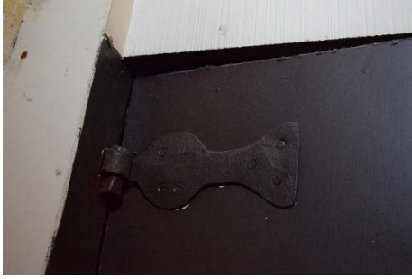
Fig. 7: Detail van het duimhengsel van de opgeklampte deur
