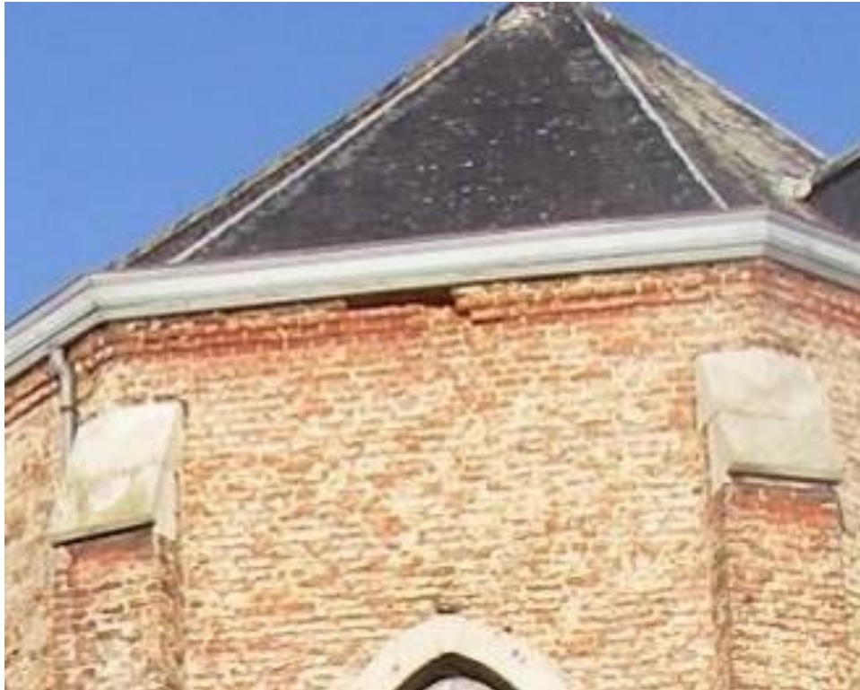
Fig. 135: Bovenaan de zuidoostelijke gevel van het koor is het baksteenmetselwerk plaatselijk uitgevallen (MW)
