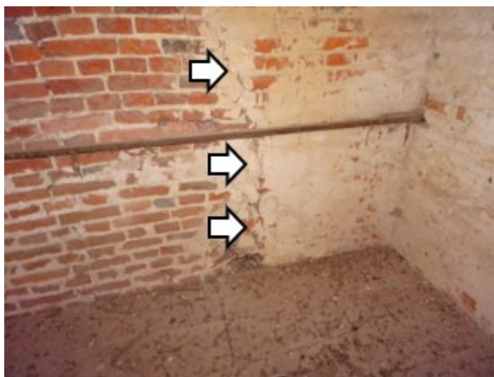
Fig. 5 Scheurvorming rechts onder (blinde) raamopening zuidgevel toren niv. +2
