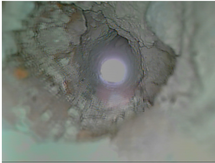
Fig. 20 Endoscopie E2_35 cm - holte in baksteenmetselwerk (overgang tussen oorspronkelijk parement en invulmetselwerk blindraam?)
