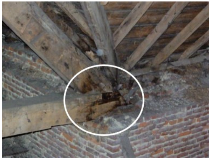
Fig. 11 Zichtbaar aangetaste balkkop t.g.v. (vroegere?) waterinsijpelingen
