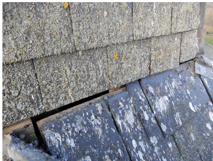
Fig. 3 Loden slabben t.h.v. insnoering torenspits afgevallen, waterinfiltraties mogelijk
