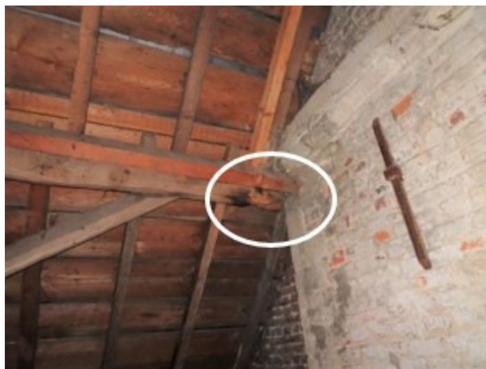
Fig. 8 Aangetaste balkkop gording zuidgevel (schip), ‘hersteld’ door nieuwe bovenliggende balk
