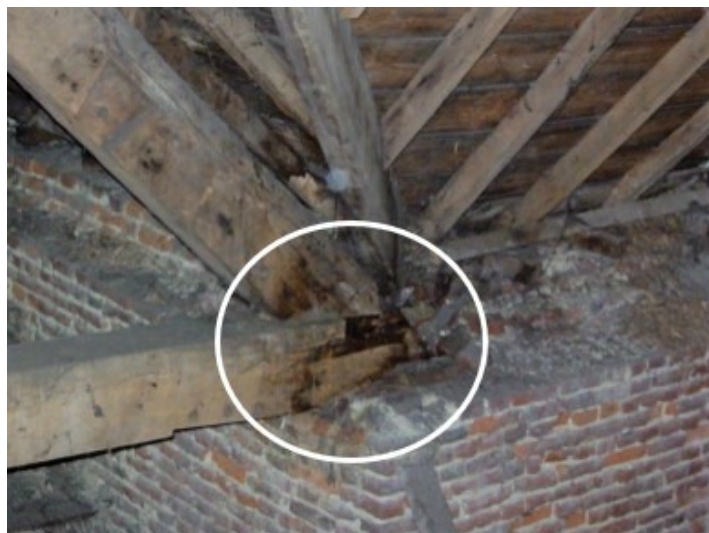
Fig. 11 Zichtbaar aangetaste balkkop t.g.v. (vroegere?) waterinsijpelingen
