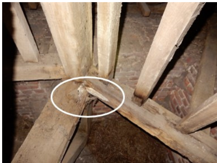
Fig. 2 Schimmelaantasting t.h.v. aansluiting moerbalk met raveelbalk aan zuidwest hoek
