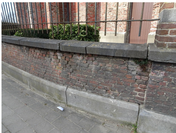
Fig. 16 Degradatie van metsel- en voegwerk t.g.v. waterinspijlingen en vorst-dooi-cycli
