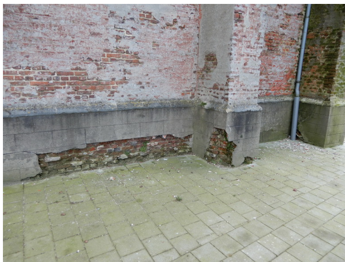
Fig. 13 Sterke degradatie van het metselwerk t.g.v. vorst onderaan de gevel
