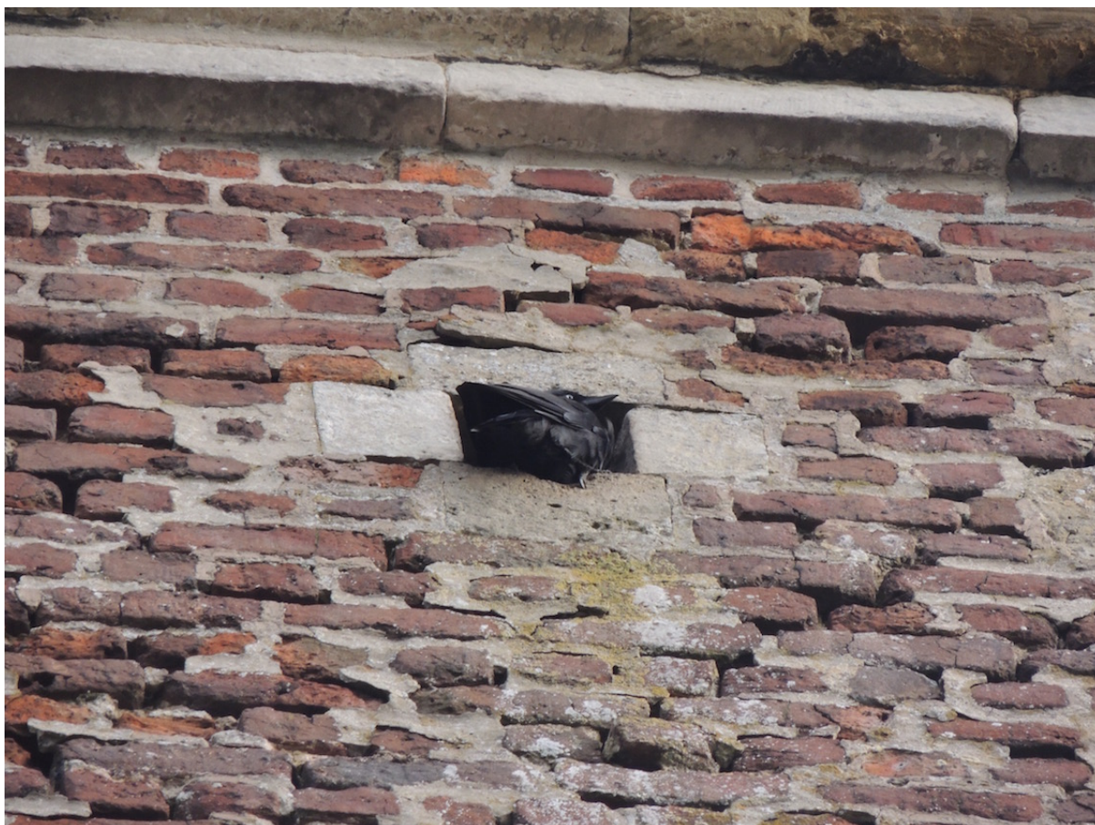
Fig. 6: Kauwen nestelen in de stellinggaten. Deze detailfoto van de westgevel van de toren illustreert tevens de sterke aantasting van het voegwerk.
