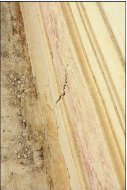
FIGUUR 125: SCHEURVORMING EN VERZAKING IN DE BUTENLIJSTEN. DEZE NIVEAUVerschillen zijn niet steeds te verhelpen.
