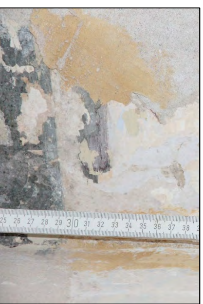
FIGUUR 140: ER ZIJN VERSCHILLENDE LAGE ZWARTE PLINTEN AANWEZIG.
