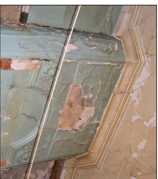
FIGUUR 34: TOESTAND VAN DE AANSLUITING VAN DE SCHOUW MET HET PLAFOND VOOR AFNAME VAN DE ORNAMEENTEN, FOTO GISELE GANTOIS, 2010.
