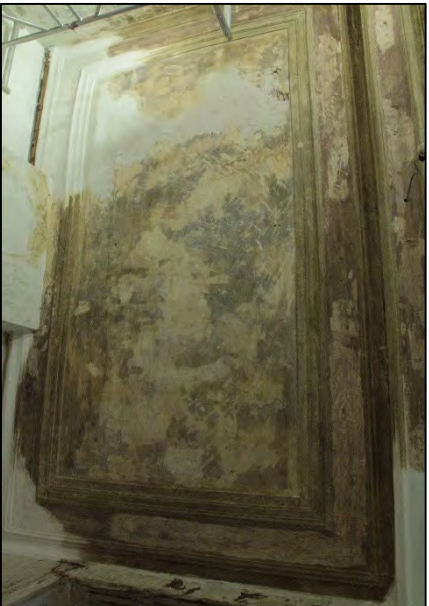
FIGUUR 88: ZUIDELIJK PLAFONDVLAAK NA VRIJLEGGING EN HERSTEL VAN HET LUSTWERK. DE HARDE KRASSEN VAN HET DECAPEREN IN HET VERLEDEN ZIJN VOORAL OP DIT PLAFONDVELD GOED ZICHTBAAR.
