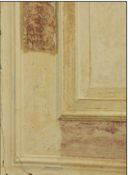
FIGUUR 115: DEEL VAN HET PLAFOND TIJDENS VRIJLEGGING MET BEHUP VAN WARM WATER. DE RODE PIJL DUIDT OP DE ONDERSTE LIMVERF DIE DOOR HET WATER DONKER BEIGE VERKLEURDE.
