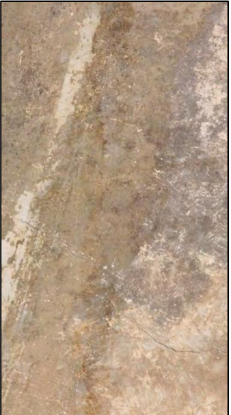
FIGUUR 89: DETAIL MET VOCHTKRINGEN/SPATTEN VAN DE ONBEKENDE BRUINE SUBSTANTIE.
