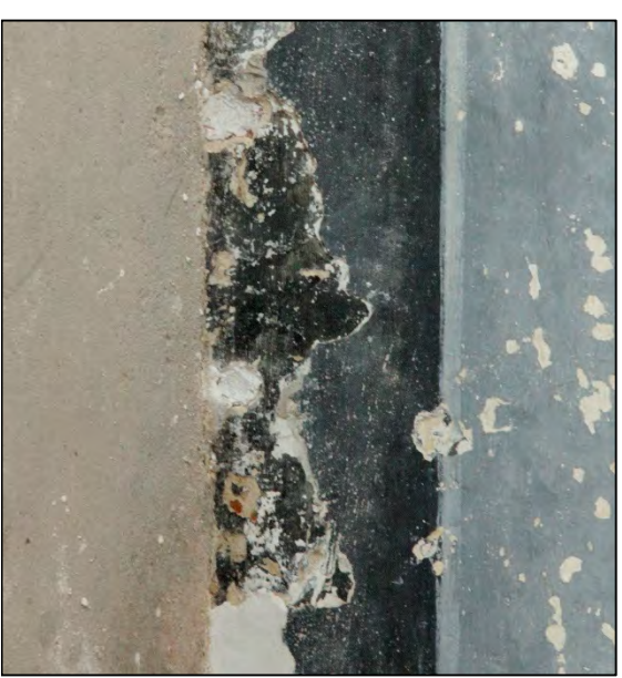
FIGUR 132: ONDER DE ZWARTE PLINT VAN DE PANEELMONTATIE ZIJN NOG RESTANTEN VAN OUDERE PLINTEN AANWEZIG.
