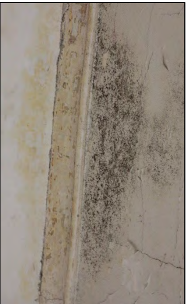
FIGUUR 107: ZWARTE SCHIMMEL, PLAFOND RUIMTE 0.1
