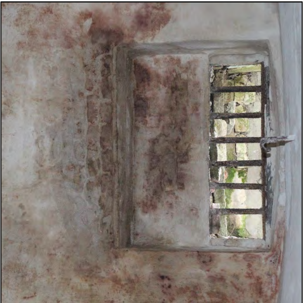
FIGUR 111: SCHIMMEL IN KELDER OP WAND ONDER DE RUIMTE.
