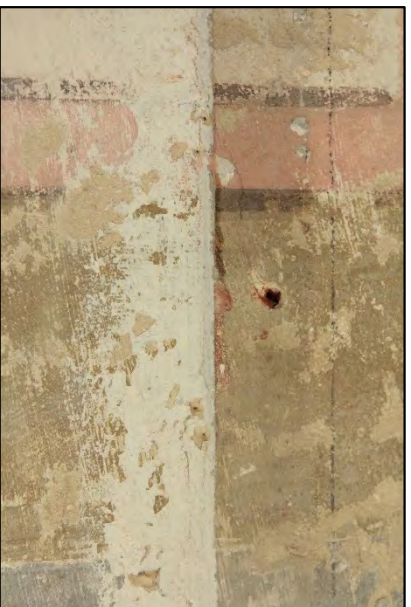
FIGUUR 116: DE RESTANTEN VAN UITGESMEERDE ACRYLAATVERF ONDER DE (INMIDDELS) VERWIJDERDE HOUTEN KAMERLIJST.
