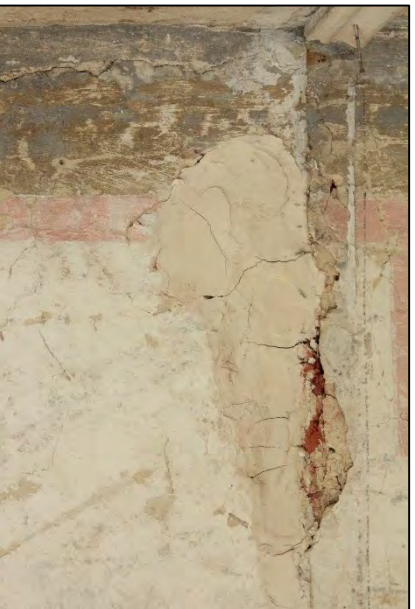
FIGUUR 118: DEZE VOLLEDIG GEBARSTEN, SLODDIGE INVULLING IN OOSTELIJKE HOEK BLEEK ZEER RECENT TE ZIJN AANGEBRACHT DOOR DE AANNEMER DIE HET VERANKEREN VAN DE BINNENWANDEN IN BUITENWANDEN UIT HAD GEVOERD.
