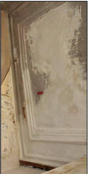
FIGUUR 79: SLODDIGE HERSTELLINGSWERKEN AAN HET PLAFOND, UITGEVOERD DOOR AANNEMER LOT 1.
