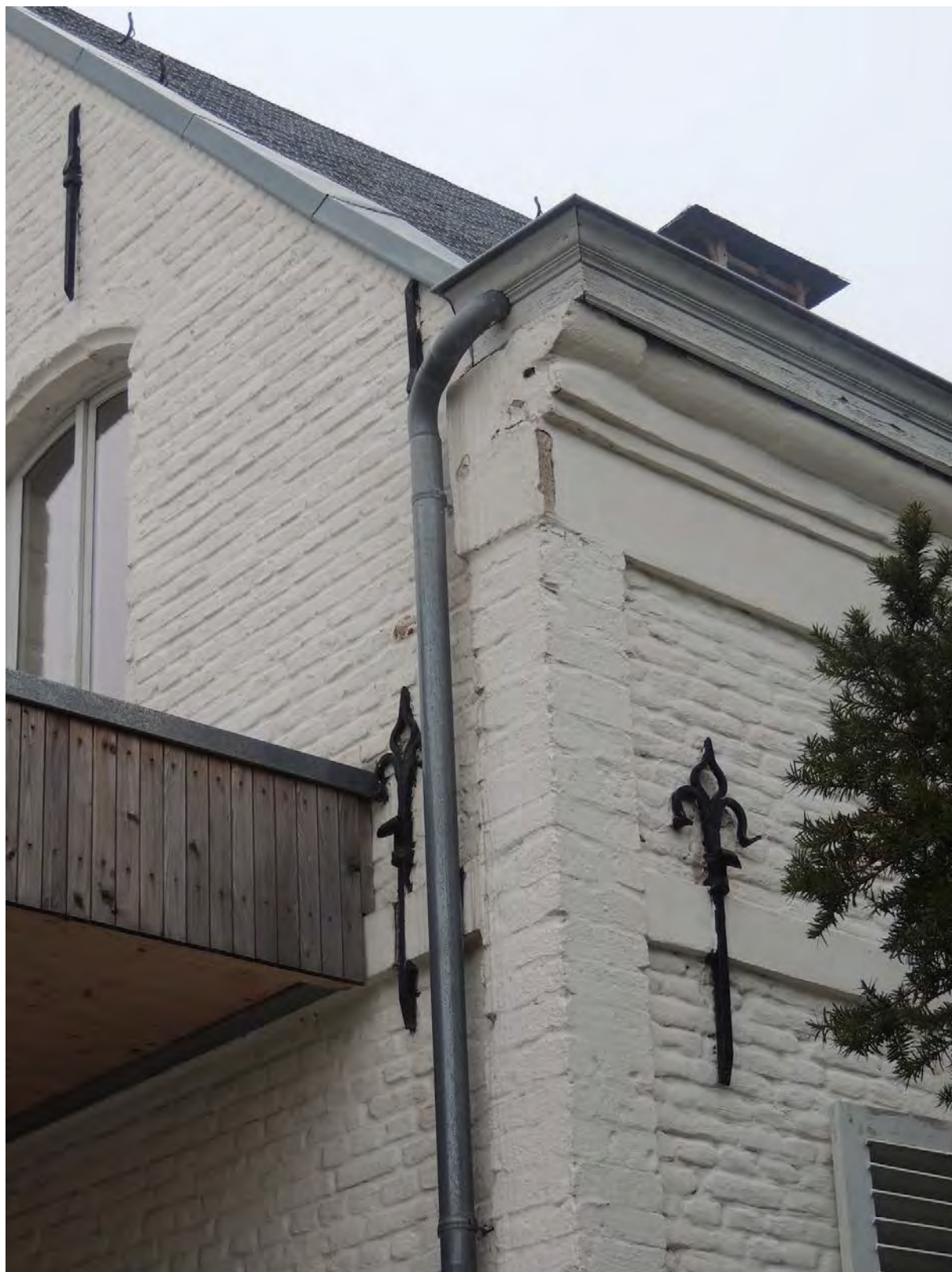
Figuur 41: Lichte beschadiging van de verflaag in de ZO-gevel (GG).
