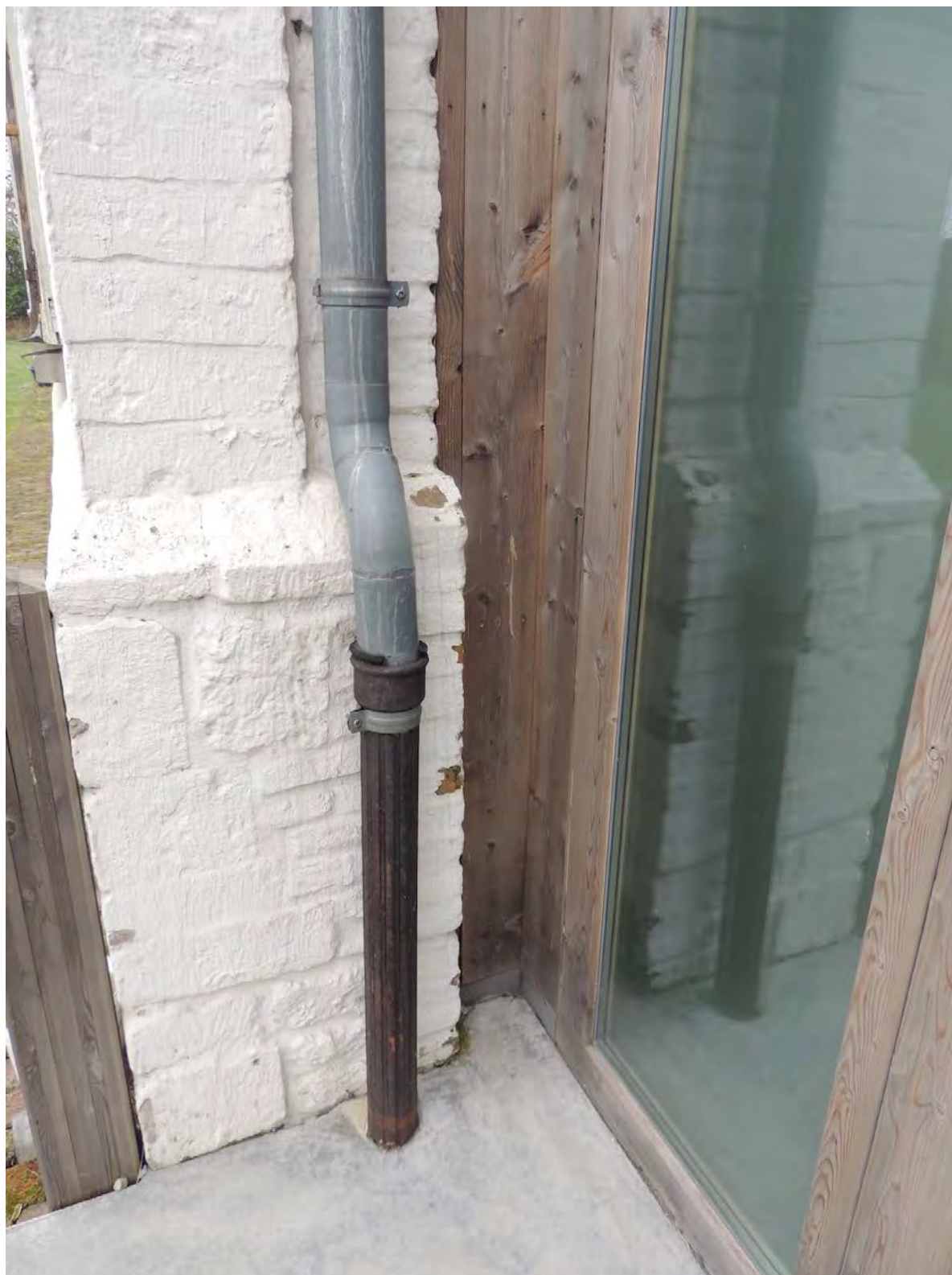
Figuur 40: Lichte beschadiging van de verlaag thv de aansluiting pastorie en nieuwbouw ZW-gevel. Het gietijzeren eindstuk vertoont roest (GG).
