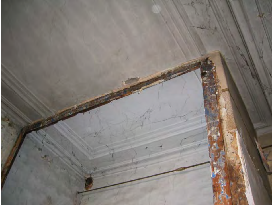
Afbeelding 46f: bij het plaatsen van de ingebouwde kast werd het plafond beschadigd. 96 Het metalen anker werd voorlopig geplaatst om het gebouw in stand te houden.
