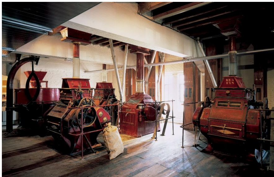
De cilinderwalsen op de eerste verdieping in de maalderij.
