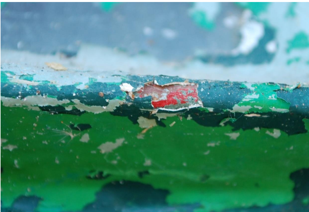
59 – Verfresten op metalen raamkader (noordgevel). Een viertal groentinten zijn te onderscheiden. De oudste laag aanwezig op de (rode) loodmenielag toont een olijfgroene kleur. Foto KU Leuven, Technische Diensten.
