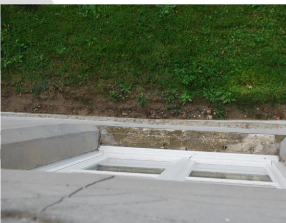
Achtergevel | Voormalig kruisvenster | Onderdorpel en gaten diefjzers.
