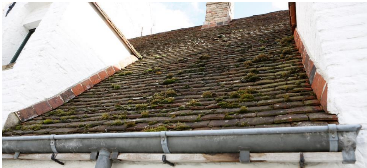
Figuur 24 Schadebeeld van het dakvlak aan de Boeveriestraat (11.02.2020)
