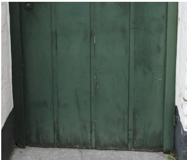
Figuur 30 Schadebeeld tuinpoort (11.02.2020)
