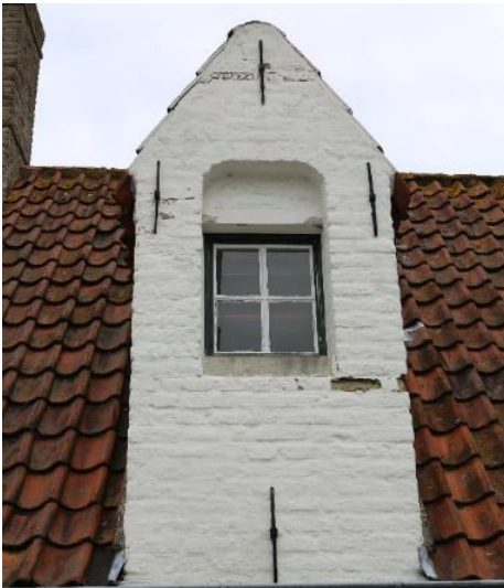
Figuur 17 Schadebeeld dakkapel Gloribusstraat (11.02.2020)
