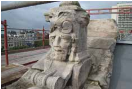
Ornament door de brand beschadigd.
