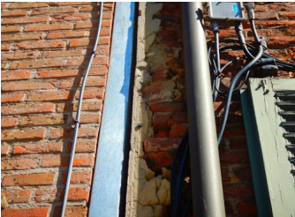
baksteen-slordige aansluiting naastgelegen woning
