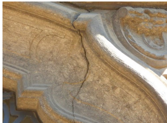
blauwe hardsteen-barstvorming deurlijst
