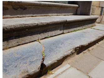
blauwe hardsteen-slijtage schade trap
