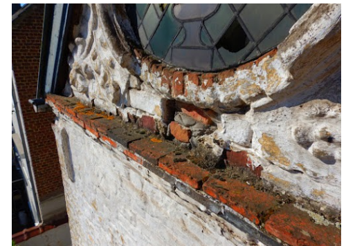
pleisterwerk-schade aan zolderraam uitsprong
