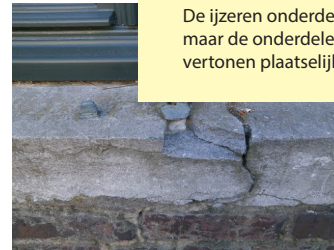
blauwe hardsteen-schade door expansie ijzer
