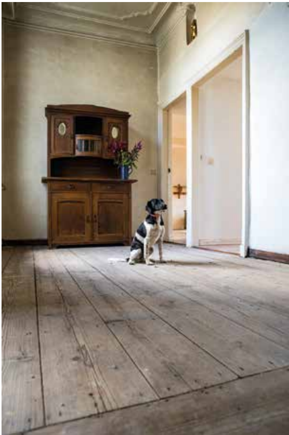
Overloop en salon 1ste verdieping : Brede oude eiken planken, wellicht 18de eeuw, circa 25 cm breed, onbehandeld. Hier en daar beschadigd door nagelen en verlijmen van vasttapijt ( reeds verwijderd ).
