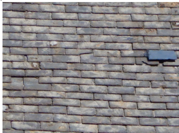
weggefallen lei en onvakkundige herstelling
