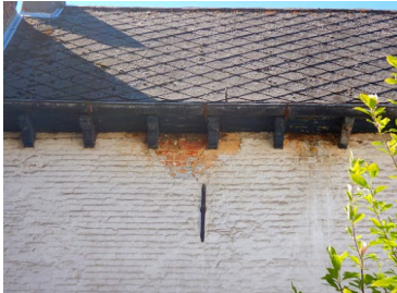
hoofdgebouw-schade door vocht
