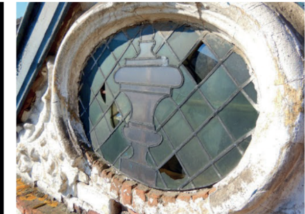
raam-beschadigde en ontbrekende ruitjes
