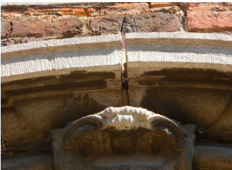
blauwe hardsteen-voegwerk deurlijst weggevallen
