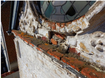
pleisterwerk-schade aan zolderraam uitsprong
