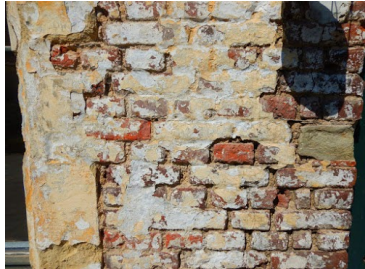
achterbouw-schade door vocht
