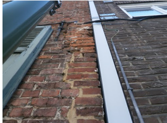
baksteen-slordige aansluiting naastgelegen woning
